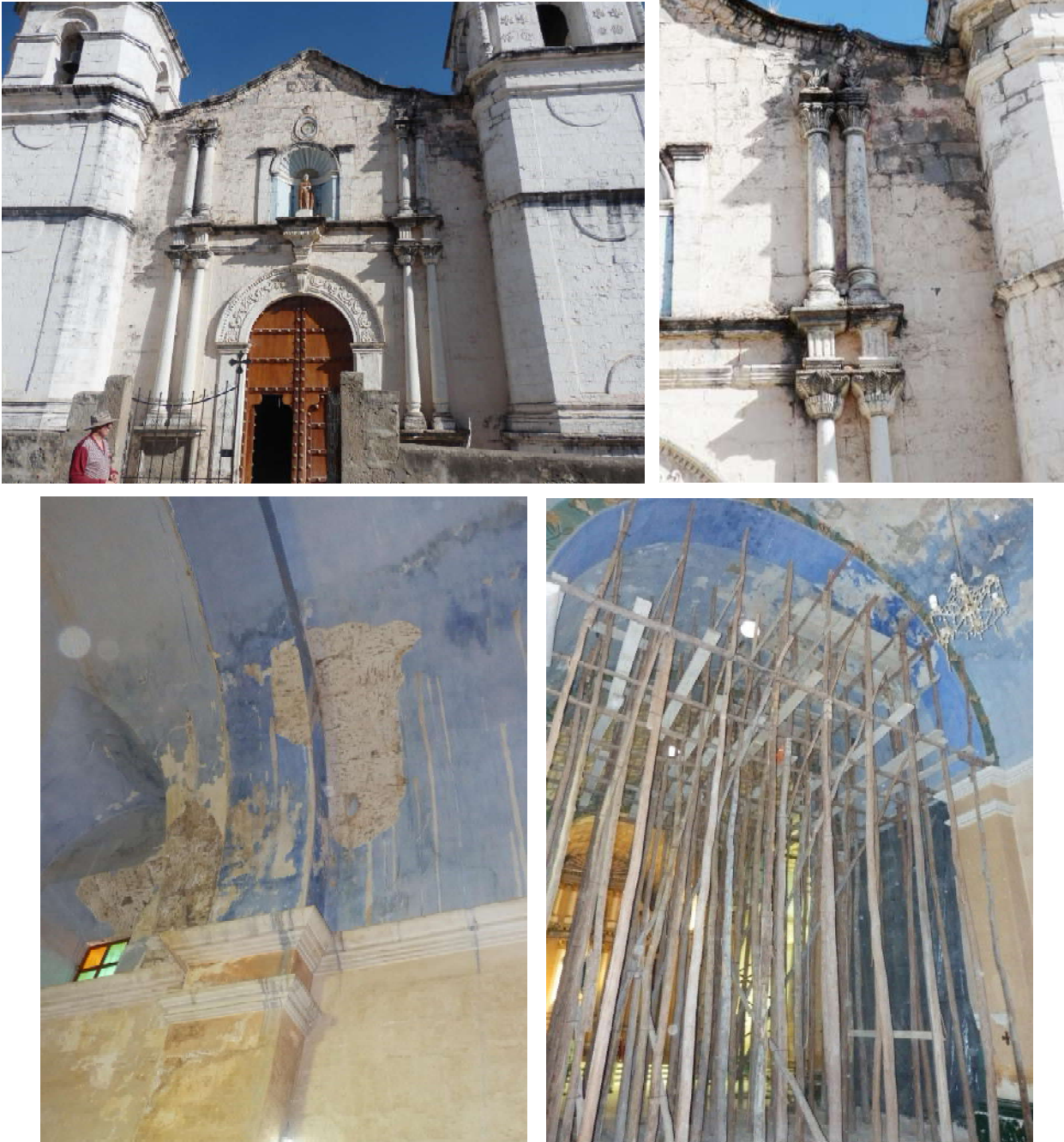
Fotografía 10.12 Exteriores e interiores del templo San Pedro de Alcántara de Cabanaconde. Se aprecia el deterioro por la humedad en las paredes exteriores, así como los daños en el techo interior y su apuntalamiento, trabajos iniciados en el 2015.
