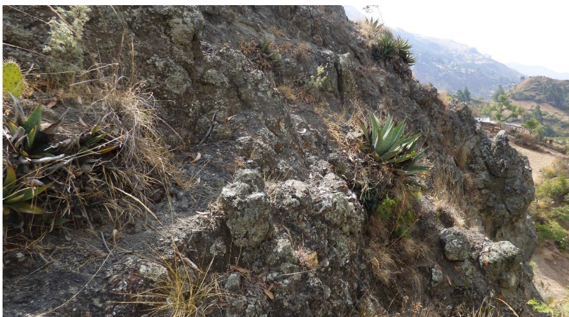
Fotografía 1. Detalle de las rocas volcánicas las cuales se encuentran muy fracturado con espaciamentos próximos a medianamente separadas entre sí (0.05-0.30 m), algo abiertas (0.5-1.0 mm), y de resistencia media (50-100 Mpa). Superficialmente se encuentran alteradas y moderadamente meteorizadas.
