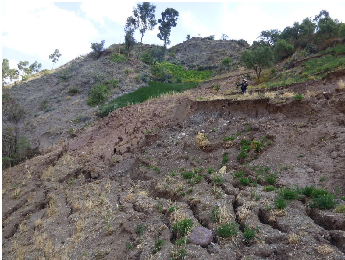
Fotografía 4. Vista de la superficie del terreno bastante agrietada, con longitudes variables de 5 a 20 m y aperturas de hasta 20 cm.
