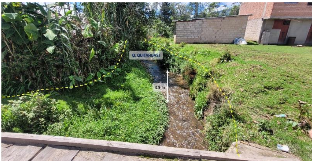
Figura 15. Puente carrozable susceptible a erosión por la quebrada Quitahuasi, probable altura de inundación de 0.9 m. Ubicación: E: 740267, N: 9252703, Z: 2608.
