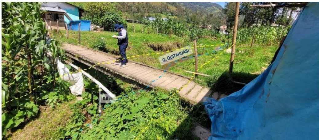
Figura 10. Puente peatonal susceptible a erosión fluvial, probable altura de inundación de 0.8 m. Ubicación: E: 740364, N: 9252515, Z: 2616.
