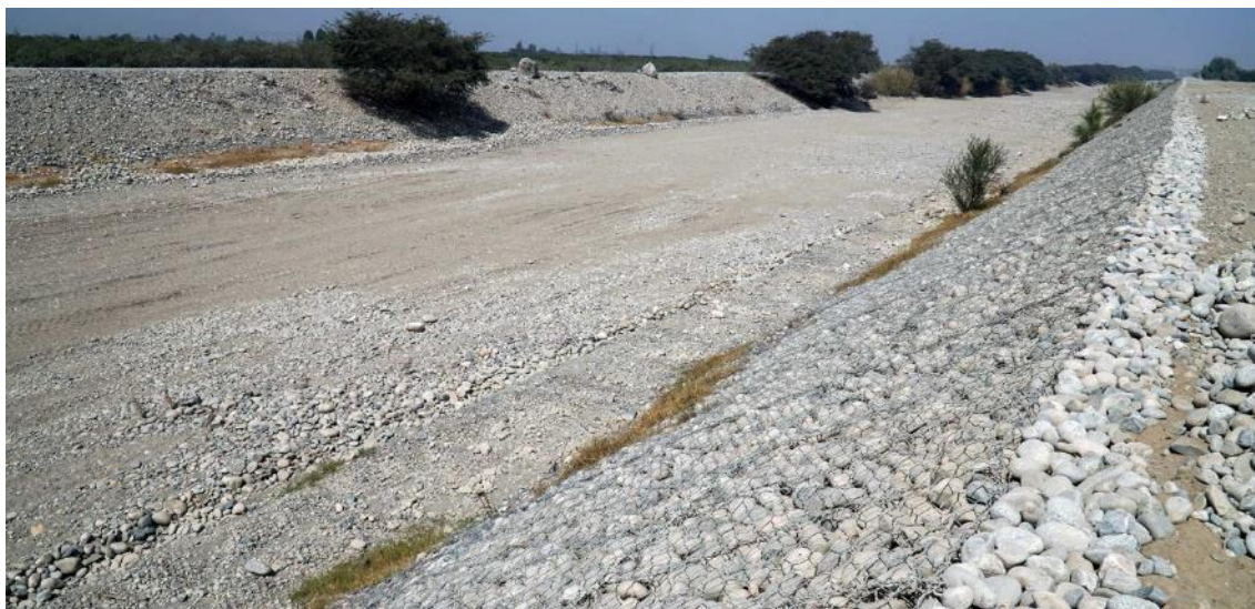
Fotografía 9. Ejemplo de una defensa ribereña con un pedraplén y geomallas.
