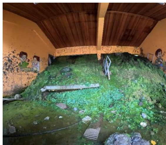
Fotografía 9. Se aprecia el material del deslizamiento que ha ingresado a una de las aulas.
