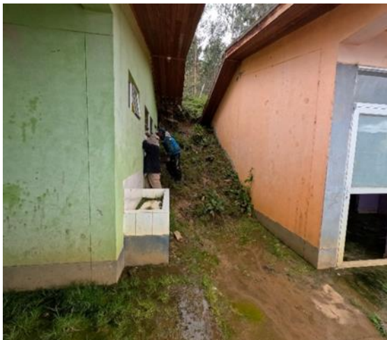
Fotografía 8. Se aprecia el material del deslizamiento que ha ingresado entre pabellón y pabellón.
