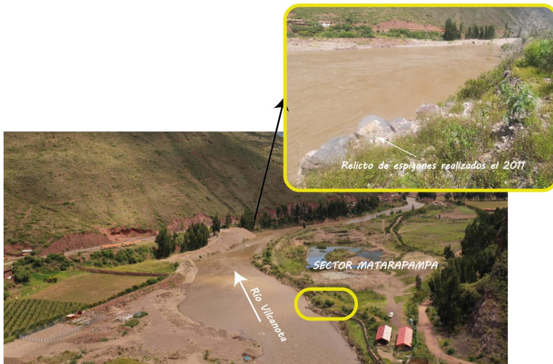
Figura 18. Infraestructura de espigones destruidos en el 2017
