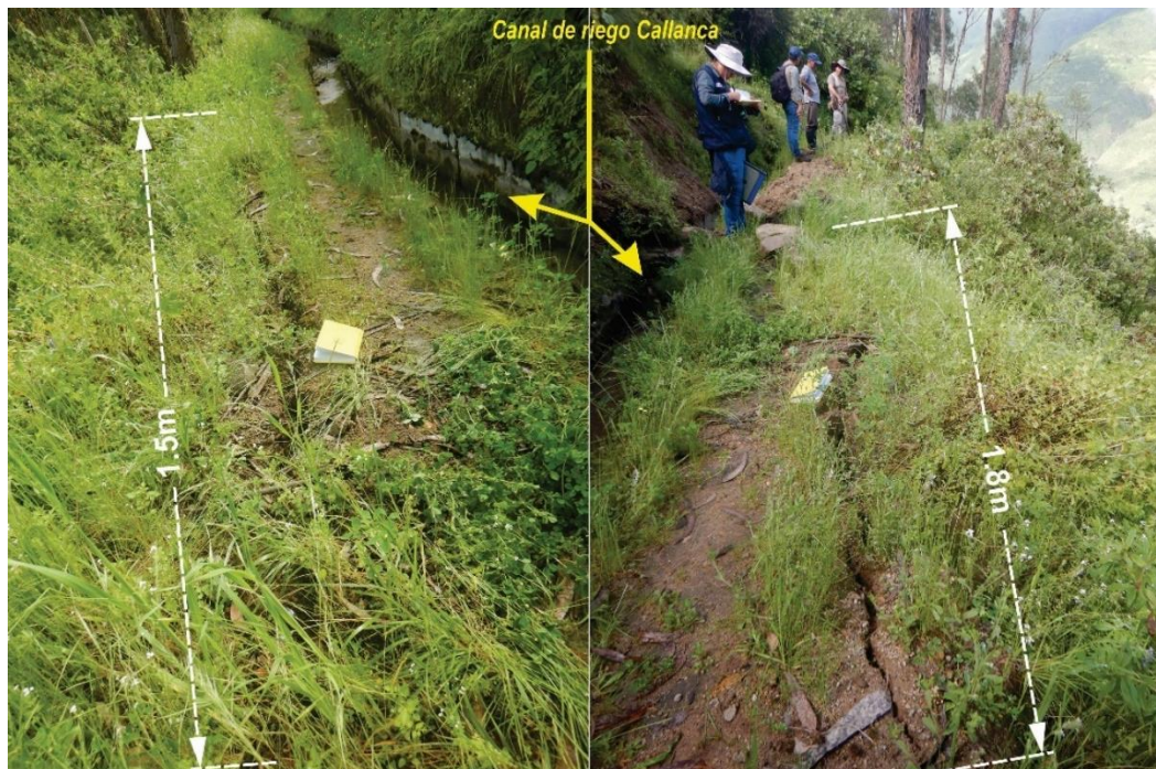
Figura 24. Vista de agrietamientos, próximos al canal Callanca, ubicado entre las coordenadas UTM 8742708 N, 304277 E.
