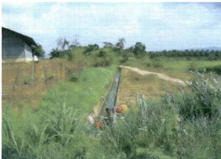
Fig. 27: Canal Shilcayo, afectado por derrumbes en su tramo su cubierto.
