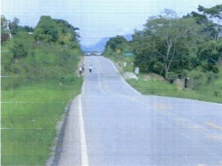
Fig. 41: Tramo de carretera con asentamientos en la plataforma de carretera.
