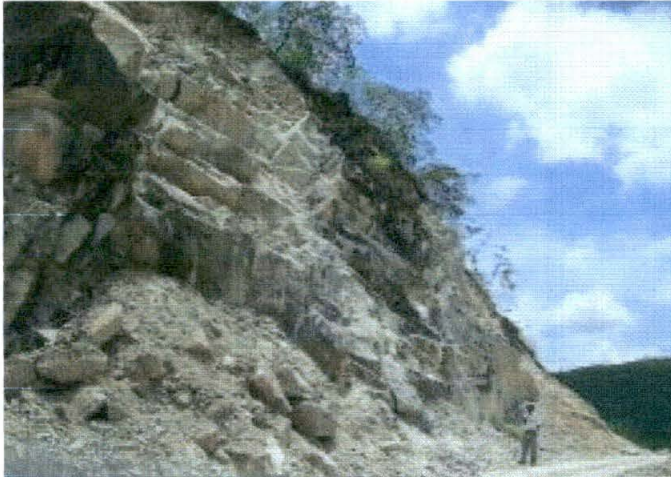
Fig. 25: Zona de derrumbe en el Km 7+900 de la carretera de acceso al distrito de Sauce.
