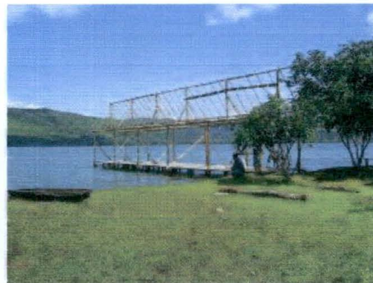
Fig. 17: Muelle de la laguna Sauce el cual fue roto en tres bloques durante el sismo del 25 de Setiembre del 2005.
