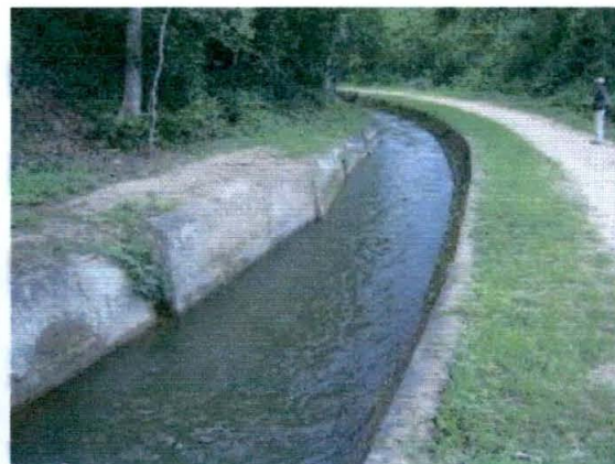
Fig. 31: Otro tramo del canal Cumbaza con agrietamientos y empuje lateral en el revestimiento de concreto.
