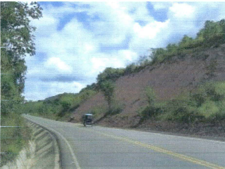
Fig. 42: Talud superior de carretera afectado por erosión en surco.
