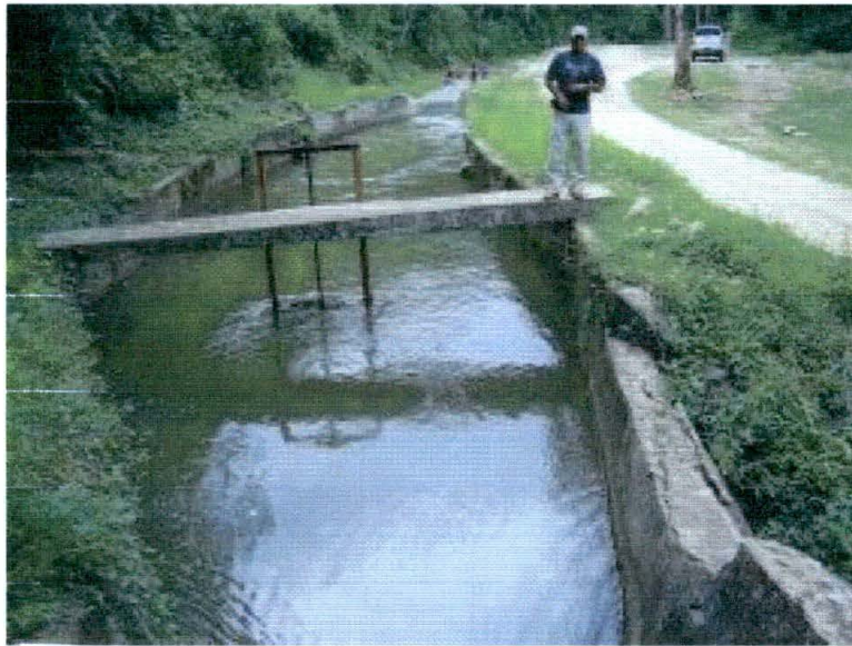
Fig. 32: Desarenador del canal Cumbaza con agrietamientos en su estructura de concreto.
