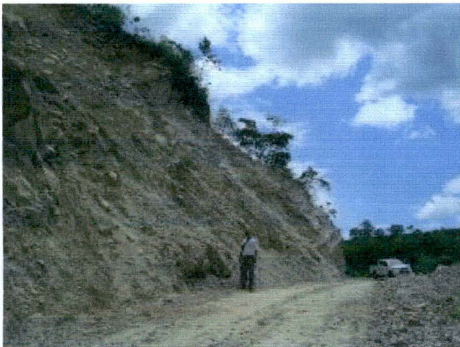
Fig. 26: Zona de derrumbe en el Km 8+400 de la carretera de acceso al distrito de Sauce.
