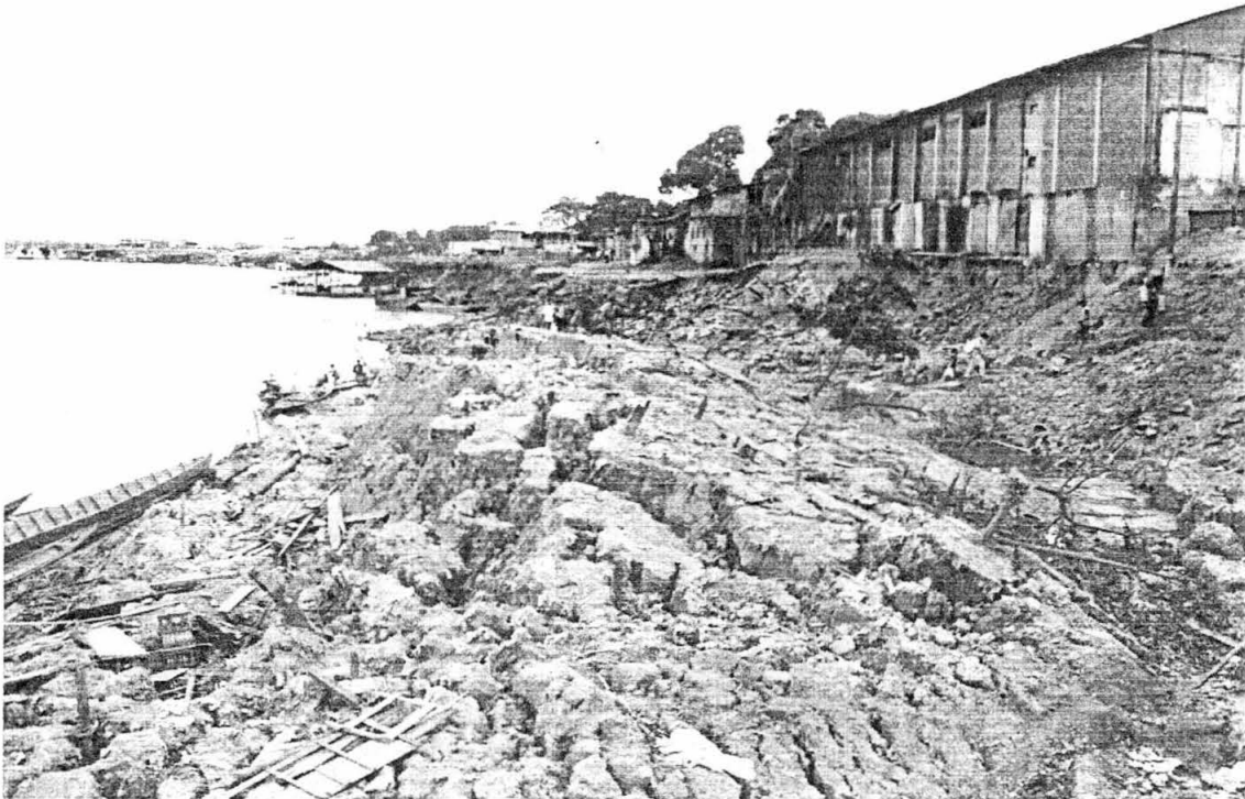
Foto N 4: Dos vistas de áreas disturbadas por procesos de deslizamientos que afectan depósitos de relleno antrópico. Se distingue agrietamientos y basculamiento del terreno deslizado en los sectores de Malecón Grau y el Barrio Iquitos (vista inferior).
