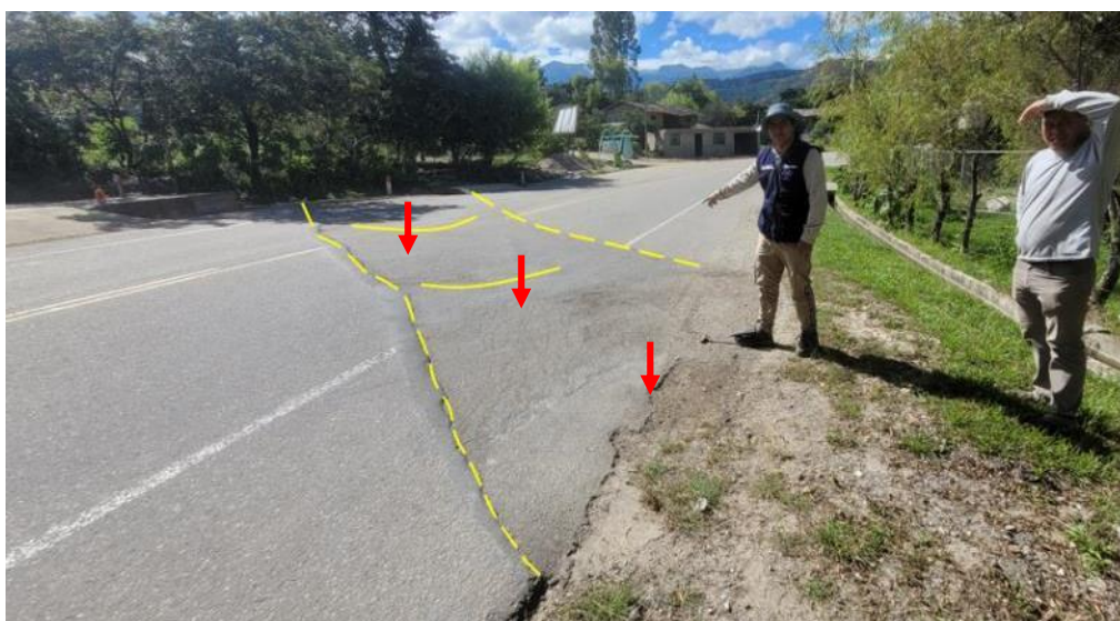
Figura 14. Asentamiento (línea discontinua amarilla), en la carretera Cajamarca – Cajabamba. Coordenadas: E: 819935, N: 9158680.
