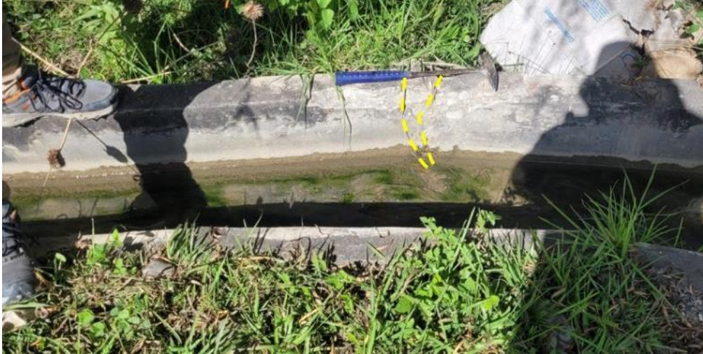
Figura 15. Fractura en canal revestido, originada por asentamiento de la carretera. Coordenadas: E: 819466, N: 9158579.
