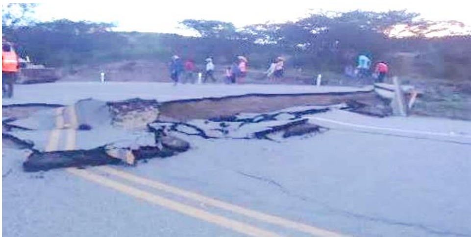
Fotografía 4. Carretera Cajamarca – Cajabamba, agrietada en el km 1161+740. Fuente: Núñez, S. 2019.
