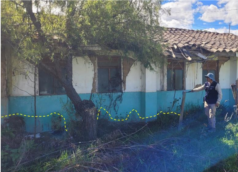
Figura 19. Infraestructura de un antiguo puesto de salud abandonada por agrietamientos debidos a la humedad (líneas discontinuas amarillas). Coordenadas: E: 819972, N: 9158620.
