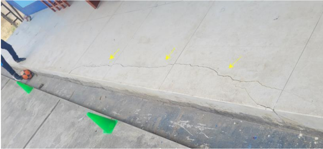
Figura 28. Piso en el patio principal presenta agrietamientos por efectos constructivos. Coordenadas: E: 818993, N: 9158445.
