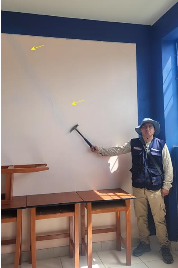
Figura 31. Paredes de aulas agrietadas por cimentación irregular del terreno.
