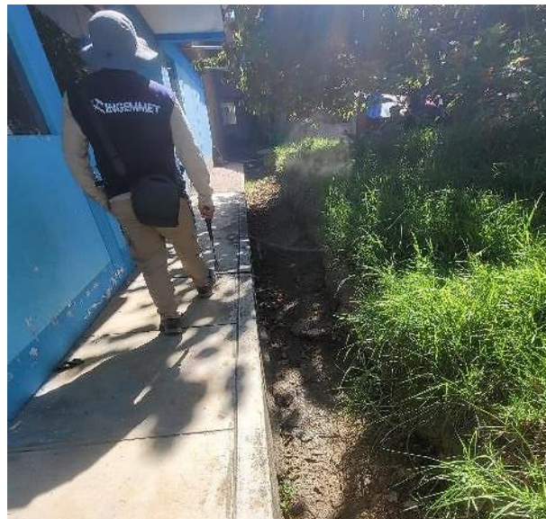
Fotografía 8. Cuneta de drenaje de institución educativa sin revestimiento Coordenadas: E: 819781, N: 9158662.
