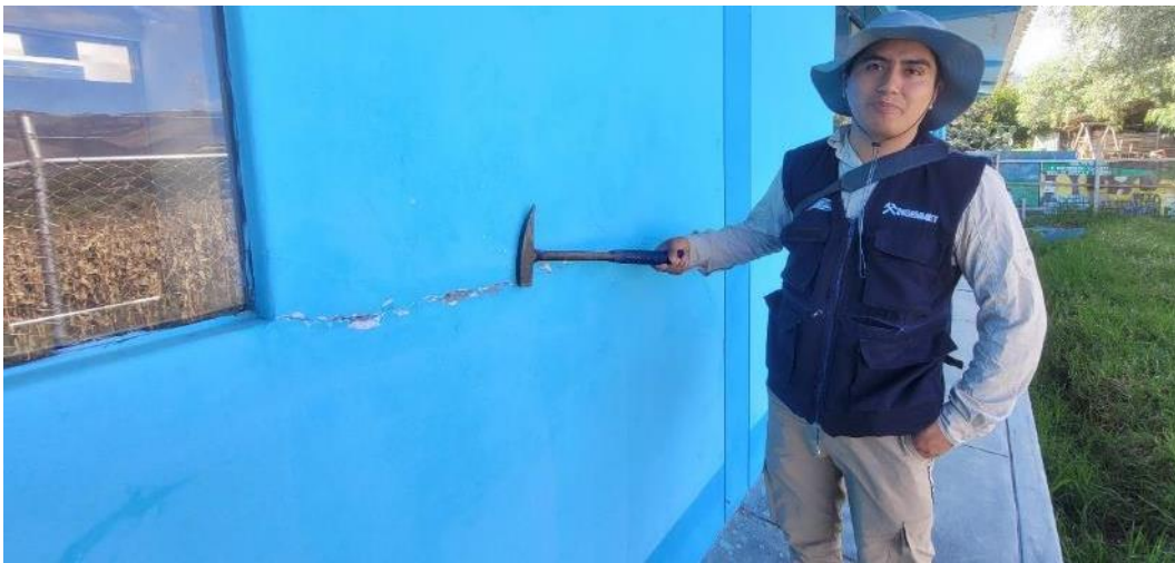
Fotografía 7. Agrietamiento en pared de local antiguo. Coordenadas: E: 819770, N: 9158669.
