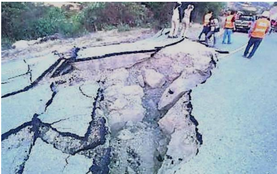
Fotografía 3. Carretera Cajamarca – Cajabamba, agrietada en el km 1161+370. Fuente: Núñez, S. 2019.
