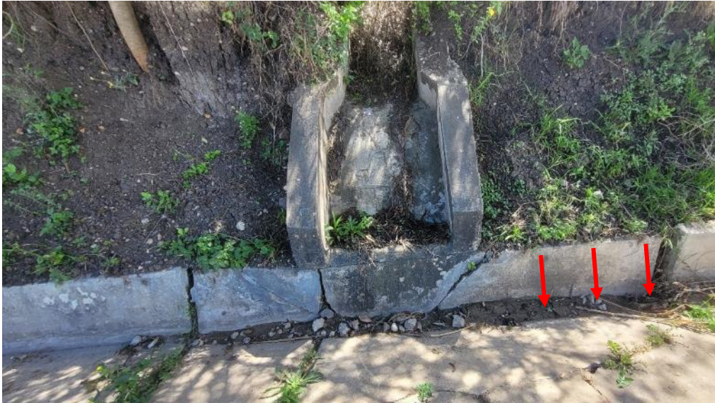
Fotografía 5. Fracturas en canal revestido, originada por asentamiento de la carretera (hacia la derecha) Coordenadas: E: 820136, N: 9158539.
