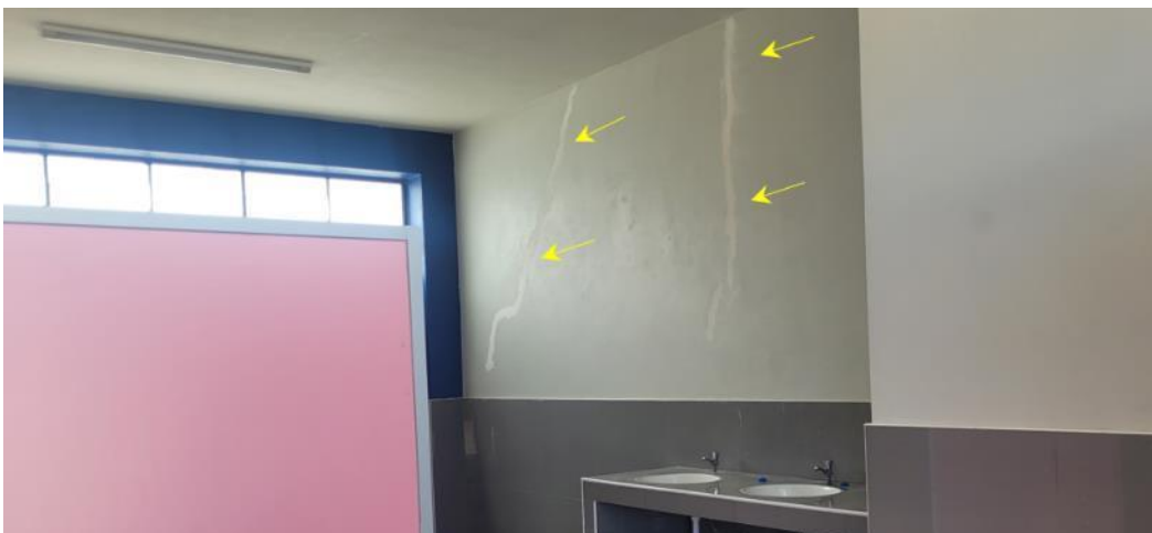
Figura 30. Paredes de servicios higiénicos con agrietamientos producto de cimentación irregular del terreno.
