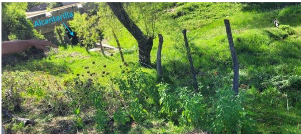
Figura 21. La pendiente suave, permite que el agua proveniente de la alcantarilla y la falta de un sistema de drenaje adecuado se acumule y sature el terreno.
