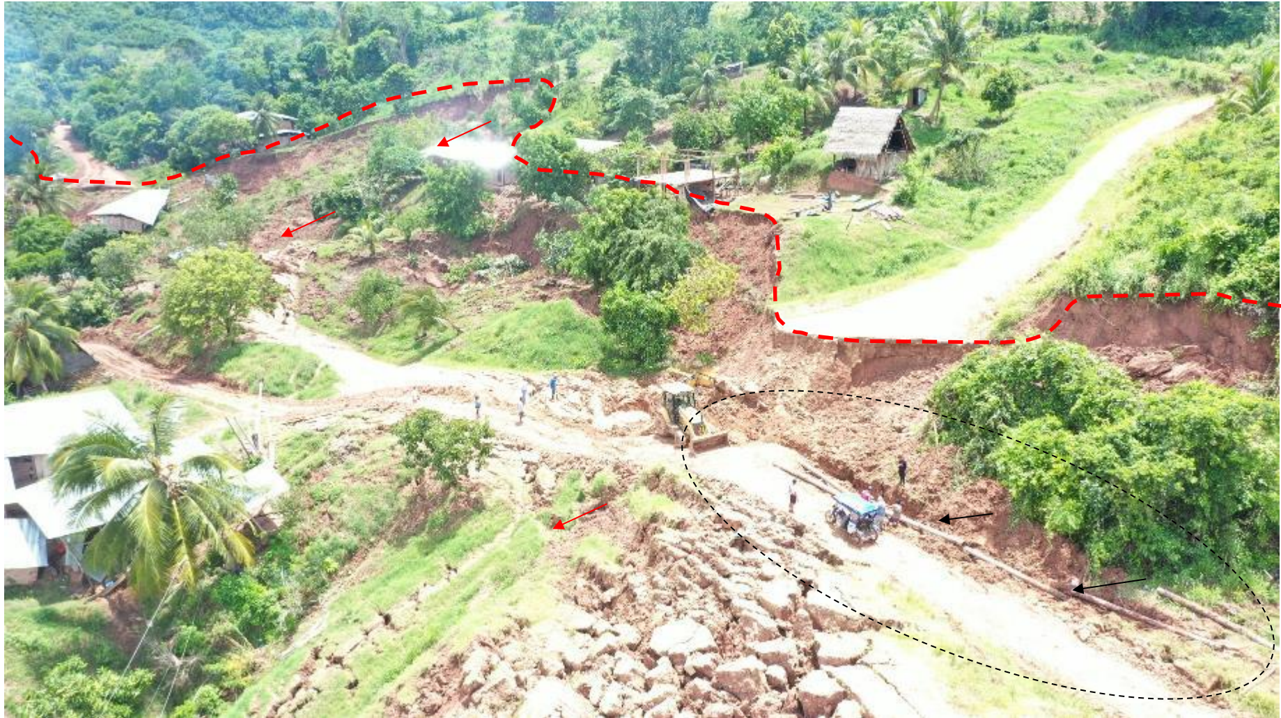
Figura 16. Tubería de agua potable del valle del Ponacillo, afectada por el deslizamiento rotacional.
