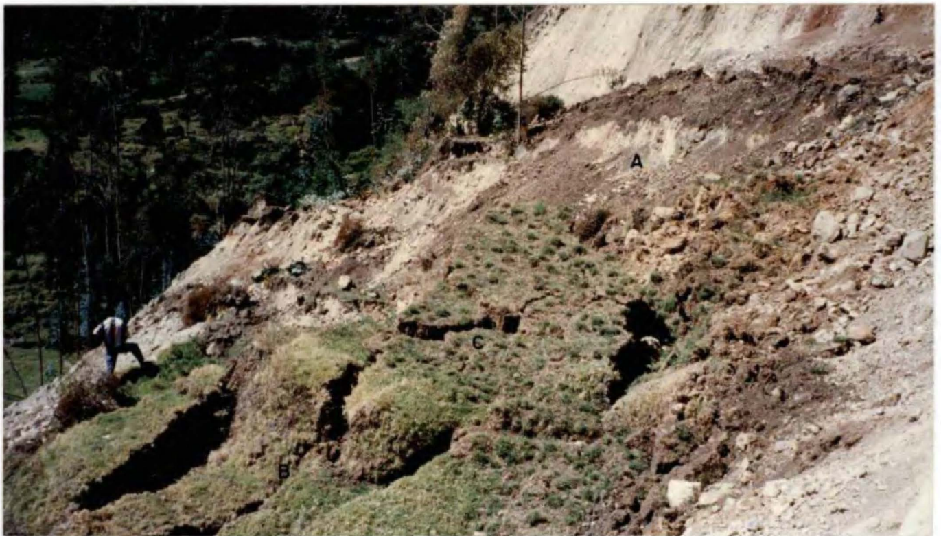
FOTO N° 5.- Parte media del deslizamiento, donde se observan escarpas menores ( A ), grietas tensionales longitudinales ( B ) y transversales ( C ).
