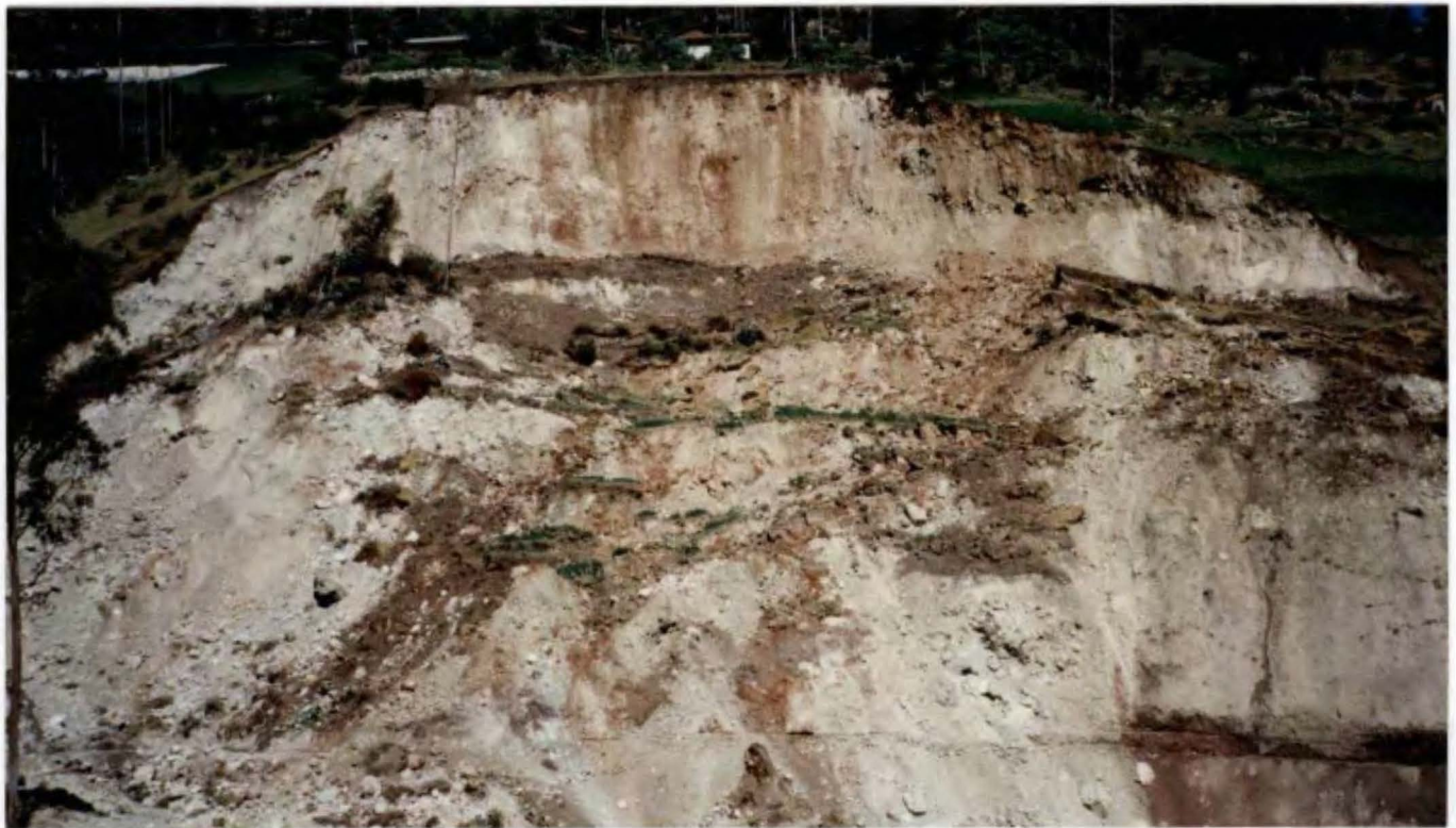
FOTO N° 2.- Zona de arranque o corona, escarpa superior y parte del cuerpo del deslizamiento.
