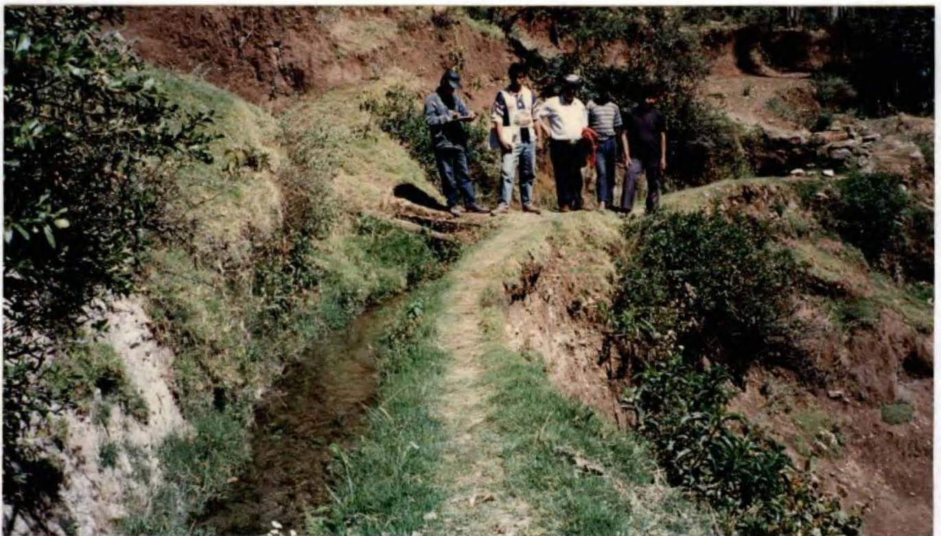
FOTO N° 7 Canal de riego sin revestimiento ni mantenimiento por donde se filtran las aguas.
