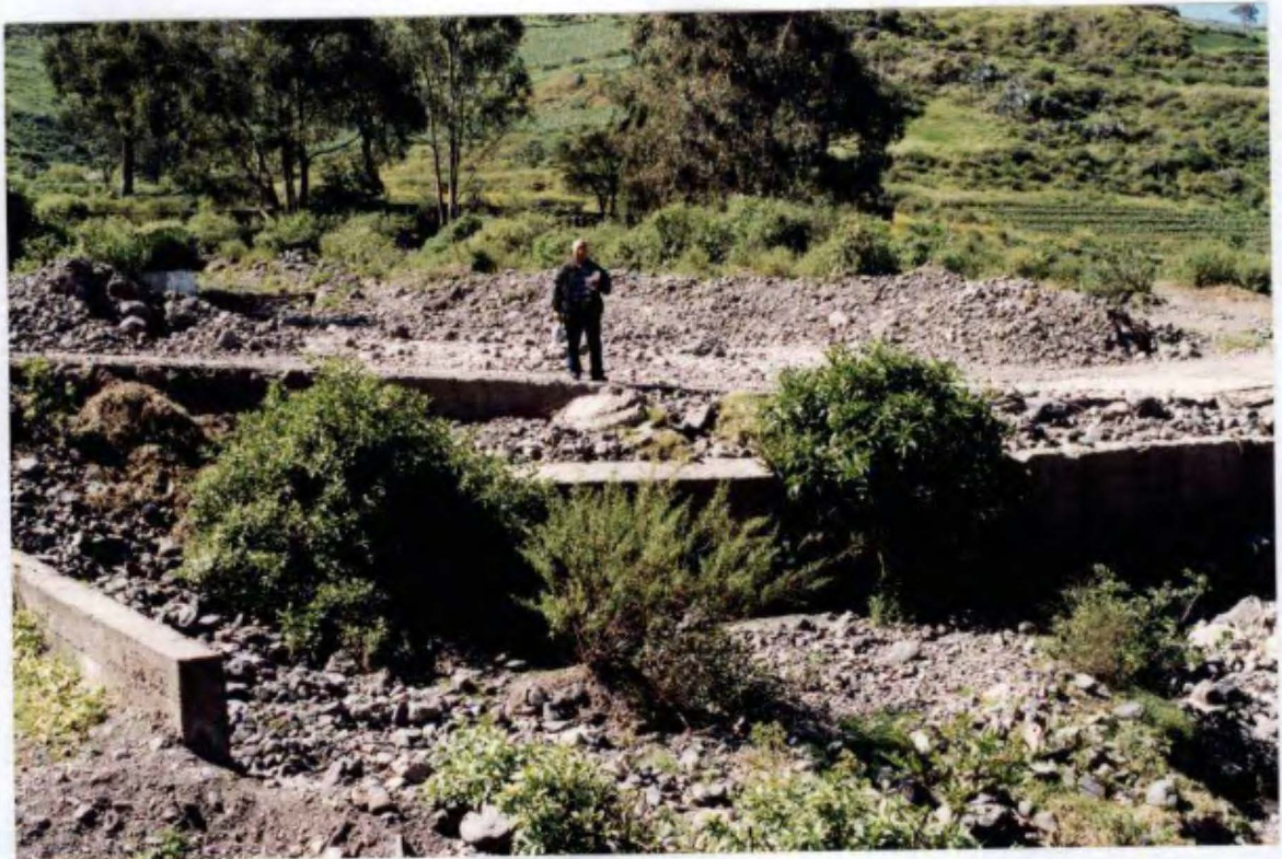
FOTO N° 4.- Vista del baden construido en la carretera Canta – Obrajillo, en buenas condiciones.
