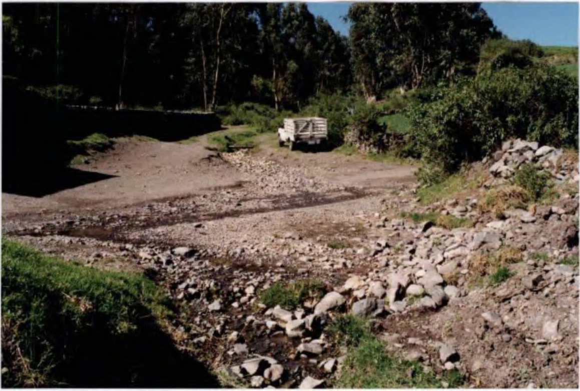
FOTO N° 5.- Vista aguas arriba de la Quebrada Tranca, por donde discurren huaycos que afecta la carretera y viviendas. Construir un baden.
