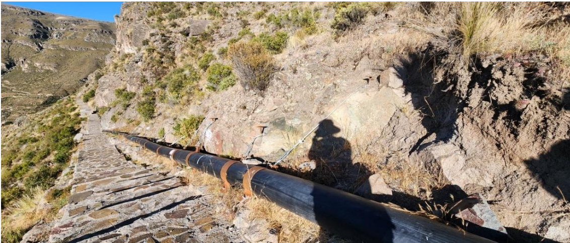
Figura 46. Ejemplo de un sistema de riego entubado.
