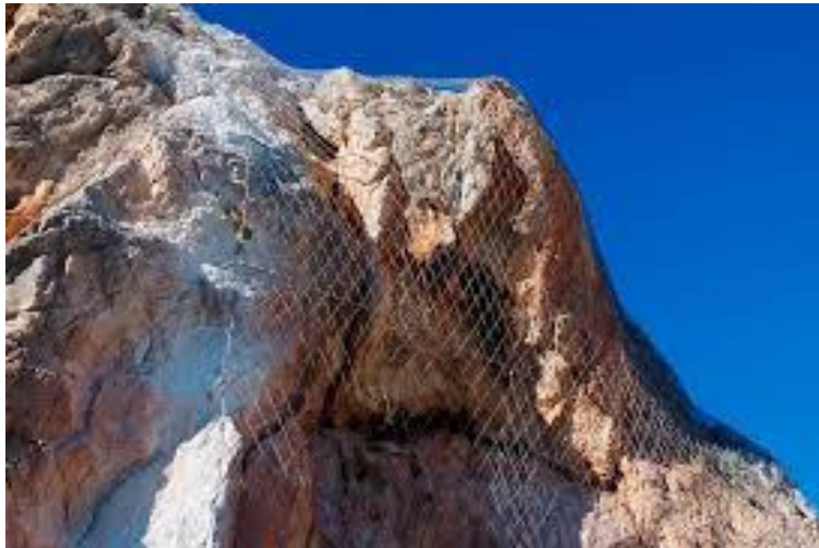
Figura 48. Ejemplo de mallas ancladas para caídas de rocas.
