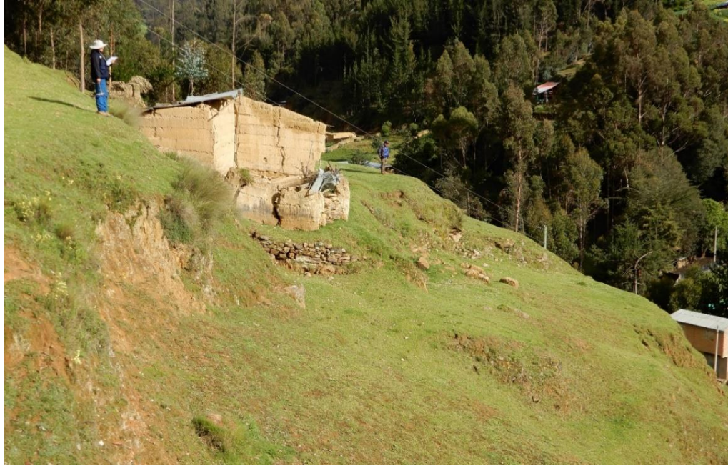
Fotografía 7. Vista de escarpas escalonadas de deslizamientos antiguos en el Sector 1 con desplazamiento vertical hasta de 1m. Coordenadas UTM: 295761.00 / 8940564.00, Zona 18.
