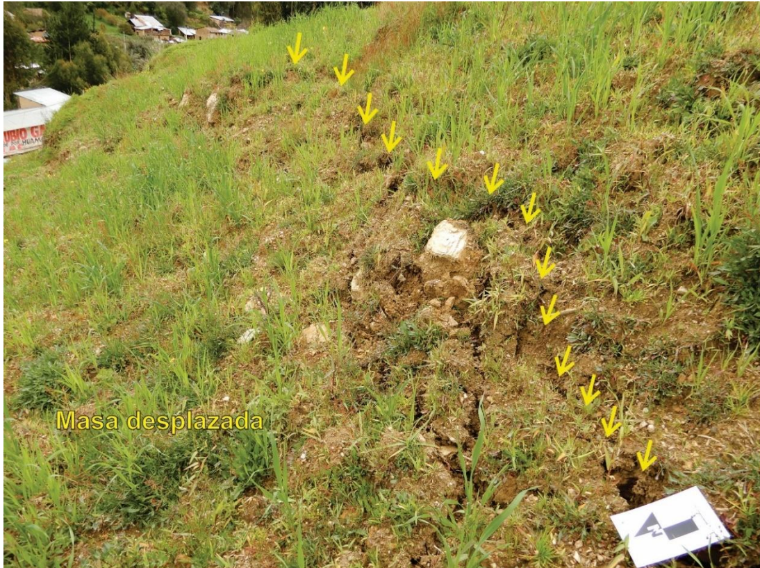
Figura 10. Muestras de grietas en la masa del deslizamiento en el Sector 2
