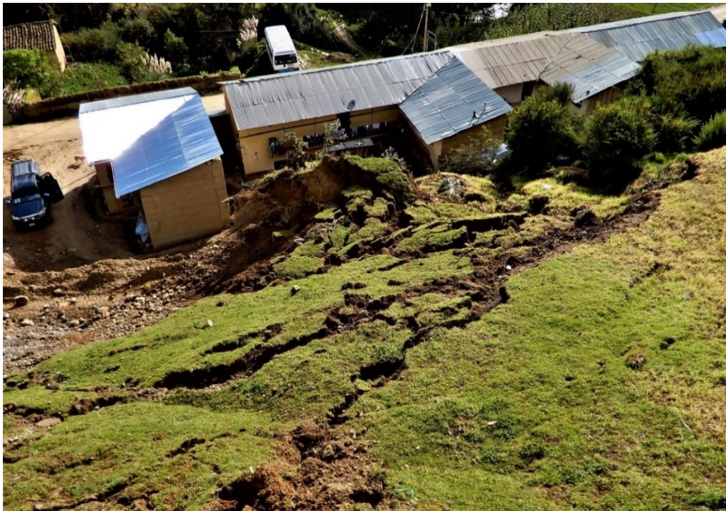
Fotografía 8. Vista de 3 viviendas ubicadas en el pie del deslizamiento del Sector 1 que podría verse afectado. Coordenadas UTM: 295748.00 / 8940592.00, Zona 18.
