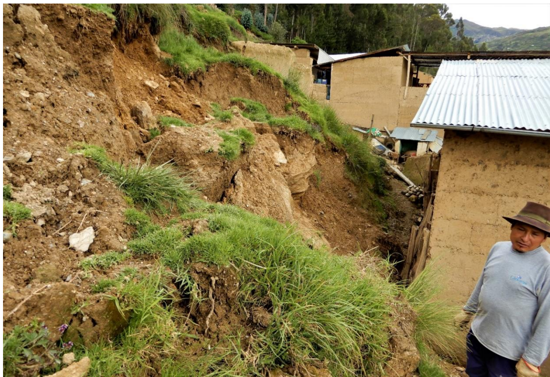
Fotografía 9. Masa del deslizamiento en el talud superior de las viviendas. Coordenadas UTM: 295627.00 / 8940626.00, Zona 18.
