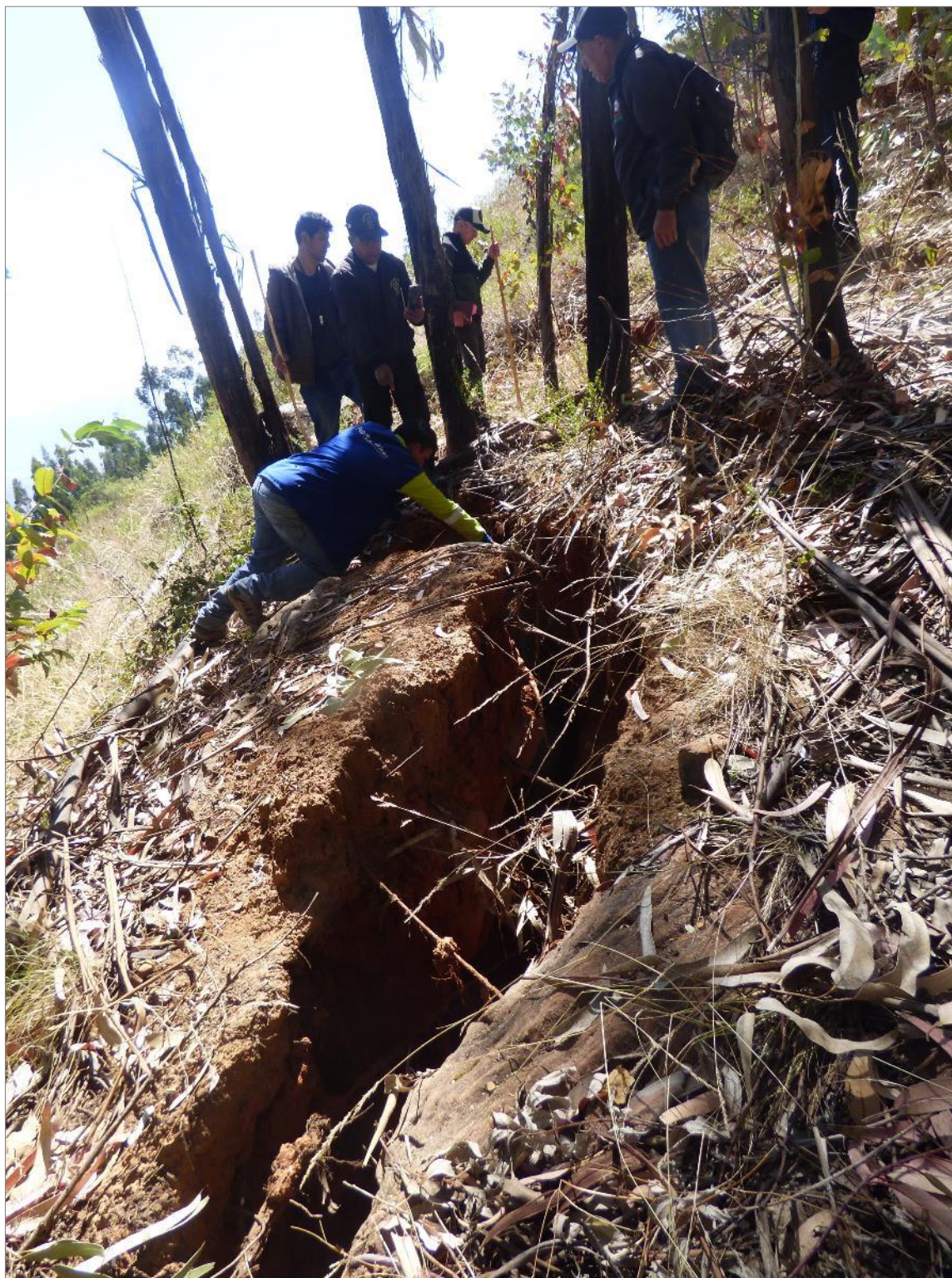
Fotografía 2. Vista de la corona del deslizamiento reactivado, con plano de falla rotacional y una profundidad de aproximadamente 10 m. Longitud calculada a partir de la longitud de un tronco de árbol.
