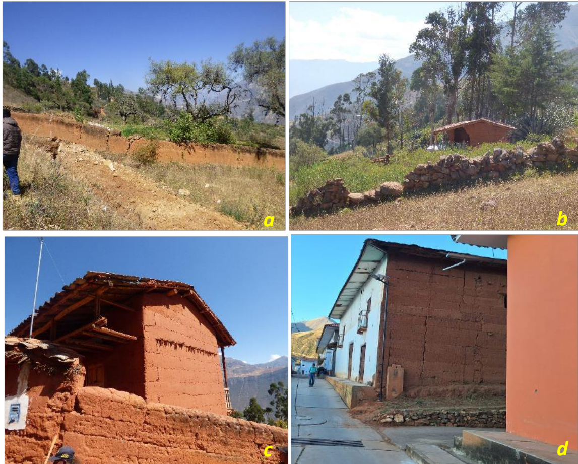
Figura 11. Vista de viviendas afectadas, evidenciado por las paredes agrietadas y muros que circundan los terrenos de cultivo.
