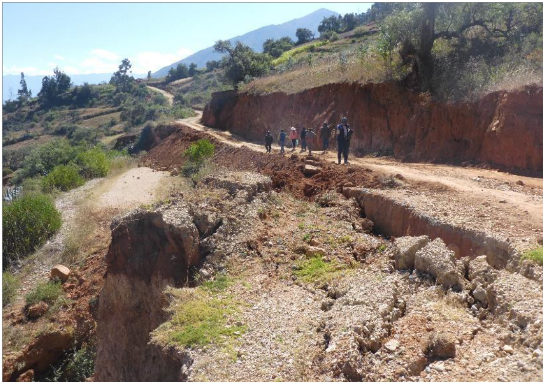
Fotografía 3. Escarpa del deslizamiento reactivado, que afectó tramo carretero que conduce a pueblos aledaños.
