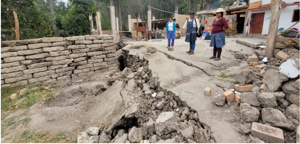
Figura 14. Exterior de vivienda afectada por el escarpe principal, en la parte alta del deslizamiento. Coordenadas: E: 781762, N: 9212141.
