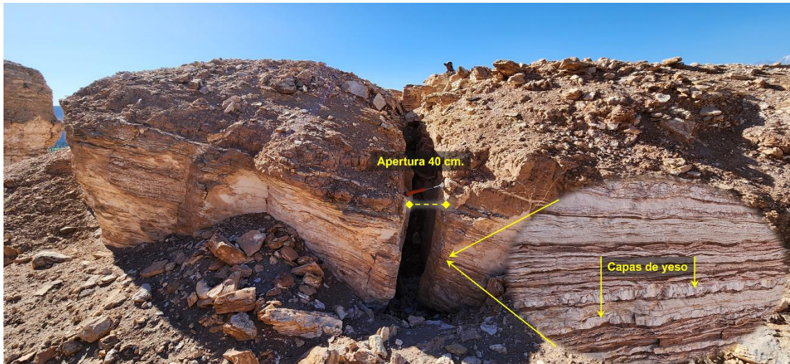
Figura 18. La zona de arranque de los derrumbes se observa en la cumbre de colinas de la Villa San Luis.
