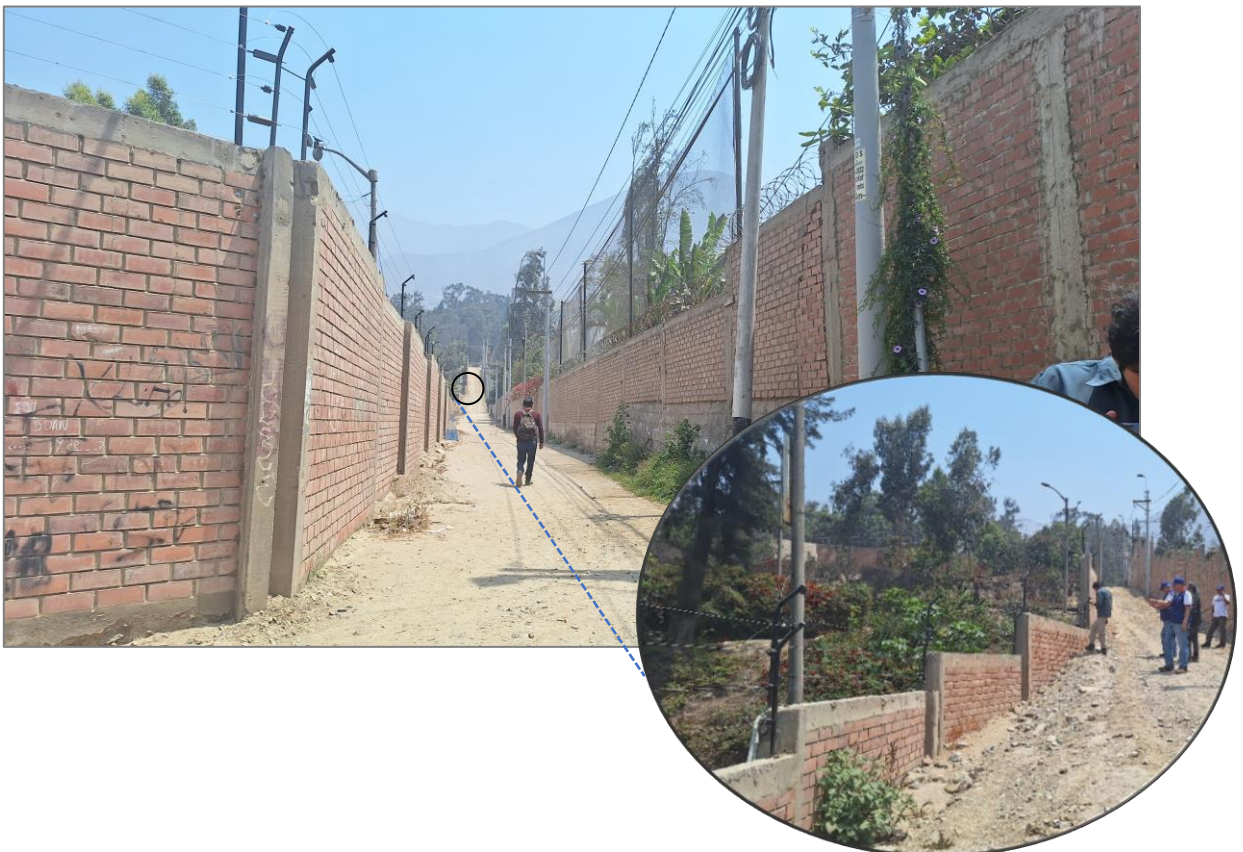
Figura 14. Vista del Pasaje S/N, por el cual discurrió un flujo a partir de las lluvias registradas en la zona de estudio, así mimos, se observa que el muro que delimita Yanacoto, tiene aproximada 50 cm de altura, por donde fácilmente puede ingresar flujos posteriores.
