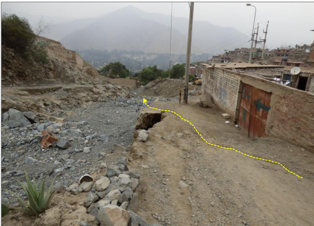
Figura 10. Poste de alumbrado público que podría ser afectado por un próximo flujo. La flecha indica la erosión del flujo de detritos
