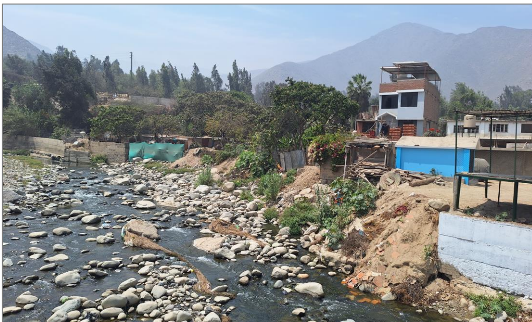
Fotografía 8. Vista de la margen izquierda del río Rímac, afectado por erosión fluvial. Requiere urgente una defensa ribereña en un tramo aproximado de 170 m.
