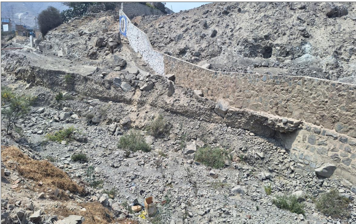
Fotografía 7. Vista de material transportado por flujos antiguos, alcanzo una altura aproximada de 3 m, que posteriormente fue erosionado, dejando expuesto el muro que delimita Yanacoto II.
