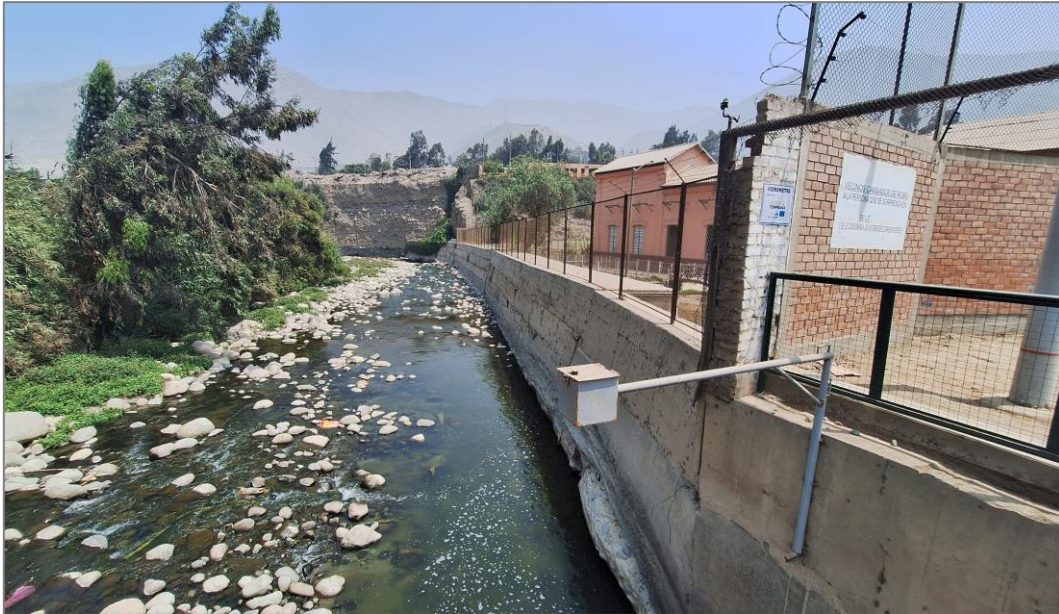
Fotografía 9. Vista de la margen derecha del río Rímac, se observa muro de concreto para proteger el terreno de Yanacoto I. Donde finaliza la defensa ribereña, la dinámica del río Rímac está generando erosión fluvial al pie del depósito, que podría desestabilizar el talud y generar derrumbes.
