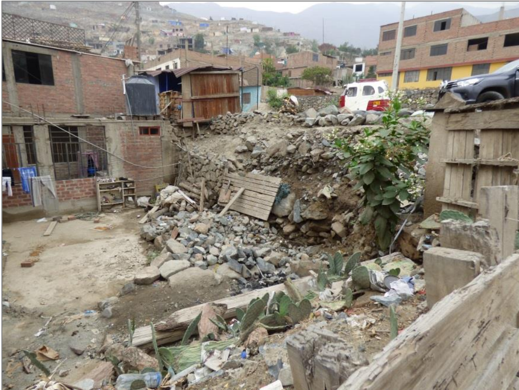
Fotografía 5. Vivienda del sector 1 ra Zona de Yanacoto afectada por el flujo de detritos
