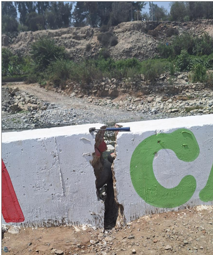
Fotografía 10. Vista del muro de concreto, que protege la margen derecha del río Rímac, en malas condiciones.
