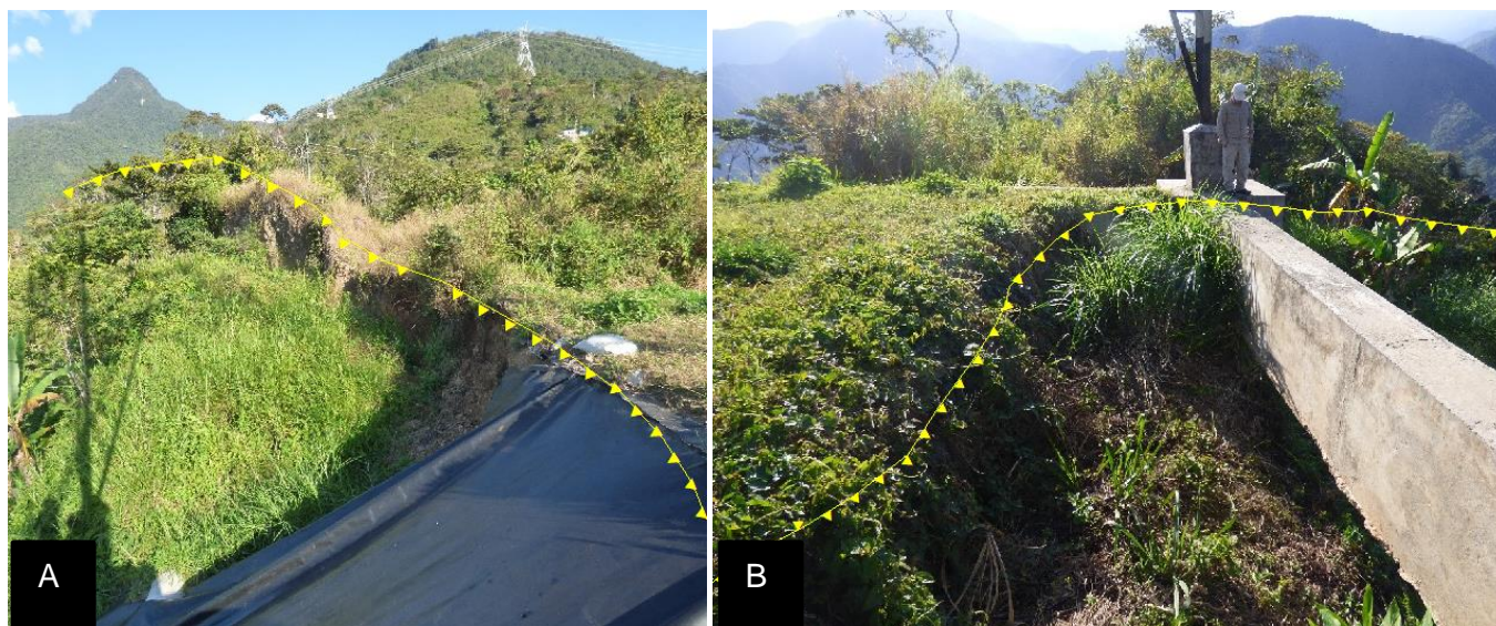
Figura 8. A. Vista hacia el oeste de la torre de alta tensión, se ha señalado la corona del deslizamiento en estado de reactivación (líneas amarillas). B. La corona llega hasta la torre de alta tensión afectando sus cimientos.
