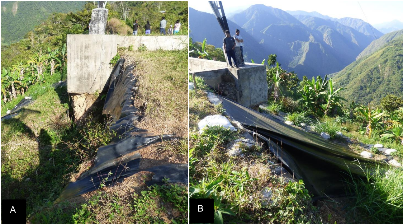
Figura 9. A y B. Muestran geomembranas colocadas con el fin de dar mayor estabilidad a la zona afectada, protegiéndola de la lluvia y evitando la saturación del suelo.
