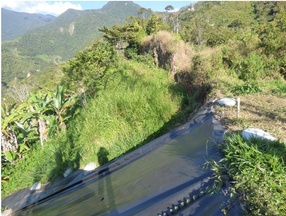
Fotografía 1. Geomembrana sobre el escarpe del deslizamiento. Vista hacia el oeste de la torre de alta tensión.
