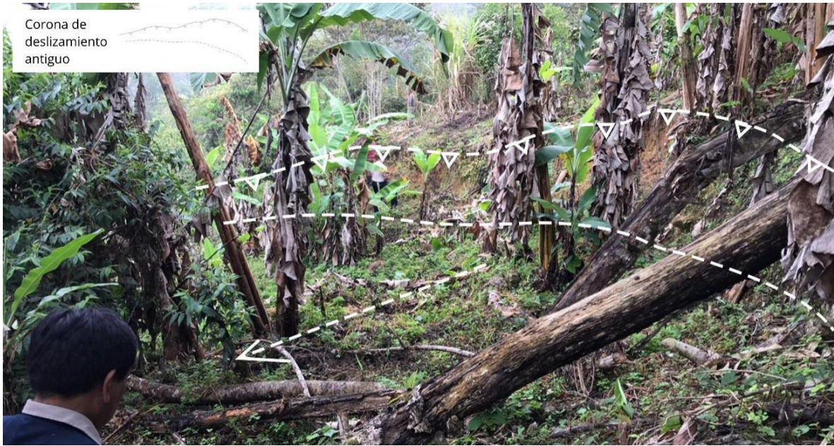
Figura 15. Corona de deslizamiento que afecta torre de alta tensión en San Emilio. Se observa el escarpe erosionado, evidencia de desplazamientos anteriores. Tomada de (Nuñez & Albinez, 2020)
