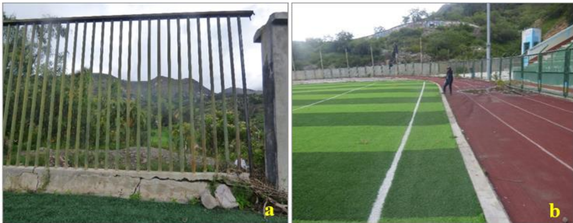
Figura 16: a) Vista de las rejas del estadio inclinadas a favor del movimiento. b) Piso ondulado del estadio Municipal de Chavín de Huántar.
