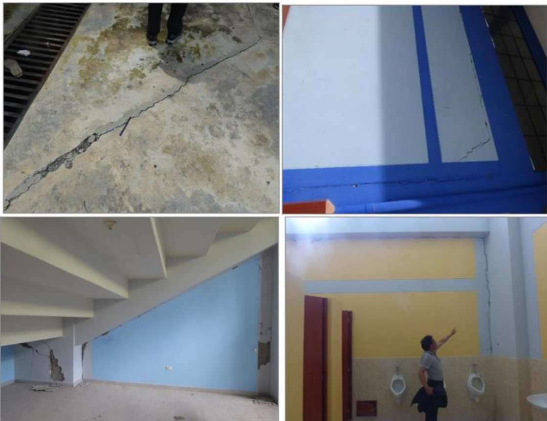
Figura 15. Vista de las rajaduras en el piso y paredes del interior de la tribuna del estadio Municipal de Chavín de Huántar.
