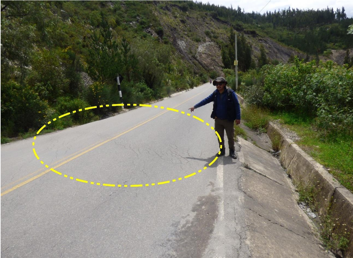
Figura 17. Deformación y agrietamientos milimétricos en la carretera Chavín de Huántar-San Marcos. Estas evidencias son indicativas de reactivaciones del deslizamiento por encima del estadio Municipal Chavín de Huántar. Coordenadas referenciales: UTM WGS84 Zona 18S 261326 E, 8942403 N.
