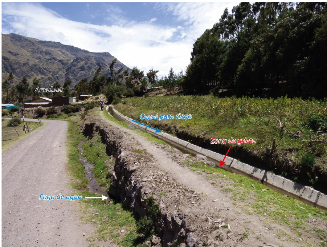
Figura 9. Canal de concreto para riego, con presencia de fugas debido al deterioro y/o agrietamiento del canal por la deformación del terreno.
