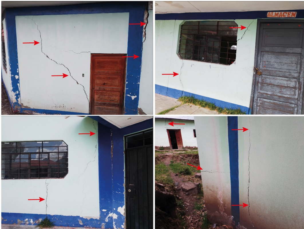
Figura 10. Muros agrietados en infraestructuras de ladrillo y cemento debido a la deformación del terreno.
