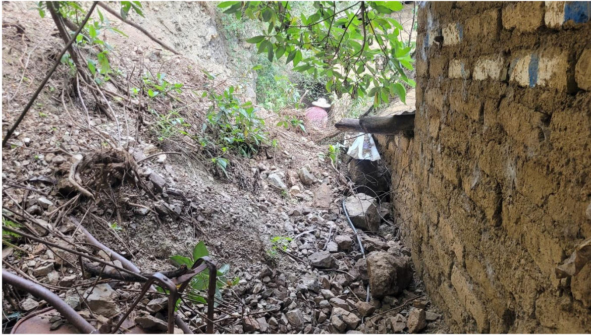
Fotografía 4. Depósitos coluviales en laderas con presencia de viviendas.
