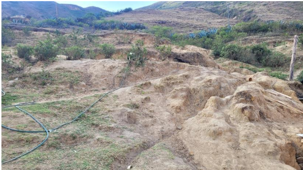
Fotografía 5. Se observa la ladera con escasa cobertura vegetal, lo que favorece la infiltración del agua y la saturación de los terrenos.
