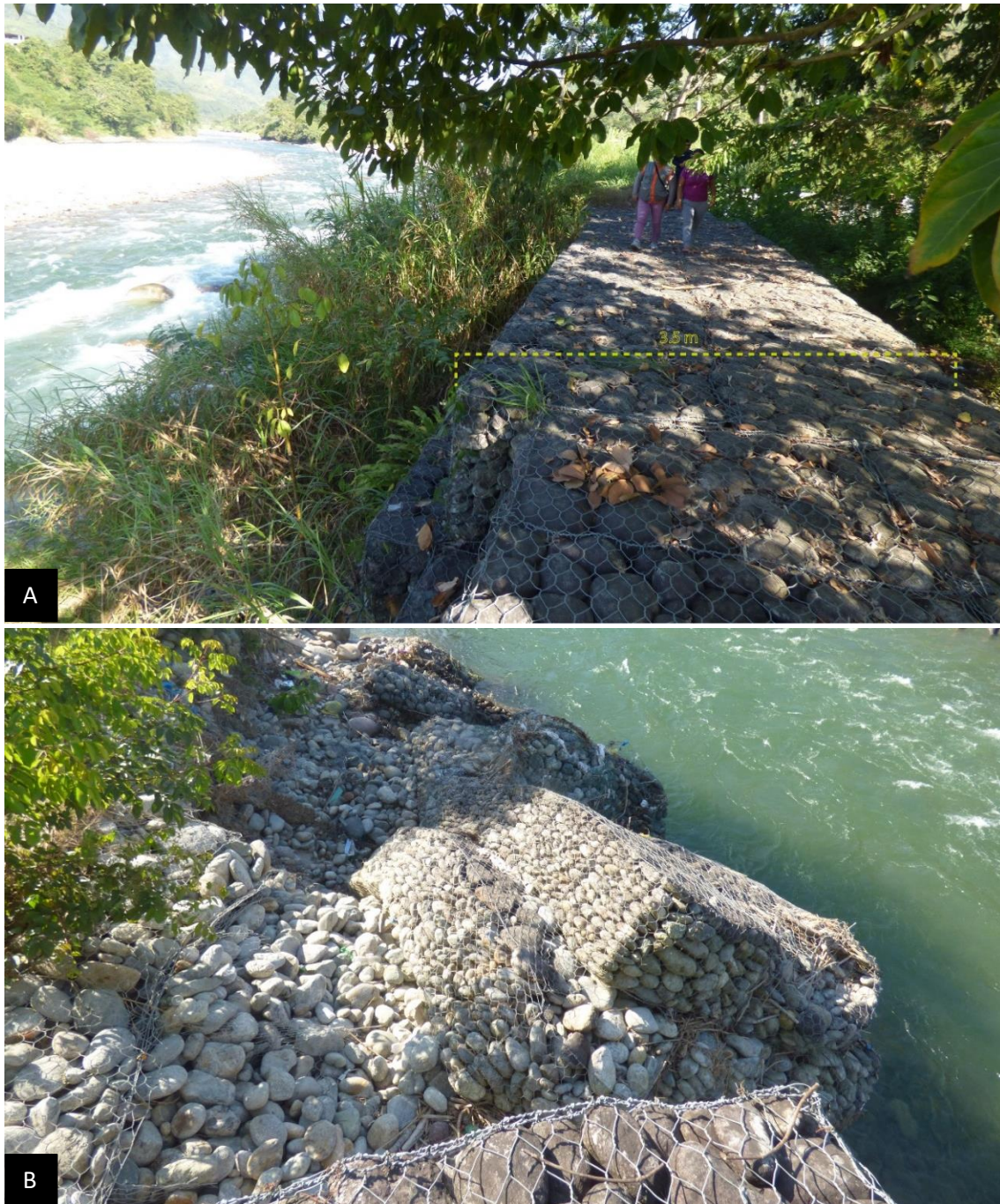
Figura 10. A. Gavión con ancho de 3.5 m de ancho, puesto en la desembocadura de la quebrada Agua Blanca. B. Afectación del gavión desde el año 2023, producto de la erosión fluvial en este sector. Coordenadas (E461519; N8770584).
