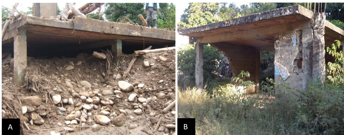
Figura 12. A. Vivienda afectada durante el flujo de detritos del año 2007, el material cubrió todo el primer nivel de la vivienda. B. Fotografía actual (junio 2023) de la vivienda, actualmente se encuentra abandonada.
