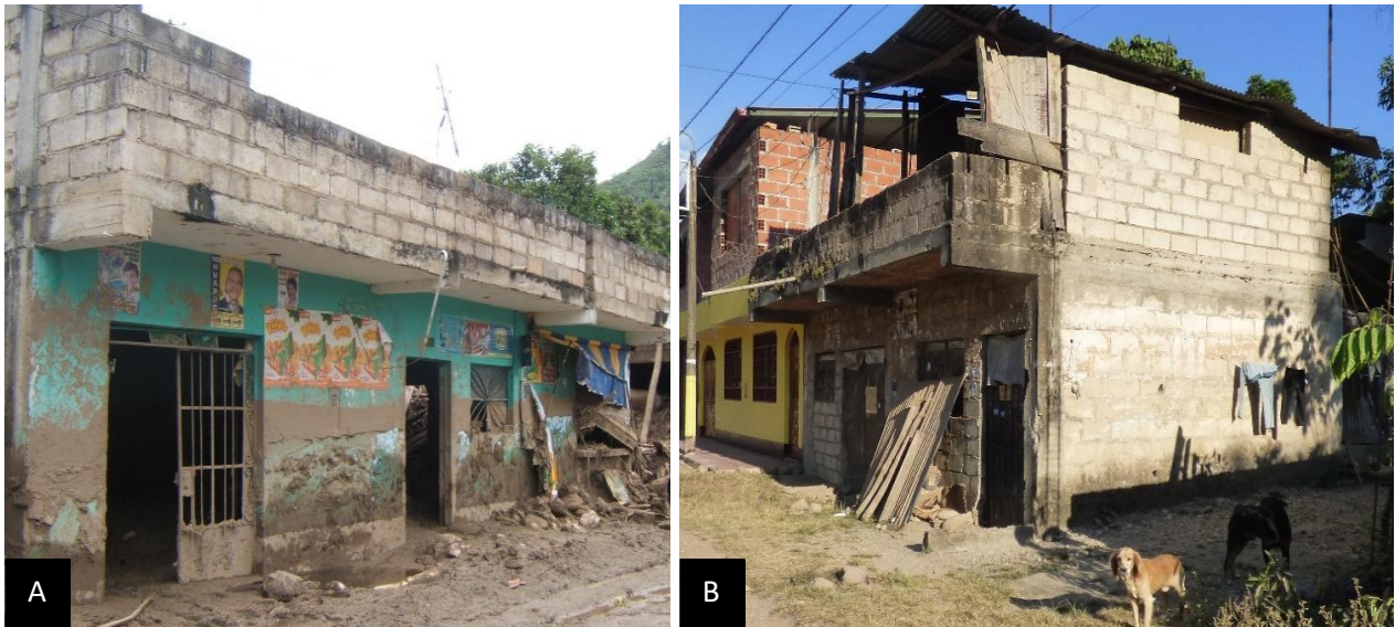
Figura 13. A. Vivienda afectada durante el flujo de detritos del año 2007, el material ingresó a la vivienda, cubrió todo el primer nivel hasta una altura de 1.7m. B. Fotografía actual (junio 2023) de la vivienda, actualmente se ha rehabilitado y se encuentra habitado. Coordenadas (E461271; N8769079).
