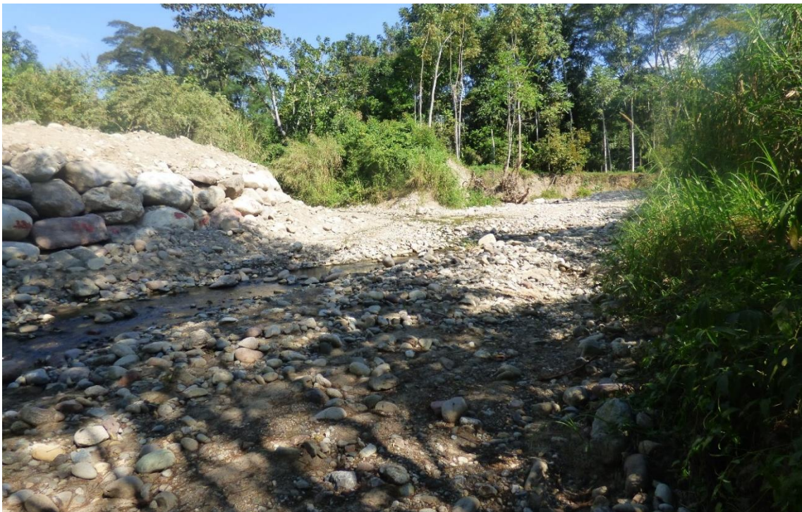
Fotografía 8. Desembocadura de la quebrada Bamba hacia el río Huacará, en la margen derecha del Huacará se tiene un enrocado con bloques de hasta 1.2 m de diámetro en forma semicircular. El cauce del río necesita ser descolmatado, el material acumulado es de fácil arrastre ante una crecida de río.
