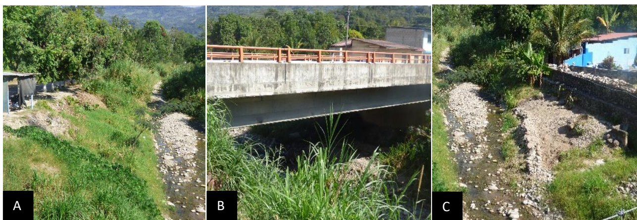
Figura 17. Aguas arriba del puente Huacará por ambas márgenes. A. Margen derecha. C. Margen izquierda, se observa un muro de contención que protege algunas viviendas en esta margen; sin embargo, una crecida de río podría afectar y poner en peligro dichas viviendas. Coordenadas (E459634; N8769663).
