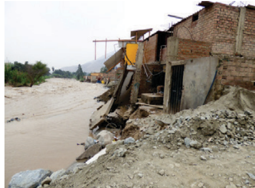
Erosión fluvial del río Rímac en el sector Santa María de Huachipa debido al fenómeno Niño Costero 2017 (distrito Lurigancho, provincia y departamento Lima)
