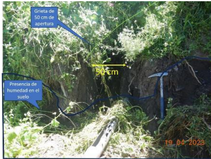
Figura 7: Se aprecia una grieta de 50 cm de apertura y el depósito con presencia de humedad.
