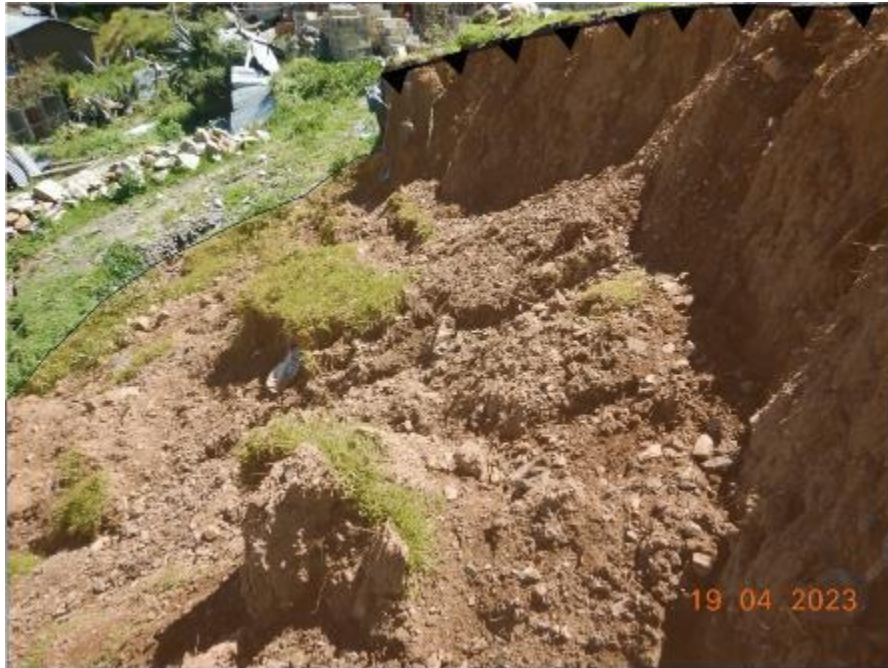
Figura 6: Escarpa con avance retrogresivo con dirección a las instituciones educativas de Curpahuasi.
