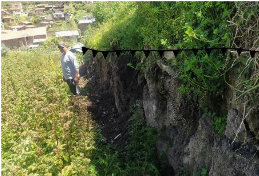
Figura 5: Escarpa principal del deslizamiento generado por un corte de talud para la construcción de una losa en la parte baja del sector Ccuchipuquio.
