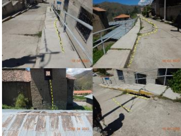
Figura 12: Em el centro poblado se aprecian grietas y rajaduras antiguas que se deben controlar.
