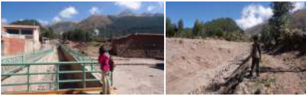
Fotos 7 y 8.- Obras de canalización dentro del poblado de Zurite (foto de la izquierda), y canal natural sin evidencias de obras de prevención (foto de la derecha).
