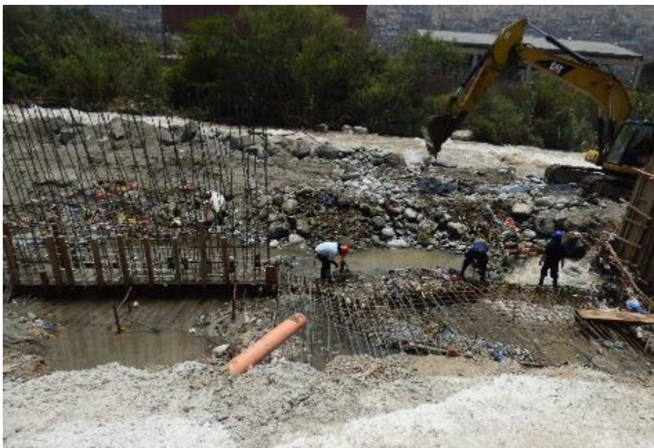
Foto 8. Se muestra parte de la columna de la defensa ribereña afectada.
