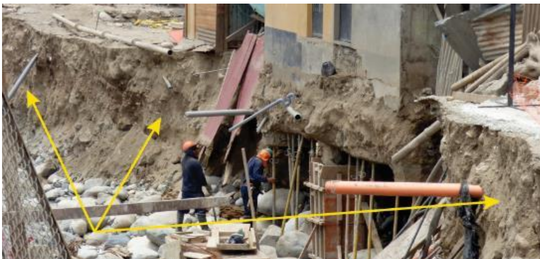
Foto 2. Sector Cantagallo, se muestra la terraza conformada por desmonte, observa tuberías de desagüe que sobresalen.
