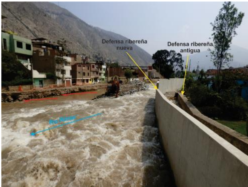
Foto 5. Se aprecia el muro antiguo y nuevo (defensas ribereñas). Las líneas de color rojo: indican la zona erosionada, el color celeste la dirección del cauce del río y el color amarillo las defensas ribereñas.
