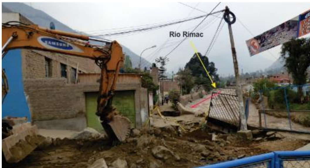
Foto 3. Sector La Perla afectado por la erosión fluvial (Foto: Ochoa et al , 2017)
