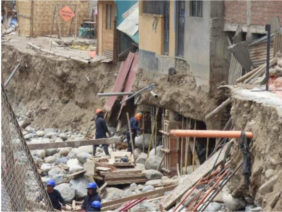
Foto 7. Parte de las viviendas afectadas por la erosión fluvial, se aprecia la base de una vivienda que "flotando".
