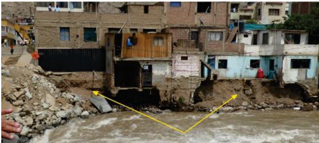
Foto 1. Sector La Perla, se señala terraza (líneas en color amarillo), conformada por relleno de desmonte, arena y bloques.
