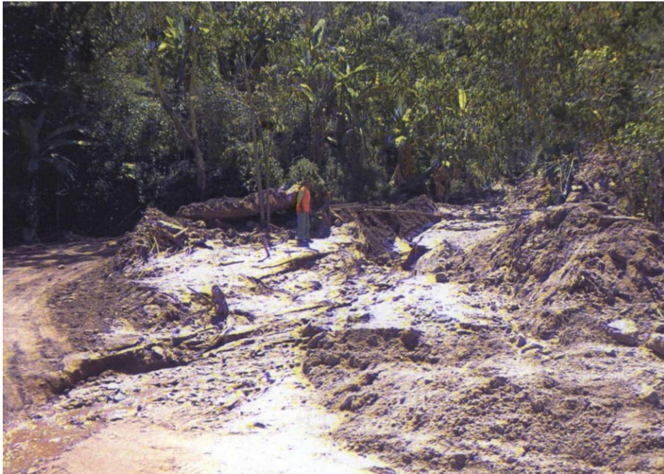
Foto 3. Vista del depósito del flujo de detritos afectó varios tramos de la carretera, se llevó un badén. (Foto M. D. Masma).
