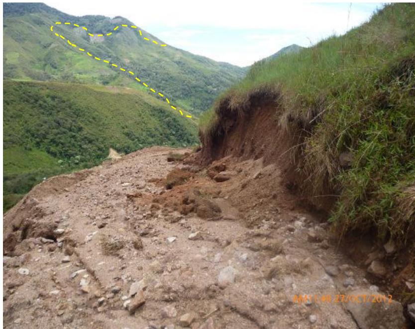
Foto 8. Derrumbe en la margen derecha de la quebrada, afectó varios tramos de la carretera al caserío de Villano. (Foto M. D. Masma).
