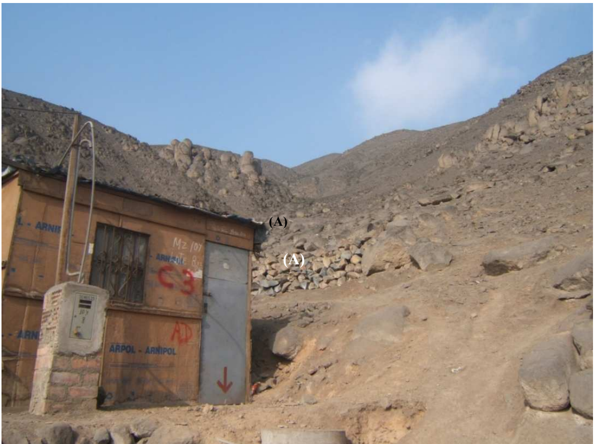
Fotos N°s 20, 21 y 22.- Vistas de la quebrada con potencial de producir flujos de lodo. Se aprecia un muro de contención precario (A).
