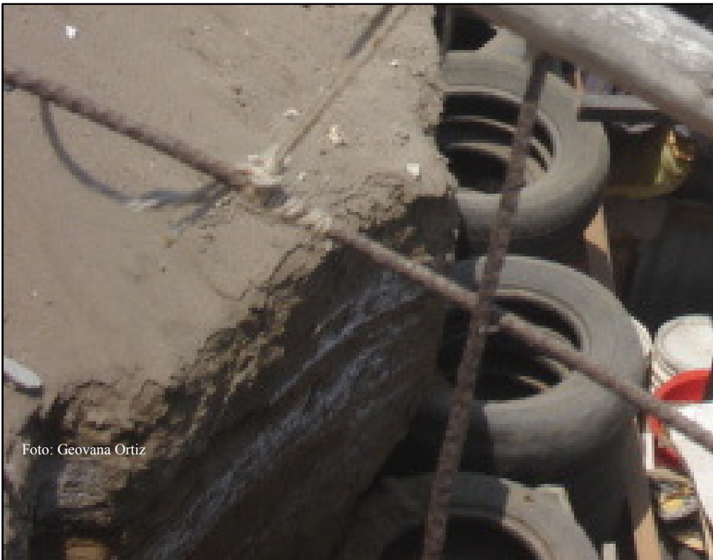
Foto 6.- En el corte de talud se aprecian las patinas de sal.
