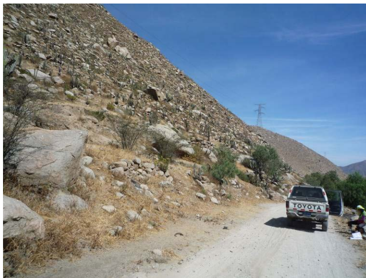
Foto 1. Bloques sueltos dispuestos en una ladera con una pendiente que supera los 30°. Afectan directamente la carretera Canta-San Buenaventura.
