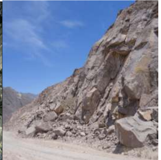
Foto 4.- Sector de Pachas, se aprecia que la roca presenta un fracturamiento a favor de la pendiente.
