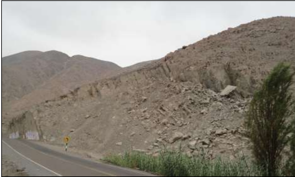
Foto 32.- Carretera Puente Fiscal-Cocachacra, se observan vuelcos de roca.
