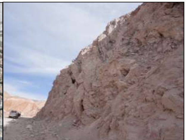
Foto 5.- Sector de Jaguay Chico, se aprecia la roca fracturada, y material caído al pie de la carretera.
