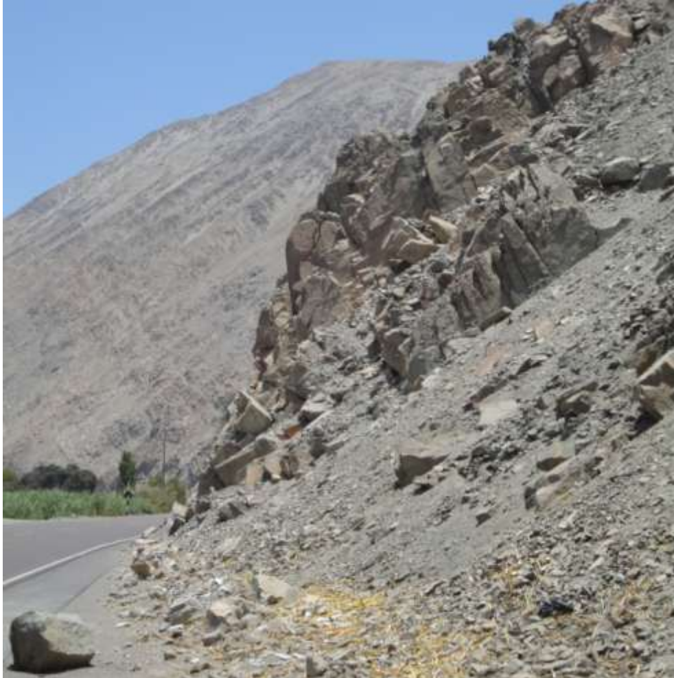
Foto 31.- Afloramiento de rocas intrusivas, se muestra un diaclasamiento contra talud el cual genera vuelco. Se observa fracturamiento abierto y fragmentos de roca inestables en el talud de corte.
