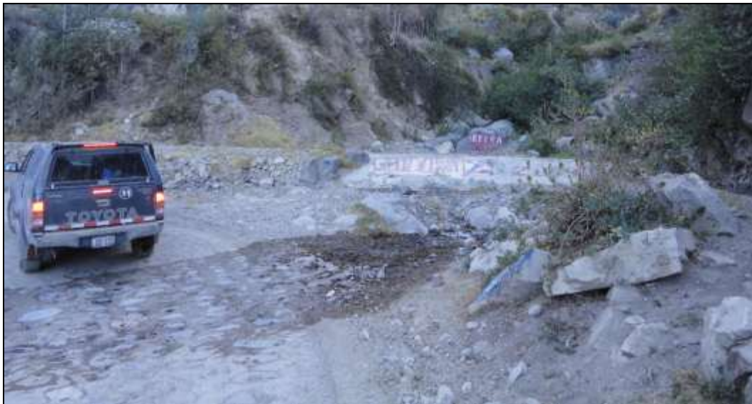
Foto 2.- Flujo de detritos que afecta a la carretera Carumas-Cuchumbaya, Sector Sotolojo.
