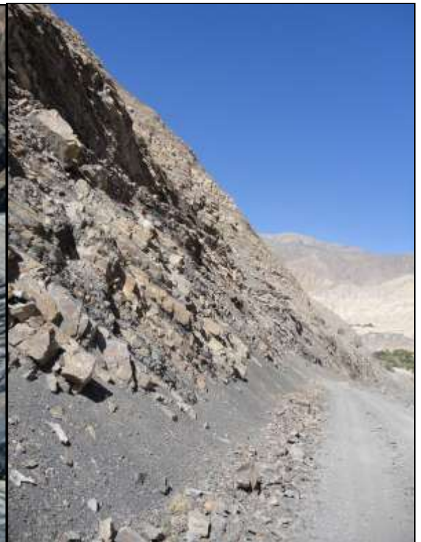
Foto 22.- Sector de Ccoro. Zona inestable, se aprecian bloques de rocas sueltos.
