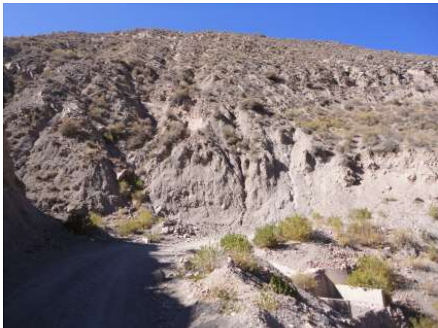
Foto 12.-Sector de San Pedro de Camata afectado por la erosión de laderas.
