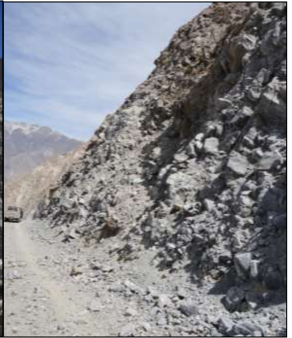
Foto 21.- Sector de Yamure. Zona inestable, se aprecian bloques de rocas sueltos.
