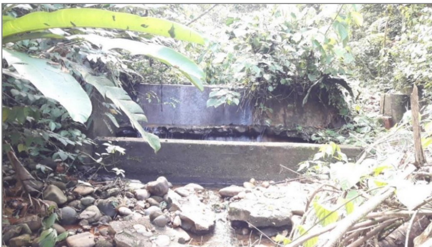
Fotografía 10. Vista de una captación de agua, el cual colapsó producto de la ocurrencia de flujo de detritos.
