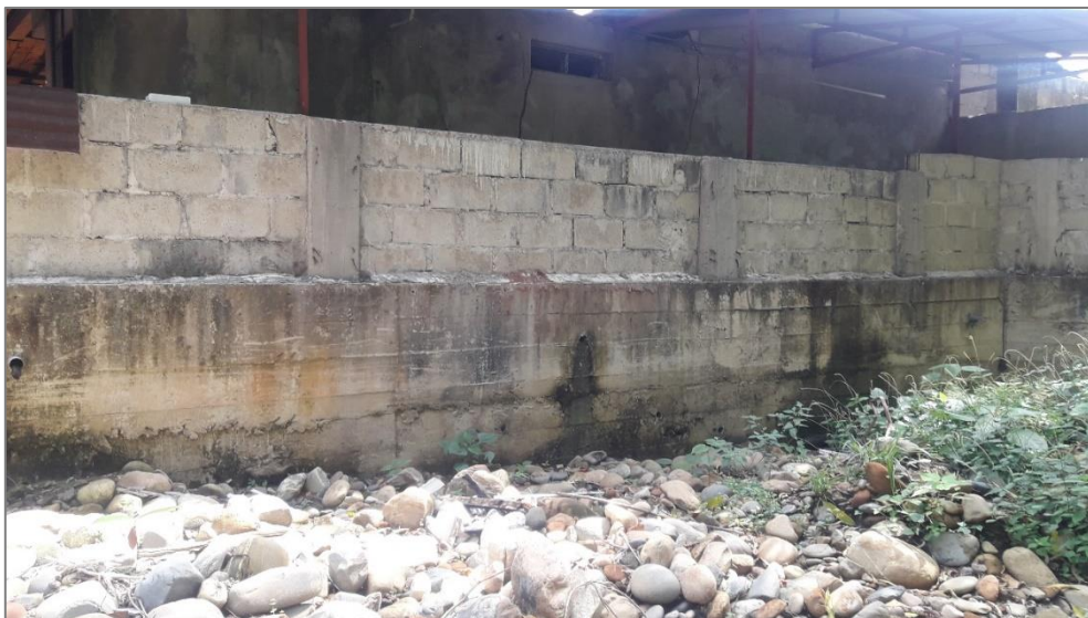
Fotografía 25. Vista del vertimiento de agua y desagüe a la quebrada Paucar.
