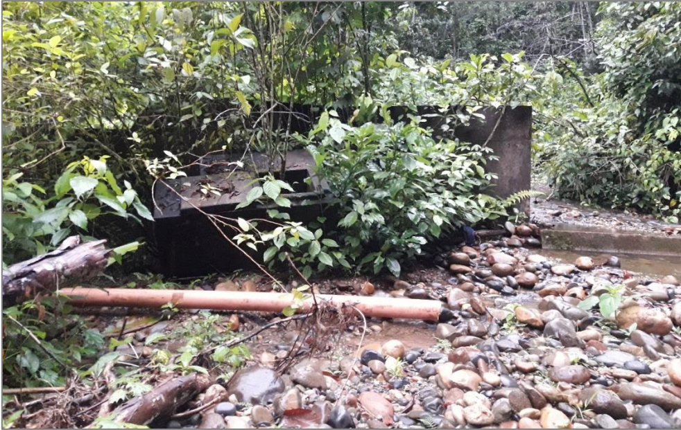
Fotografía 16. Vista de la captación de agua potable, el cual colapso producto de la avenida del flujo de detritos
