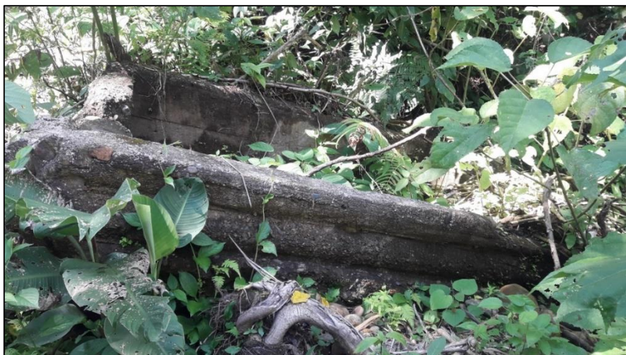
Fotografía 3. El flujo de detritos rompió la estructura del canal de captación.
