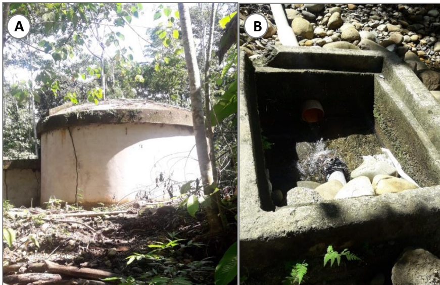
Fotografía 9. A) Vista de un reservorio con rajaduras en las paredes, ante un nuevo evento podría colapsar. B) Vista de una captación de agua en pésimas condiciones.
