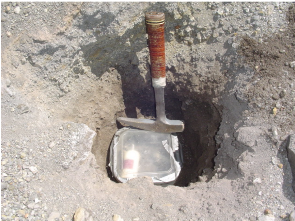
Fig. 11 – Instalación del Sensores térmicos UTL-1 en el suelo junto a la fumarola a una profundidad de 35 cm.
