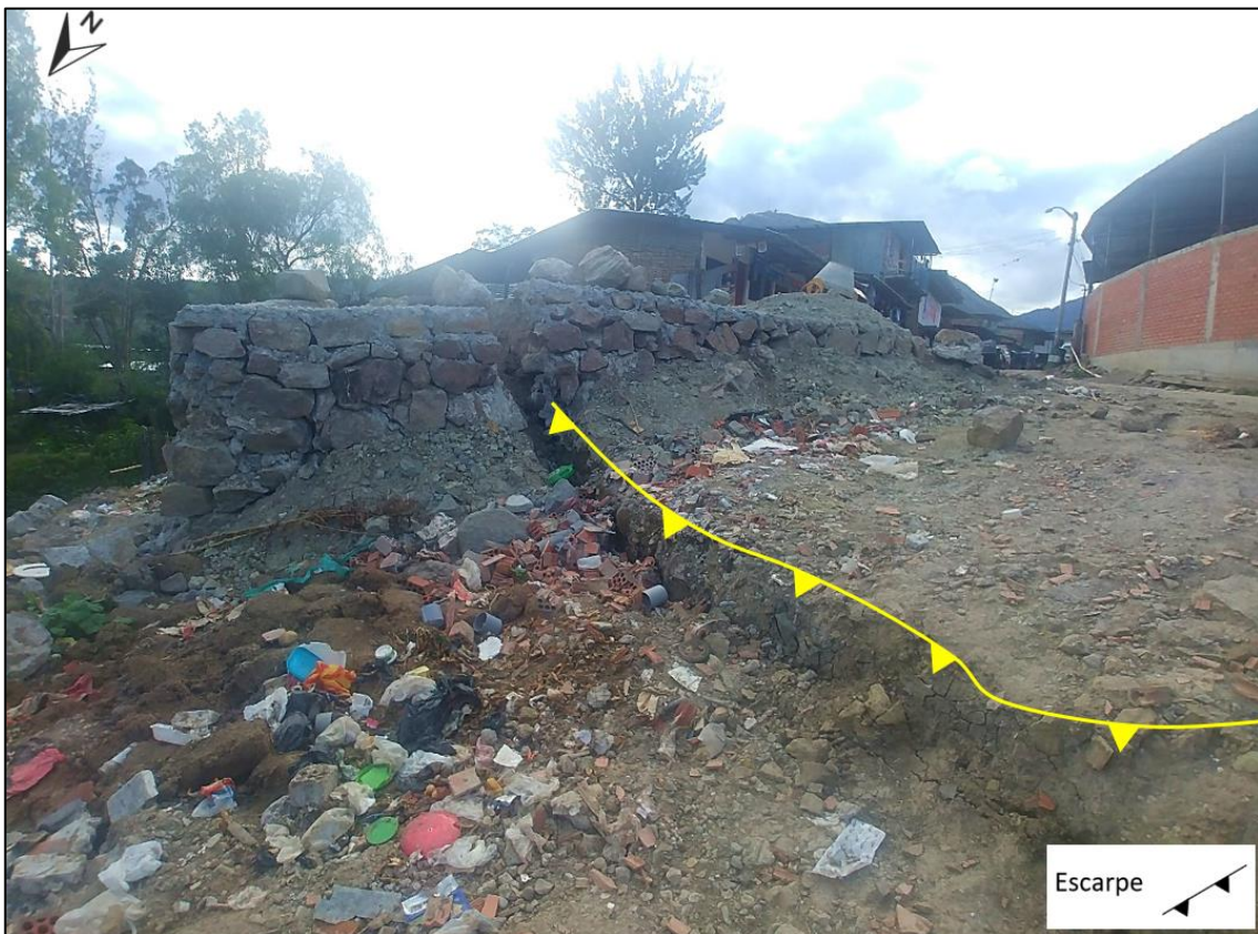
Figura 22: Escarpe de un deslizamiento, el evento ha afectado un muro artesanal.
