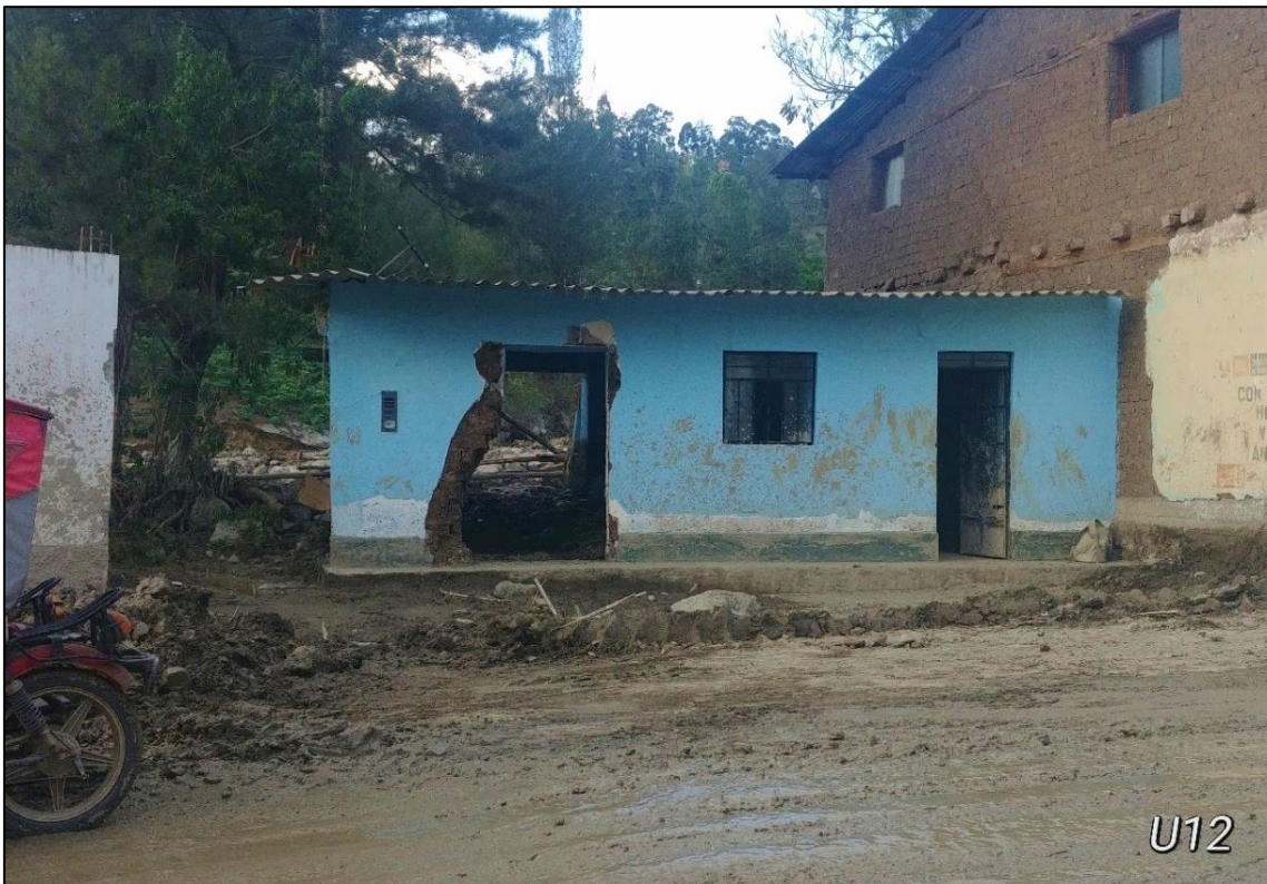
Fotografía 5: Material transportado por el huayco afecta vivienda, dejándola en condición de inhabitable.
