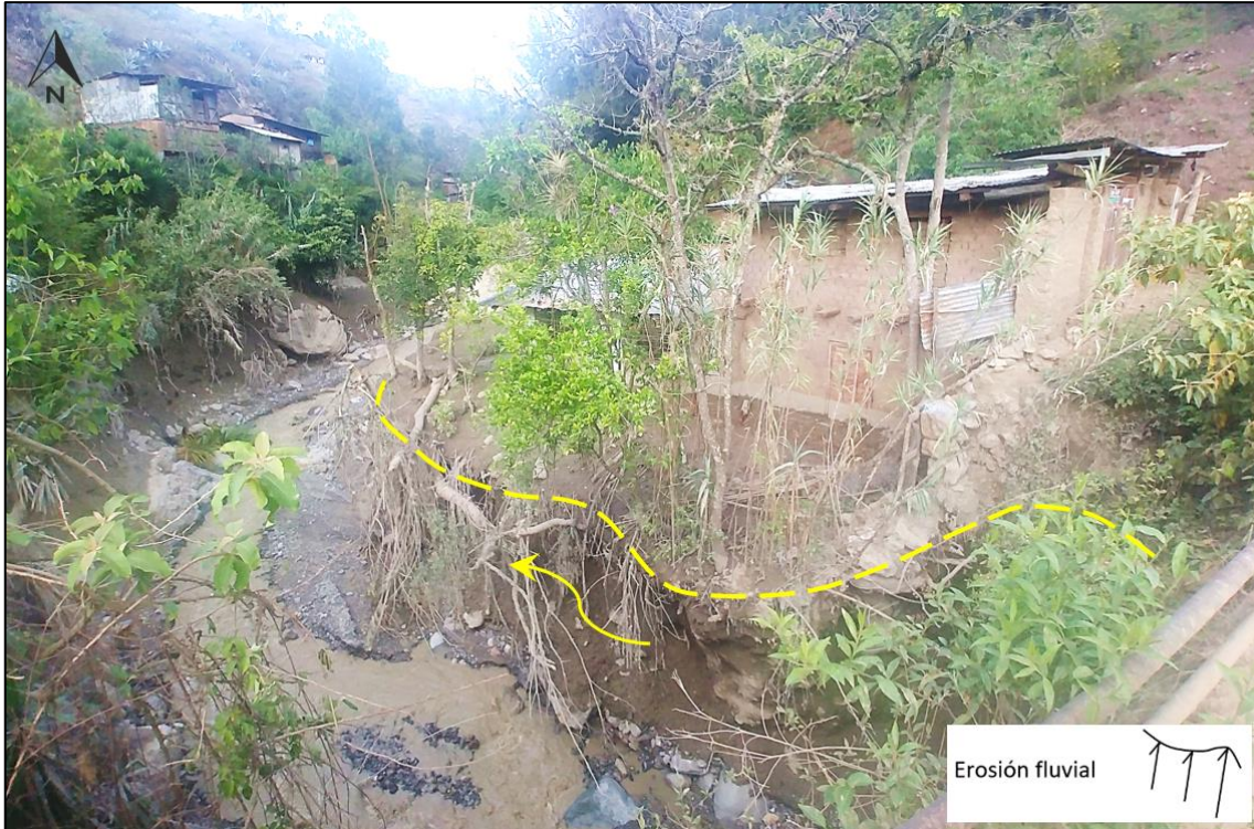
Figura 21: Vivienda que puede colapsar por la erosión de la margen izquierda de la quebrada. Vista tomada desde el puente Cerro Colorado.
