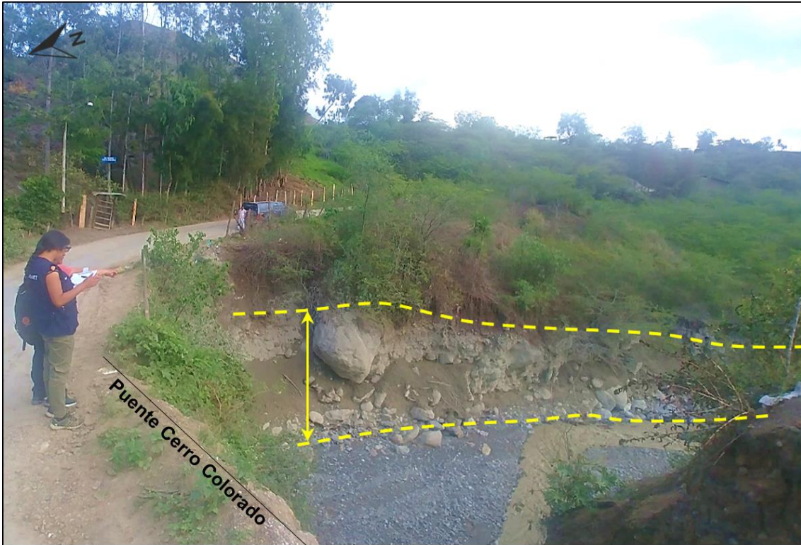
Figura 19: En la margen izquierda de la quebrada Ungulo se observa que el material transportado alcanzó alturas promedio entre 3 y 4 m, socavando la ribera.
