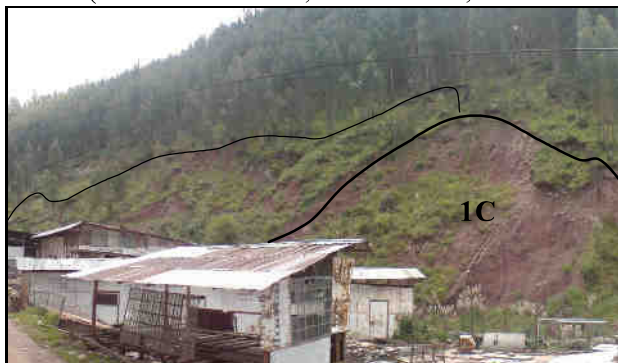
Foto 1. Campamento Municipal y deslizamiento 1C.
