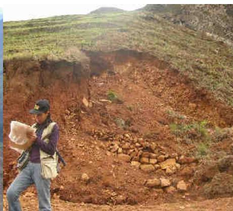
Foto 3: Pequeños derrumbes en el tramo Waywacalle-Mirador
