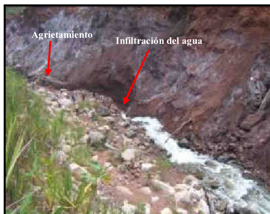
Foto 2.- Vista panorámica del sector donde se infiltra el agua y el sector agrietado por la erosión fluvial.
