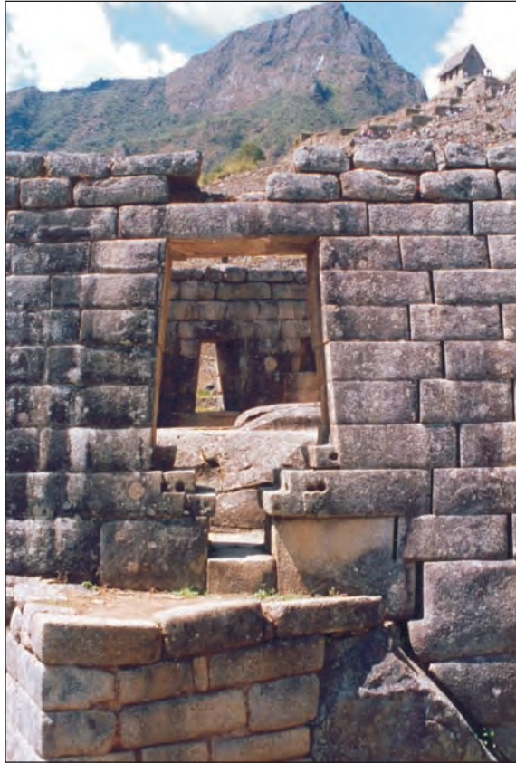
Foto 38. Puerta de las Serpes con separación de juntas.
