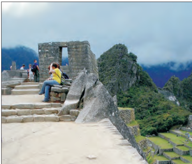
Foto 32. Fractura que corta el granito y permite la infiltración de aguas. En primer plano, rastros de erosión superficial del piso impermeable.
