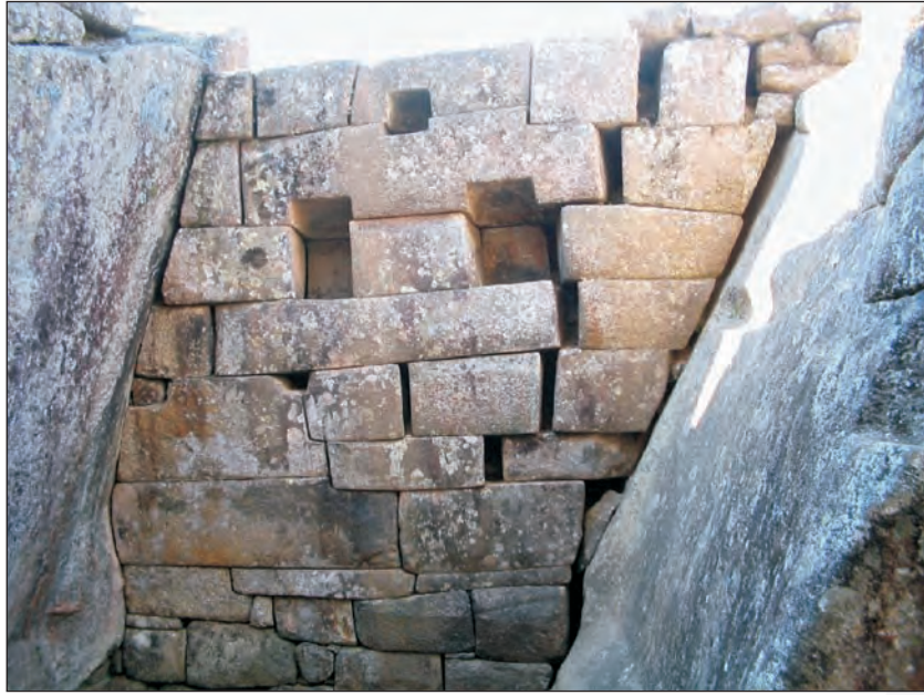
Foto 44. Muro construido y apoyado sobre bloques de caos granítico, con evidencias de separación de jambas.
