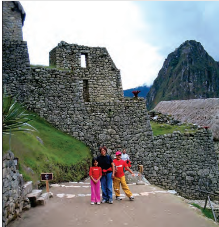
Foto 69. Separación de juntas en el muro sur de los Recintos 5 y 6 del Conjunto de Andenes 11.
