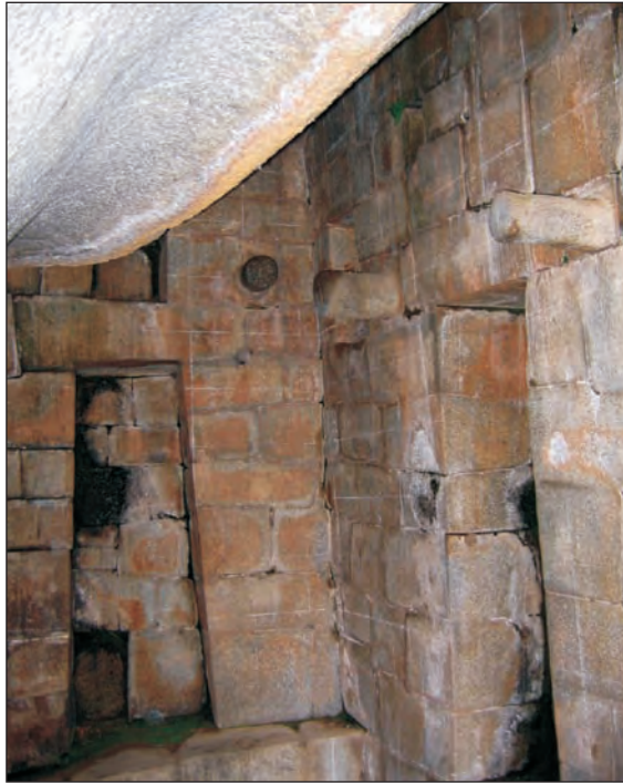
Foto 42. Muros norte y oeste de la Tumba Real con separación de juntas y presencia de musgos por la humedad.
