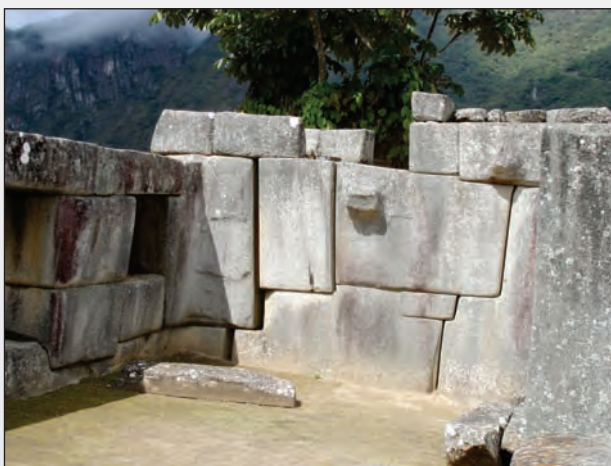
Foto 25. Templo de las Tres Ventanas con separación de juntas en el extremo sureste, donde hay mucha humedad.
