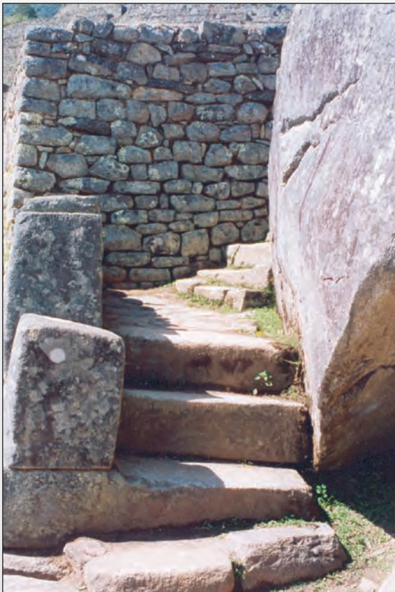
Foto 45. Asentamientos de las gradas en el contacto con el bloque de granito del Torreón.
