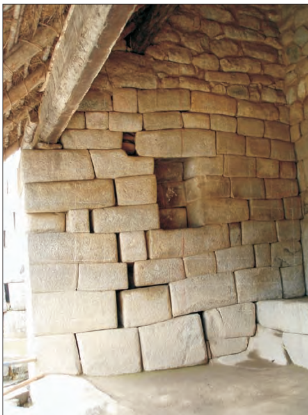
Foto 48. Separación de juntas en la pared sur del Centro Ceremonial.
