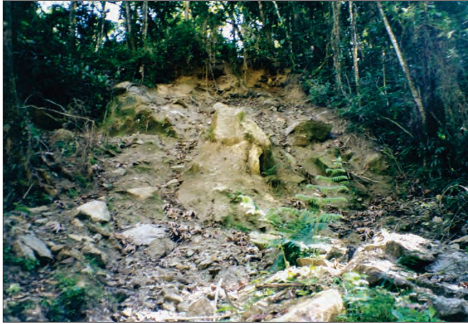
Foto 9. Deslizamiento activo en la parte media de la margen derecha de la quebrada Alcamayo. Vista tomada el año 1999.
