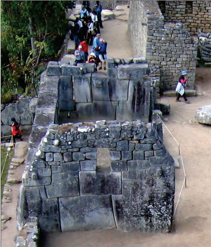
Foto 24. Templo de las Tres Ventanas con separación de juntas en las paredes norte y sur debido a asentamientos.
