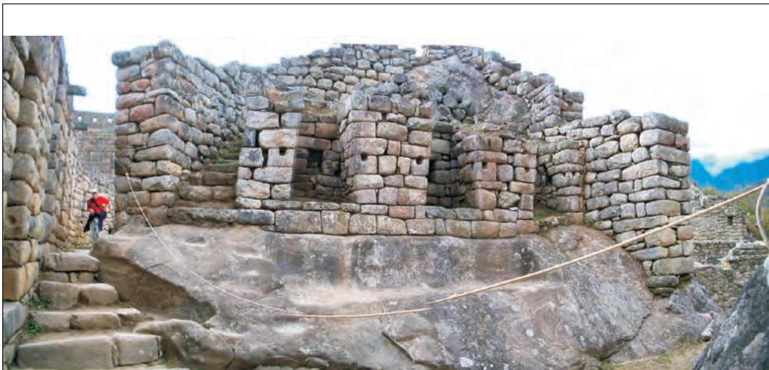
Foto 60. Separación de juntas en los muros del Conjunto 17.
