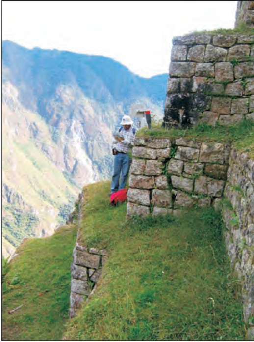
Foto 67. Muros de contención con efectos de asentamiento y separación de juntas en el Conjunto de Andenes 8, ubicados al oeste del Intiwatana.
