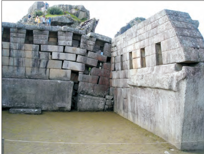
Foto 15. Asentamiento de la pared norte del Templo Principal. Nótese la humedad del piso.
