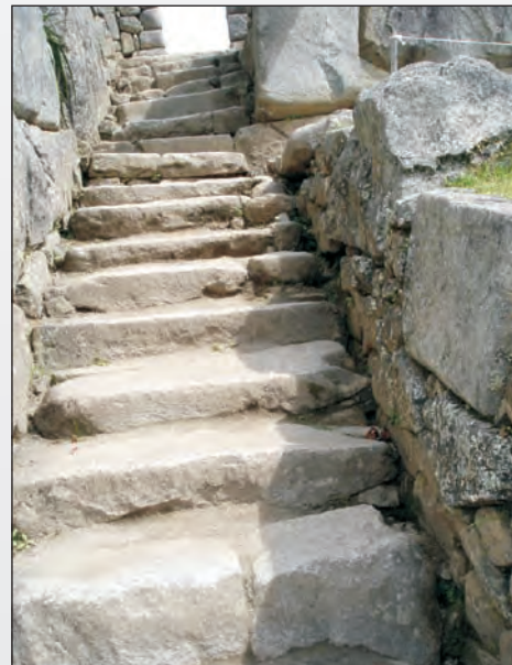
Foto 26. Asentamiento ligero y erosión en la escalinata de ingreso a la Plaza Sagrada.
