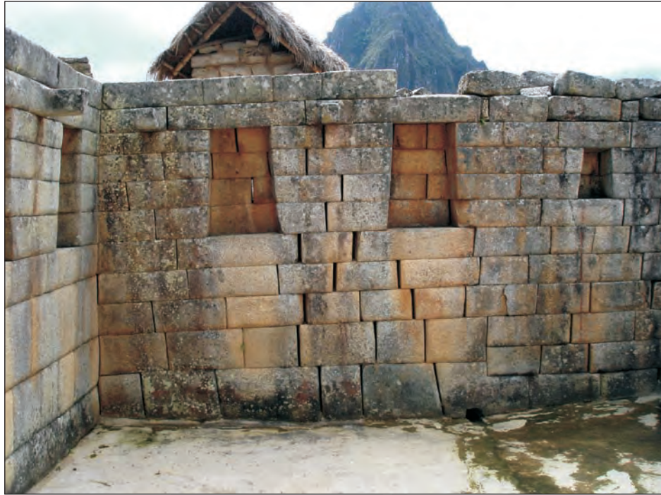
Foto 40. Separación de juntas en el ala oeste y sumidero en la parte baja del muro interior norte del Recinto 4.
