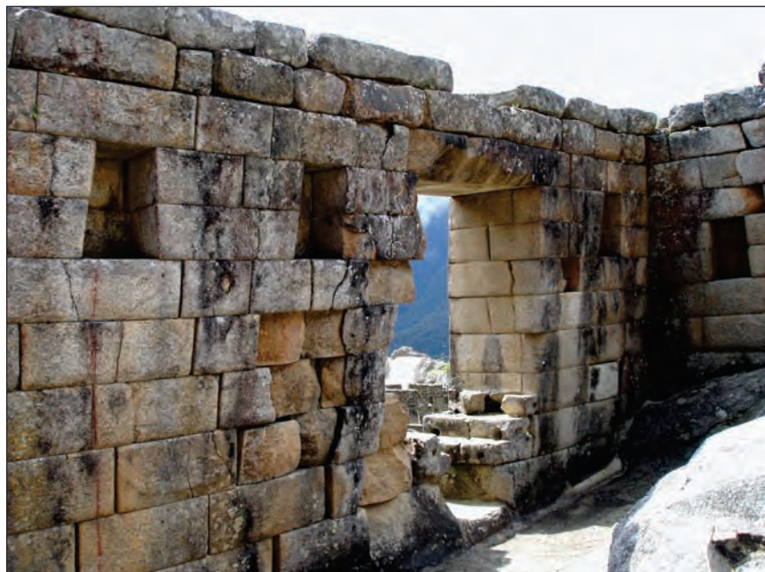
Foto 39. Interior de la Puerta de las Serpes con separación de juntas y efectos de meteorización.
