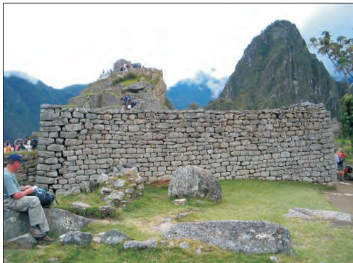
Foto 27. Separación de juntas en el ala este y oeste del muro exterior sur de la Casa del Sacerdote.
