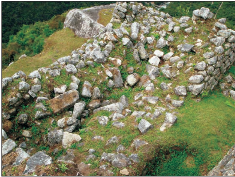
Foto 13. Proceso de sufusión que ha causado el colapso de muros en este recinto del Conjunto 13.
