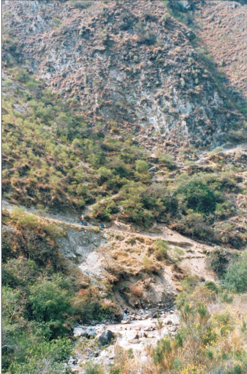
Foto 14. Deslizamiento que afecta el camino en el tramo Qoriwayrachina-Wayllabamba. Vista tomada el año 1994.
