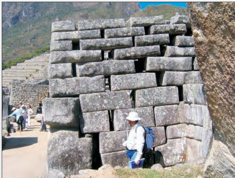
Foto 29. Parte posterior de la pared norte del Templo Principal, con separación de juntas.
