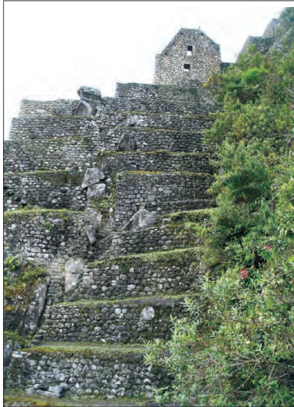
Foto 76. Andenes incas que estabilizan una ladera con evidencias de deslizamiento, en la cima del cerro Waynapicchu.
