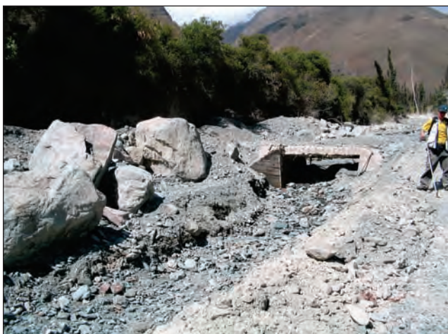
Foto 6. Puente carrozable inhabilitado por los depósitos del aluvión.
