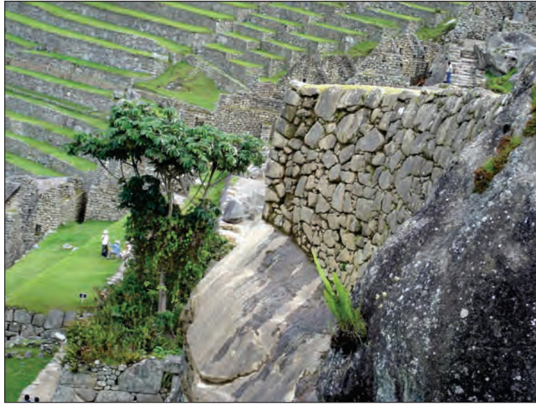
Foto 34. Zona de alto peligro en la plataforma sur del Intiwatana, en ella se ve la deformación del muro por infiltración de las aguas.
