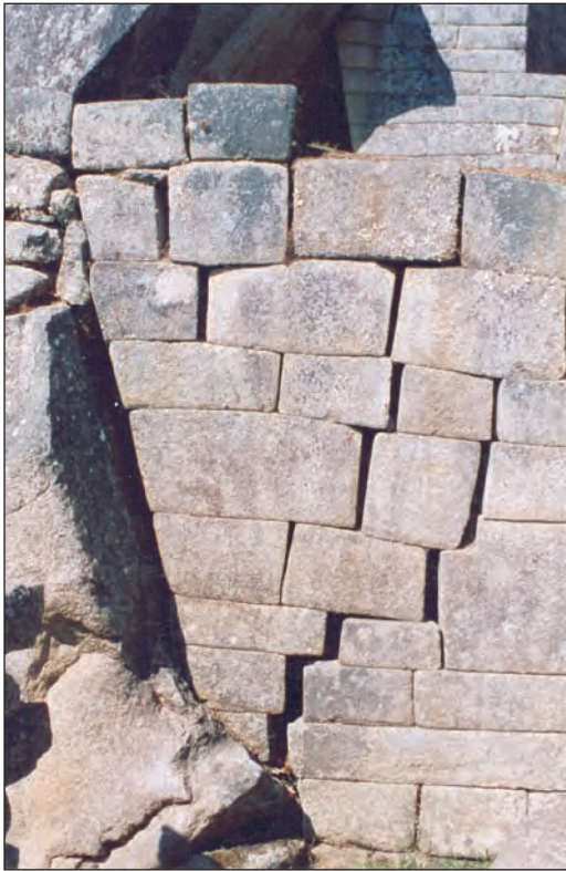
Foto 46. Separación de juntas en el muro y el contacto muro-bloque de granito en la zona de ingreso al Patio A (Fig. 20).
