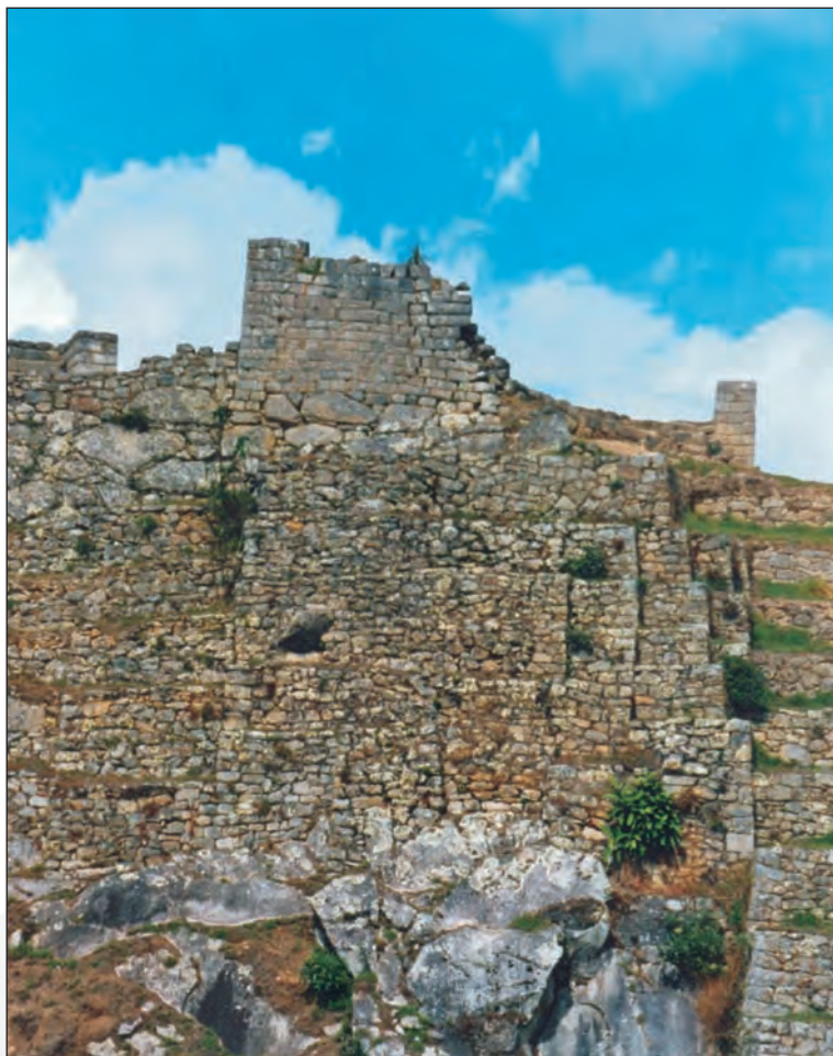
Foto 33. Ladera oriental del Intiwatana que muestra el agrietamiento que afecta el muro este del Recinto 2 y los andenes inferiores. Foto tomada el año 1994. Actualmente los agrietamientos persisten en los muros inferiores.
