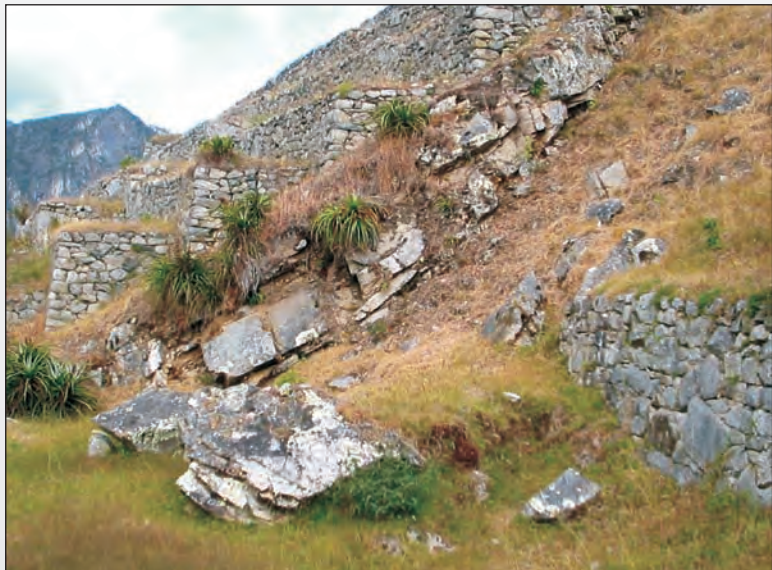
Foto 68. Terrazas del Conjunto de Andenes 10, construidos sobre granitos muy fracturados que comienzan a deslizarse.
