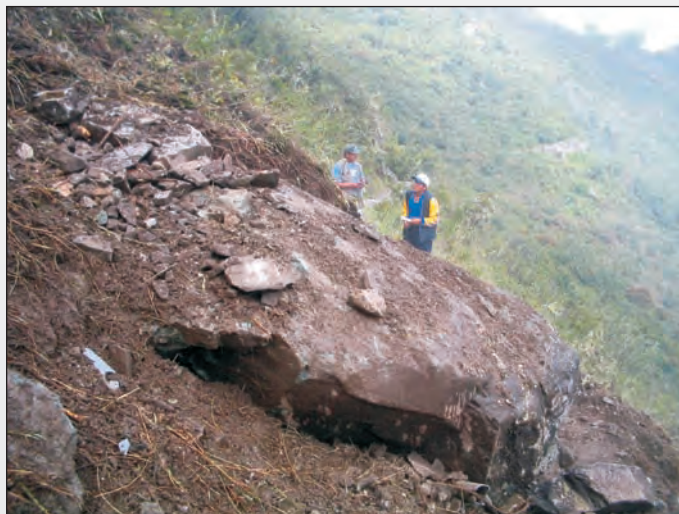
Foto 18. Derrumbe del 2006 que afectó al camino inca, en el tramo Intipunko-ciudad inca.
