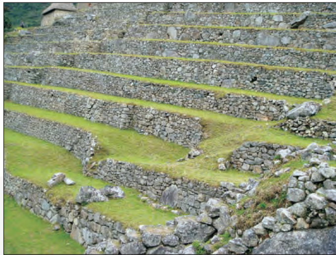
Foto 17. Reptación que afecta a las terrazas agrícolas del Conjunto de Andenes 11.
