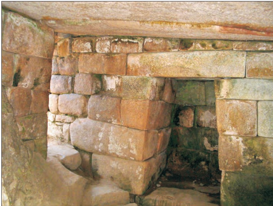
Foto 53. Construcción inca subterránea con presencia de musgos debido a la humedad originada por las filtraciones de aguas pluviales.
