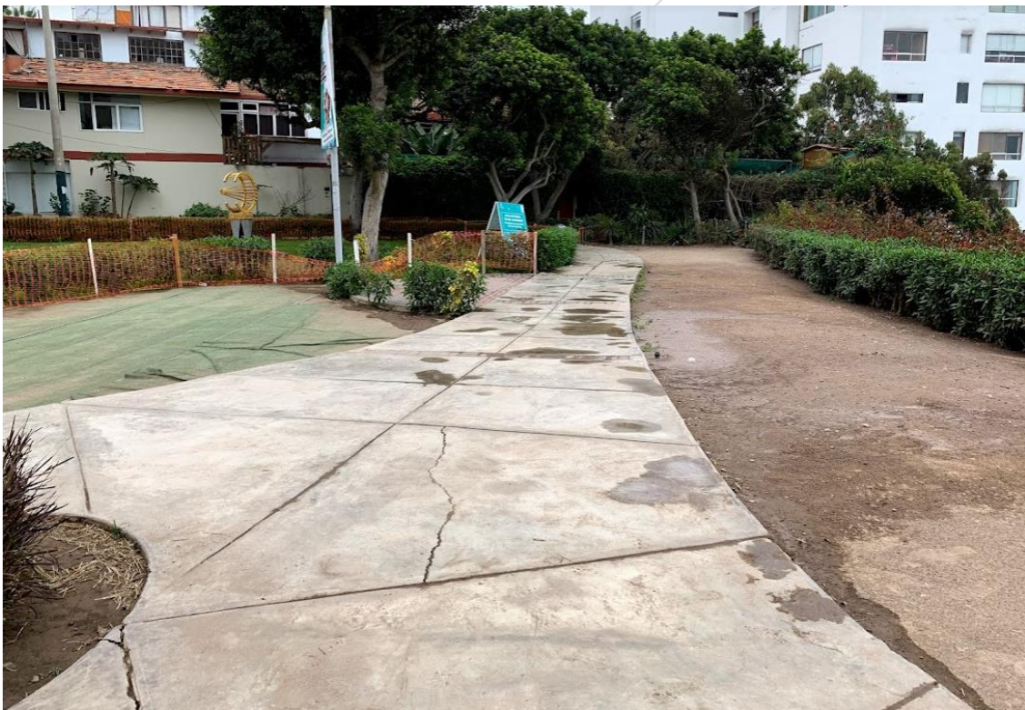
Figura 347. Malecón de los ingleses con grietas por presencia de rellenos antrópicos.
