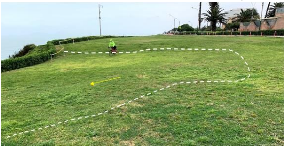
Figura 314. Hundimiento de forma circular en el Parque Mahatma Gandhi. Posiblemente corresponda a un deslizamiento en relleno antrópico.
