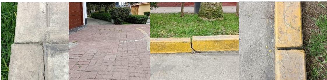
Figura 289. Grietas y desplazamientos de hasta 7 cm.
