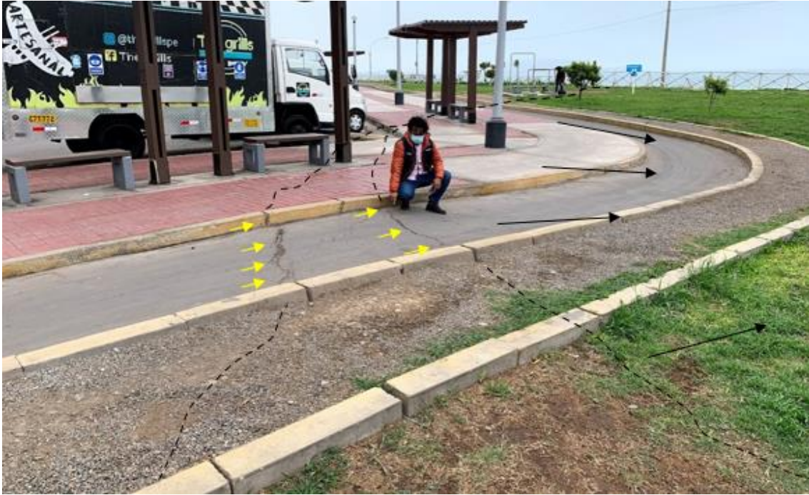
Figura 266. Grietas que evidencian fallas circulares con potencial de formar un escarpe de deslizamiento.
