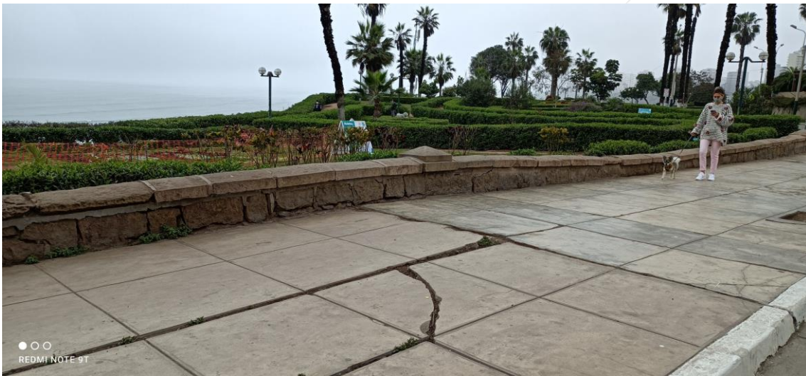
Figura 351. Malecón de Barranco con potencial de hundimiento, se aprecian grietas y subsidencias en la parte superior del acantilado.
