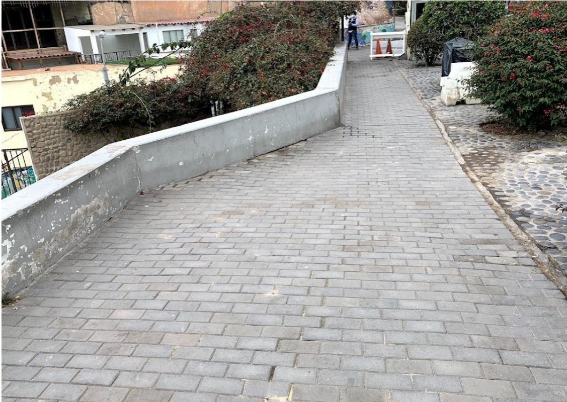
Figura 348. Malecón Ramón Castilla con asentamientos por presencia de rellenos.
