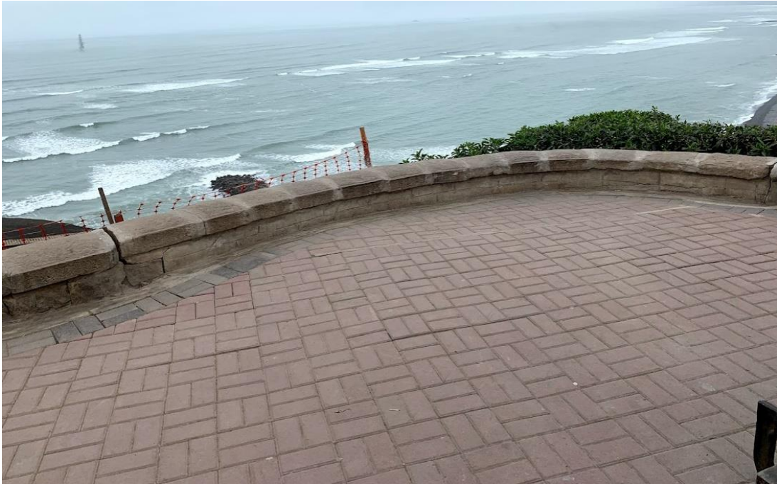
Figura 346. Grietas en muros de malecón Souza.
