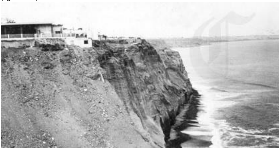
Figura 277. Zona de derrumbes en el distrito de Magdalena. Fotografía: ElComercio.pe.
