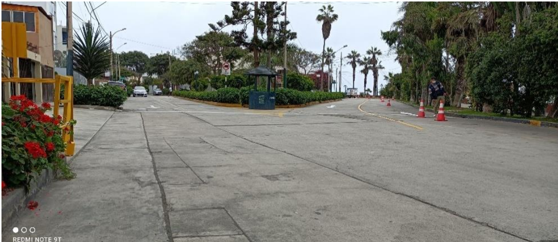
Figura 290. Grietas longitudinales de 34 m de largo.
