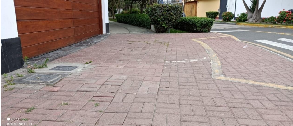
Figura 313. Hundimientos inventariados sobre antiguas cárcavas.
