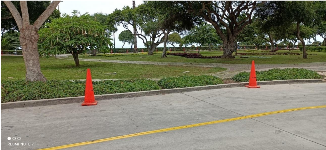
Figura 308. Grietas longitudinales con aberturas de pocos centímetros.
