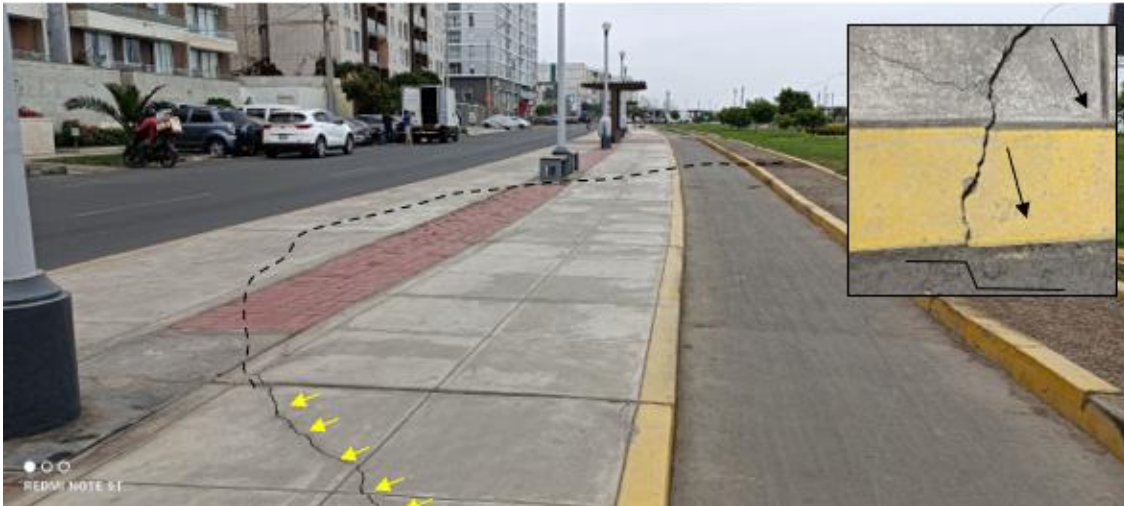
Figura 263. Grieta por falla circular, juntas de veredas desplazadas.
