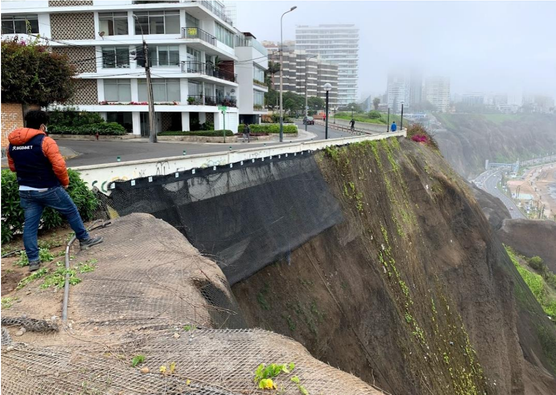
Figura 330. Pase aéreo sobre derrumbe en la intersección del malecón de La Reserva y calle Porta.
