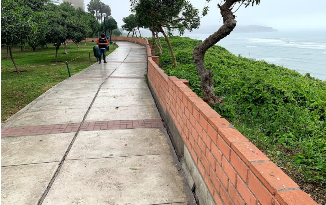
Figura 328. Inclinación de muros en parque Pedro Paulet.
