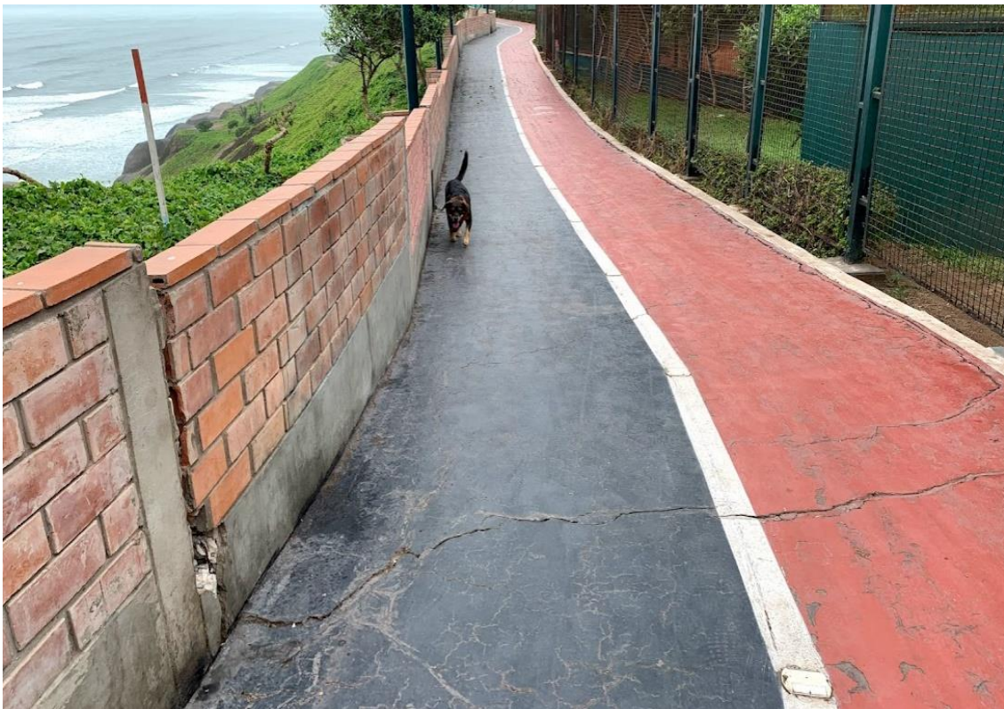
Figura 327. Grietas en muros y veredas, parte posterior de Roland Parks Perú.
