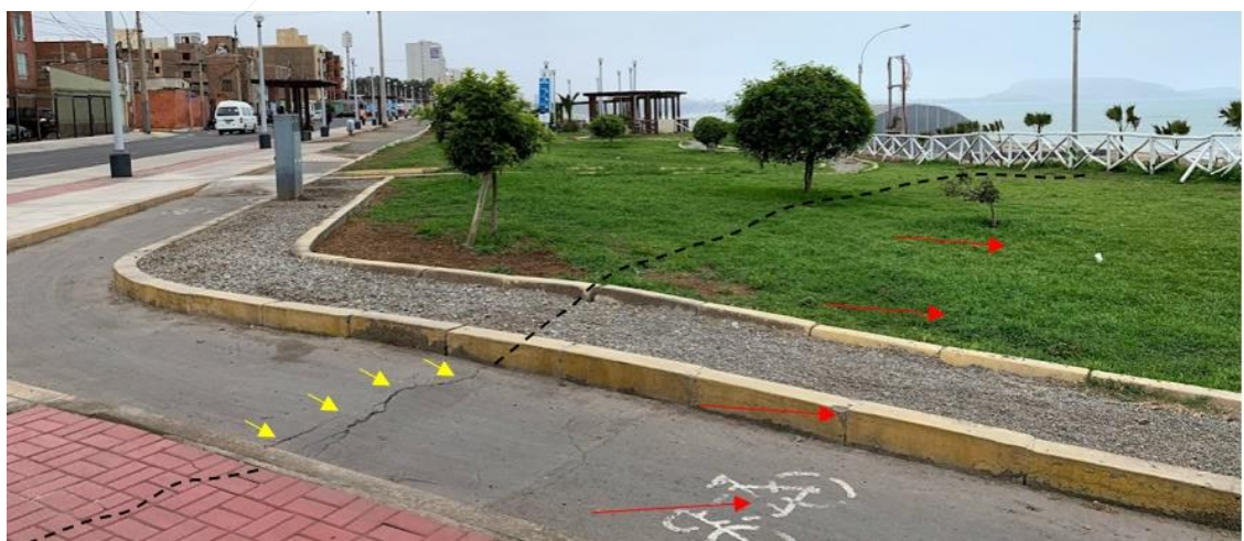
Figura 262. Grietas longitudinales de 60 m y ancho de hasta 10 cm.
