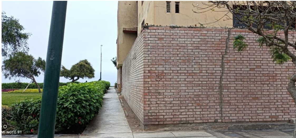
Figura 288. Los desplazamientos generan grietas en paredes, pisos, veredas y sardineles.
