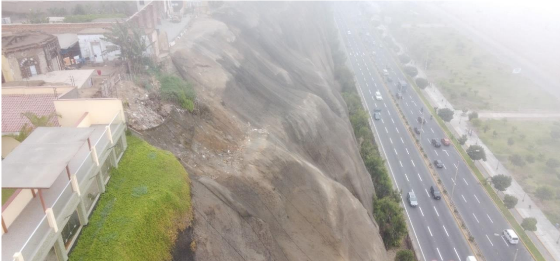
Figura 285. Vista hacia el acantilado expuesto a derrumbes a la altura del Jr. Echenique.
