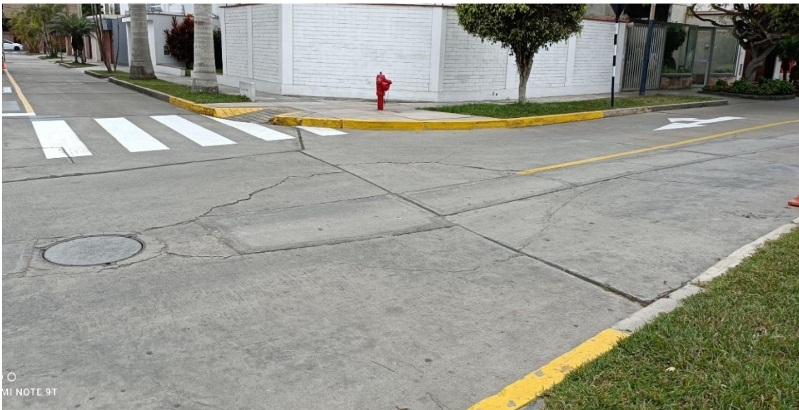
Figura 309. Las grietas tienen forma circular y elongada desplazando pisos, veredas y sardineles.
