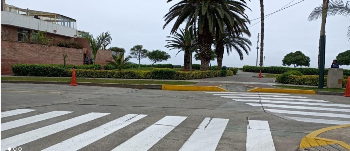
Figura 296. Hundimientos inventariados sobre antiguas cárcavas.
