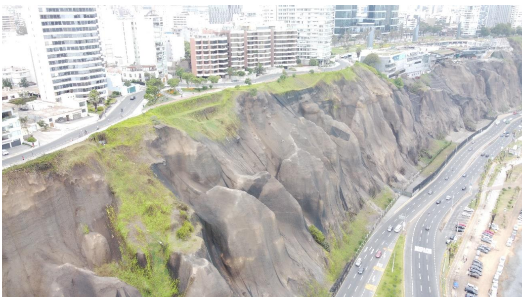
Figura 326. Vista aérea de zonas de derrumbes en las inmediaciones del CC. Larcomar.
