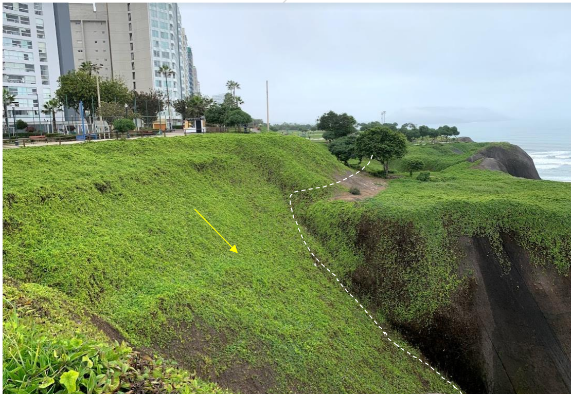
Figura 332. Rellenos antrópicos esparcidos sobre el acantilado, parque María Reiche.
