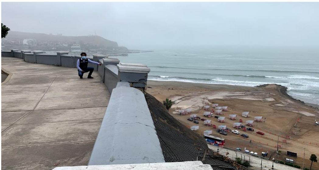
Figura 367. Muro inclinado en Malecón Costa Sur.
