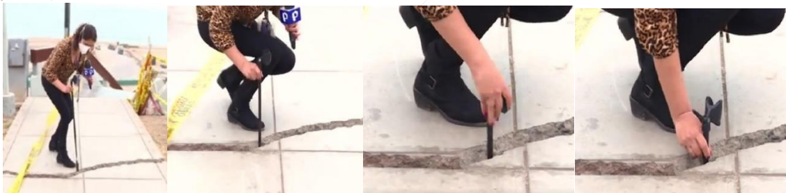
Figura 261. Grietas de hasta 1 m de profundidad, registrada por periodistas el 06 de noviembre del 2020. (Fuente: Panamerica.pe).
