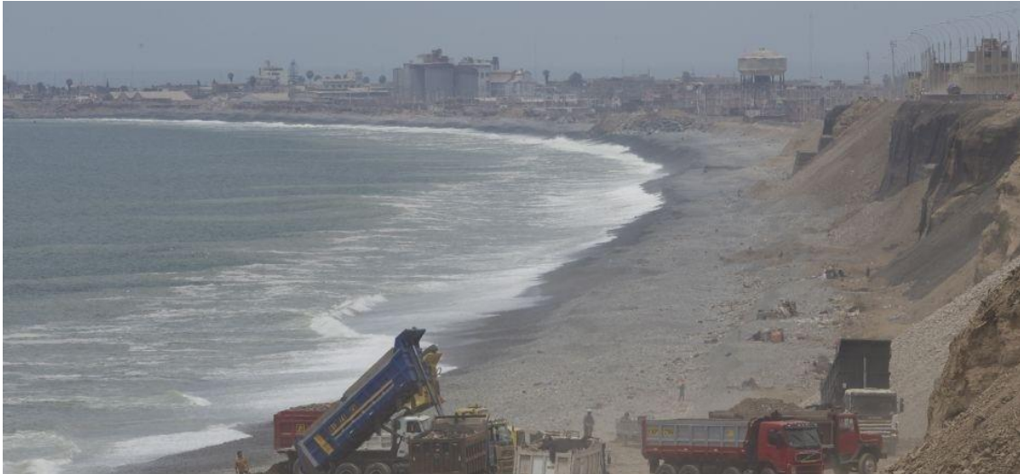
Figura 258. Vista hacia el extremo noroeste del distrito de San Miguel límite con el distrito de la Perla, se observan derrumbes próximos al pie del talud.
