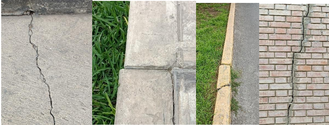
Figura 310. Pistas, veredas, sardineles y paredes con presencia de grietas que se alinean y siguen direcciones de falla de tipo circular, en las inmediaciones del parque de la Pera.
