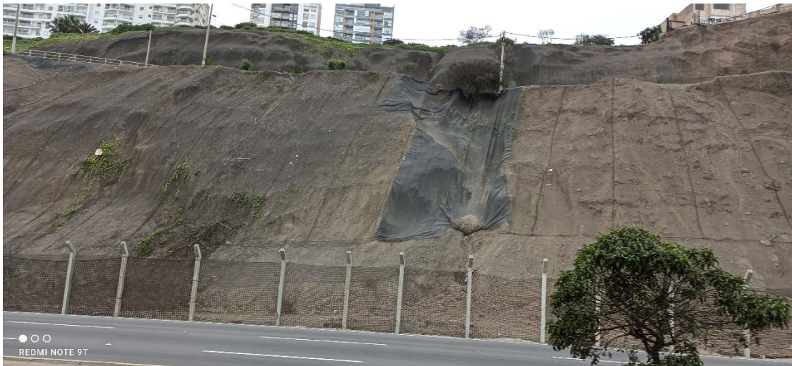
Figura 131. Vista hacia la Bajada Brasil donde se identificaron cárcavas cubiertas por geomalla.
