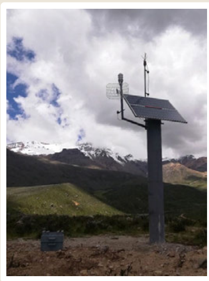
▶ Fig. 3 - Estructura robusta de metal y concreto instalada en la estación Huayraray que conforma la red de monitoreo del volcán Sabancaya.
