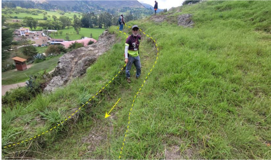
Figura 23. Canal de drenaje de escorrentía, sin revestimiento y con abundante vegetación.
