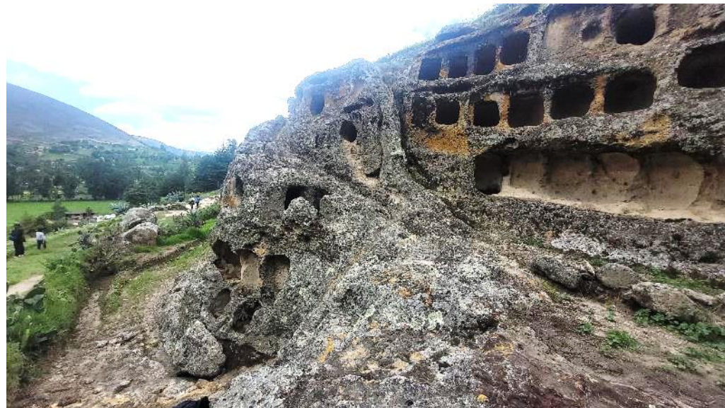
Fotografía 9. Detalle de la zona del Perfil E-E', donde se aprecian nichos funerarios colapsados debido a la meteorización y erosión misma del talud, por procesos pluviales y eólicos.
