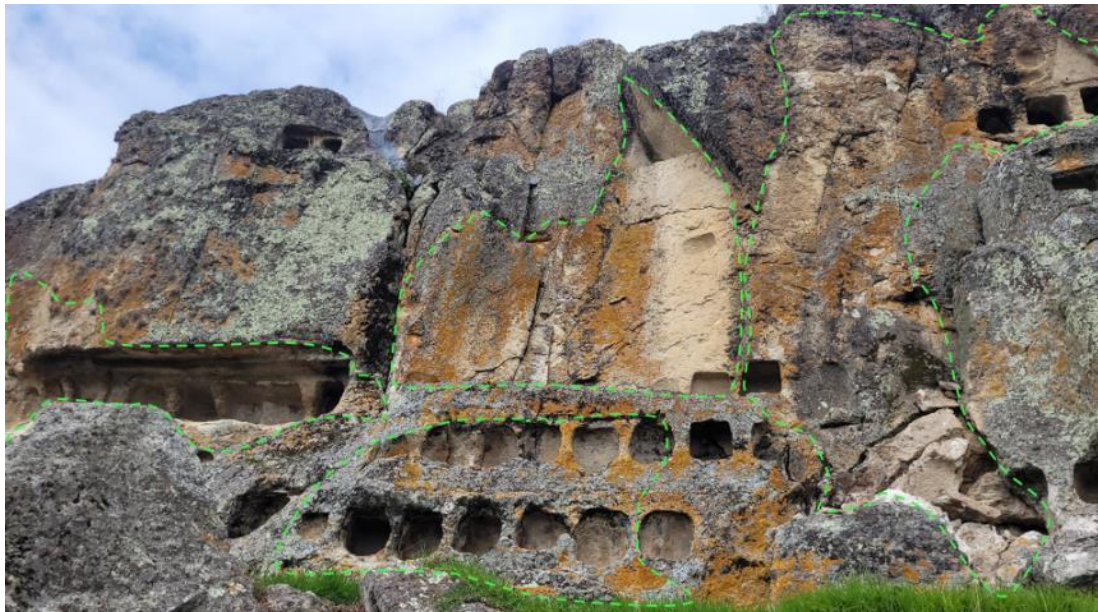
Figura 18. Delimitada con líneas discontinuas de color verde se observa las áreas moderadamente hasta altamente meteorizadas. Se ubica en el lado derecho del frontis de las Ventanillas de Otuzco.
