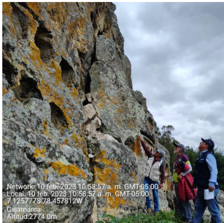
Figura 30. Detalle de la zona del Perfil C-C', donde se observa un bloque rocoso muy inestable debido a que la misma excavación antrópica para la conformación de los nichos funerarios ha debilitado el pie del talud.
