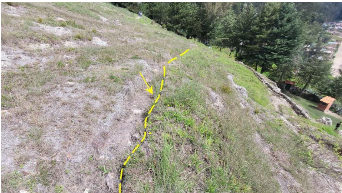
Figura 10. Agrietamientos (líneas amarillas discontinuas), con longitudes de 1m a 5 m, ubicados en la parte superior del macizo rocoso.
