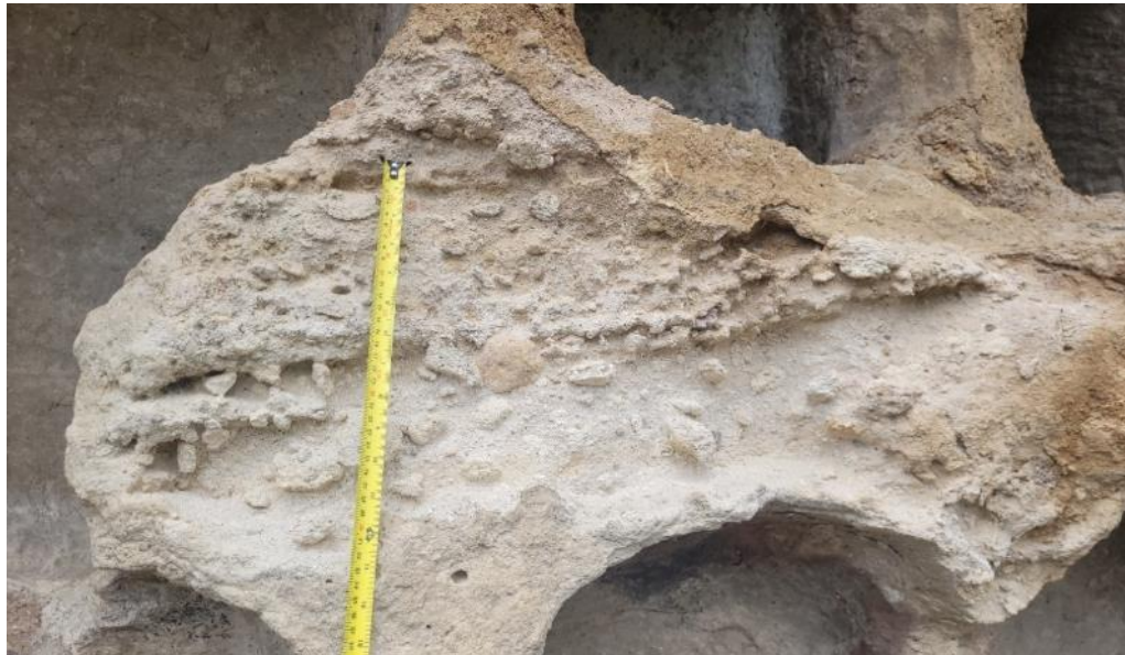
Fotografía 2. Se puede observar el macizo rocoso altamente meteorizado.
