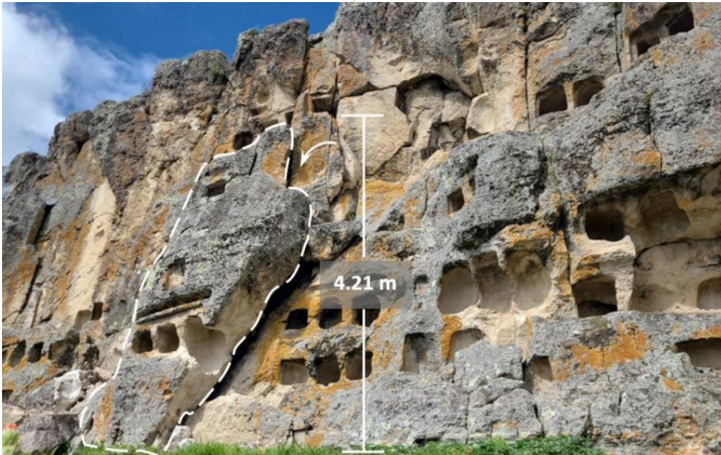
Figura 11. Se observa el bloque que ha colapsado (línea blanca discontinua), parte central del frontis donde se ubican los nichos fúnebres. Coordenadas UTM WGS84, Norte: 9211580 – Este: 780799.
