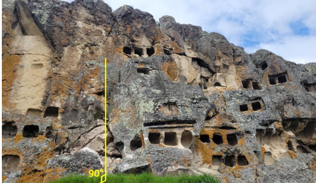
Figura 22. Los nichos funerarios están contruidos sobre un macizo rocoso con una pendiente < 45^\circ , en donde se origina la caída de rocas.
