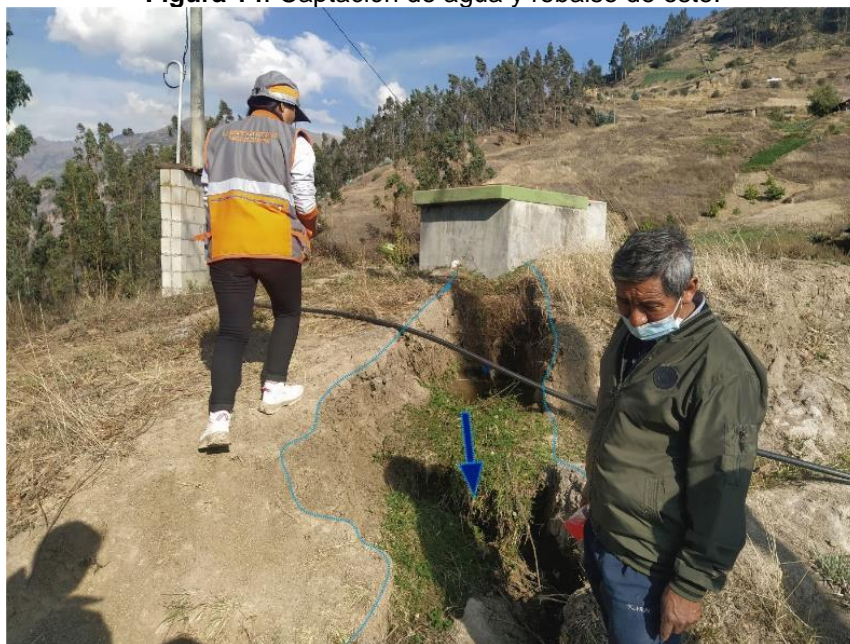
Figura 15. Obsérvese el surco producto de la erosión del agua que habría rebalsado la captación de agua.
