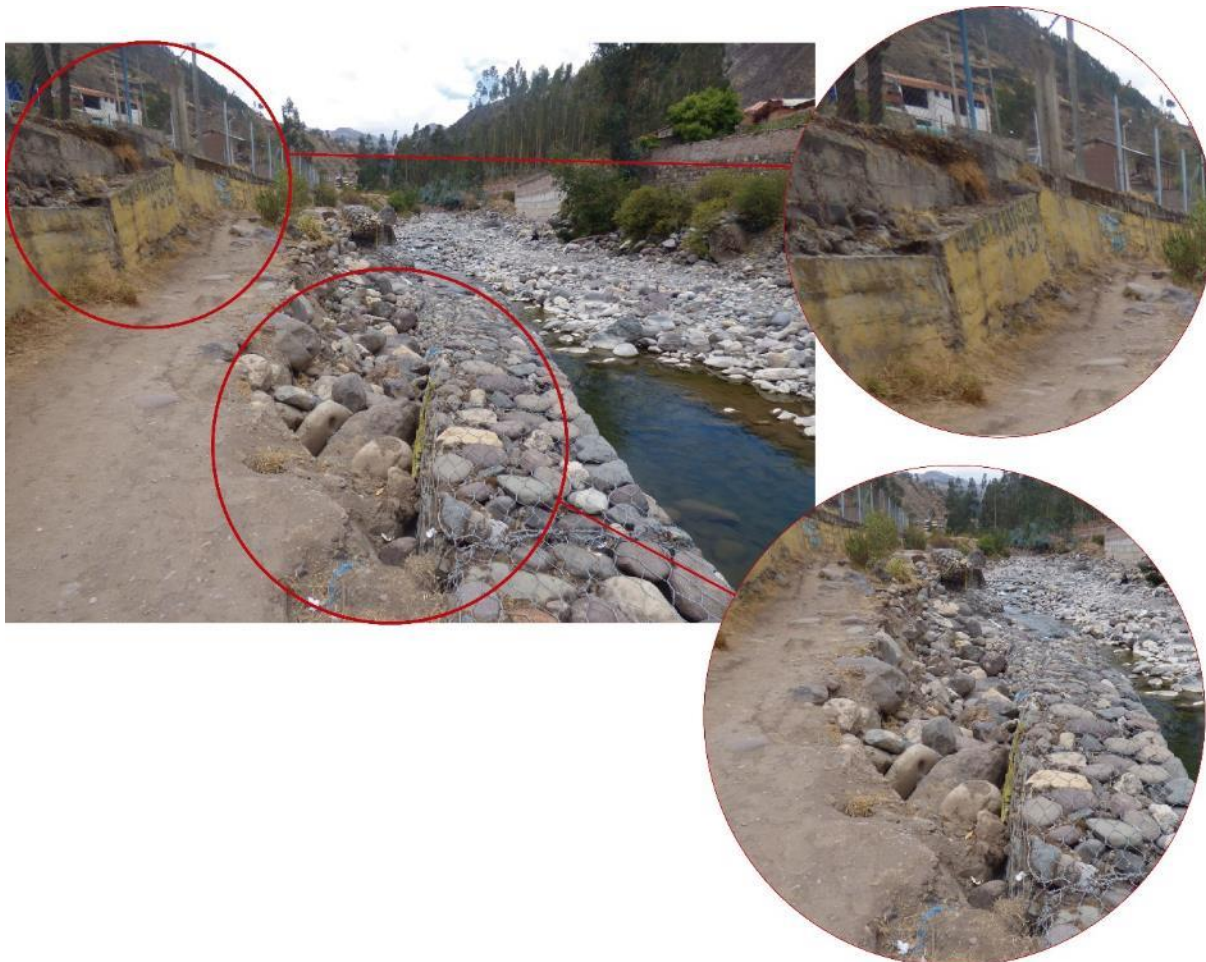
Figura 17. Evidencias del socavamiento del río Sicra en la margen derecha.
