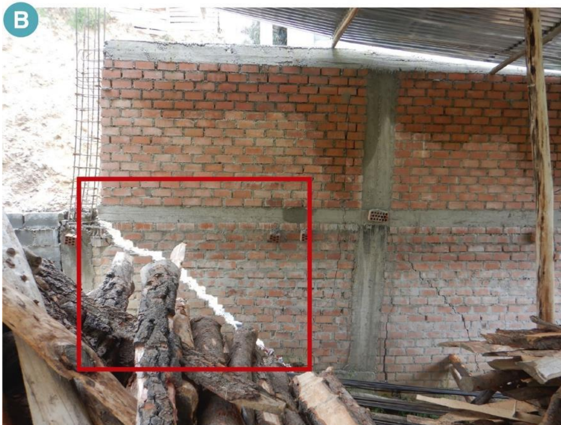
Figura 24. Muestra los daños en la construcción n° 6 por el deslizamiento D4, A y B, muestran los agrietamientos en los muros de división de la propiedad.
