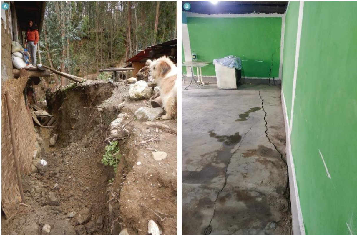
Figura 27. Muestra agrietamientos en la vivienda N°2 afectada por la reptación de suelos, A), muestra zanjas que han abierto los propietarios Para evitar la infiltración de aguas y B) los agrietamientos en la vivienda.
