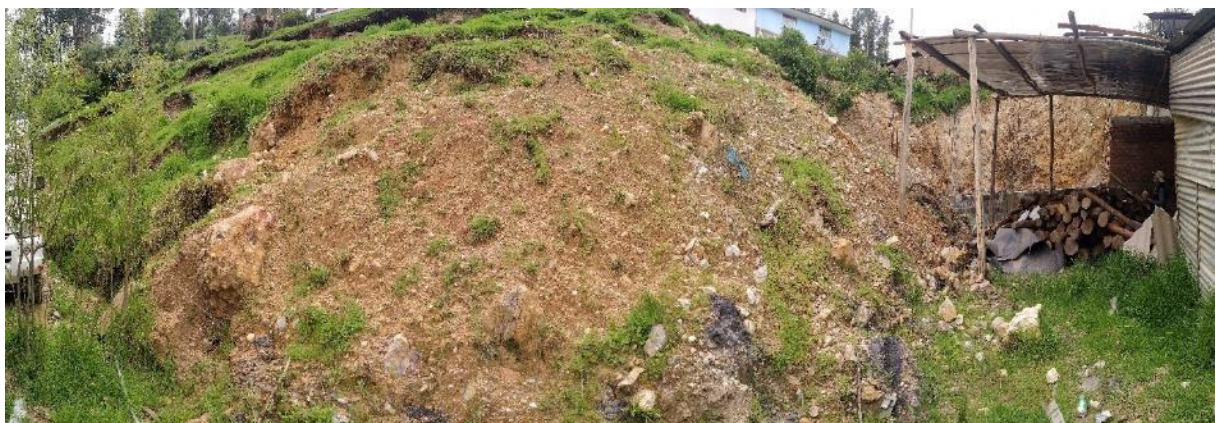
Figura 11. Depósitos coluvio-deluviales ubicados en la coordenada UTM WGS 84, 18s Este: 221628 y Norte: 8951018. Por debajo de las casas con agrietamientos.
