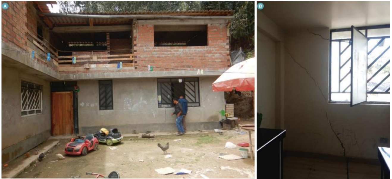
Figura 26. Muestra agrietamientos en la vivienda N°3 afectada por la reptación de suelos, A), muestra la fachada de la vivienda construida en el 2020 y B) muestra agrietamientos y daños en la infraestructura.
