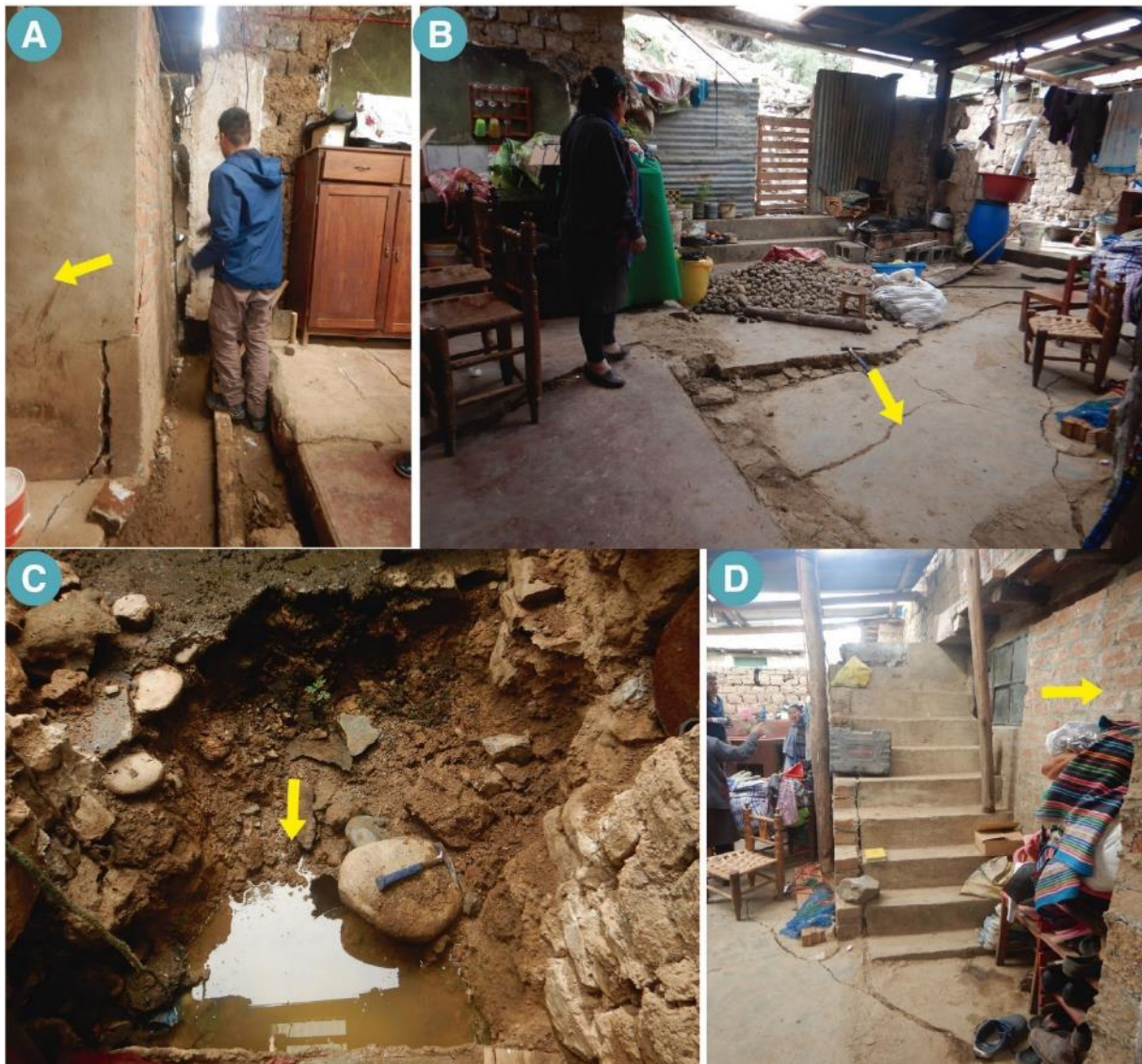
Figura 20. Muestra los daños en la vivienda n° 1 por el deslizamiento D4, las flechas amarillas señalan la dirección del movimiento perpendicular a la pendiente. A y D, muestran aperturas en la base del primer piso lo que hace a la construcción altamente susceptible a colapsar por agrietamientos de hasta
