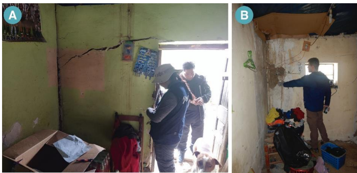
Figura 22. A) y B) Muestra los daños en la vivienda n° 4 por el deslizamiento D4, esta vivienda es utilizada como tienda de abarrotes y muestra daños severos en su infraestructura.
