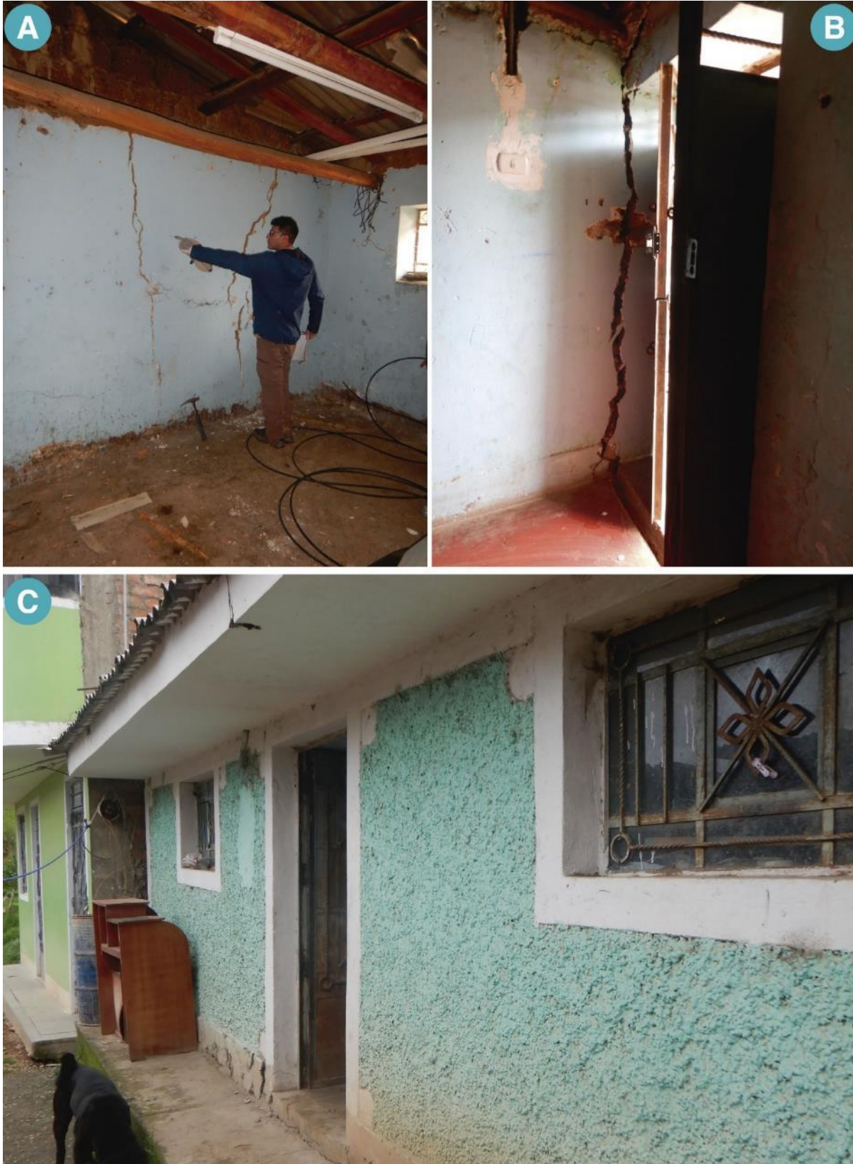
Figura 23. Muestra los daños en la vivienda n° 5 por el deslizamiento D4, A y B, muestran los agrietamientos en la vivienda, mientras que C) muestra la fachada de la vivienda actualmente abandonada.
