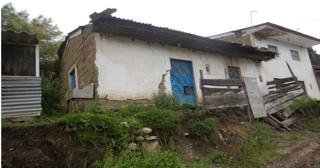
Fotografía 1. Vivienda N°1 con agrietamientos por la reptación de suelos actualmente abandonada.
