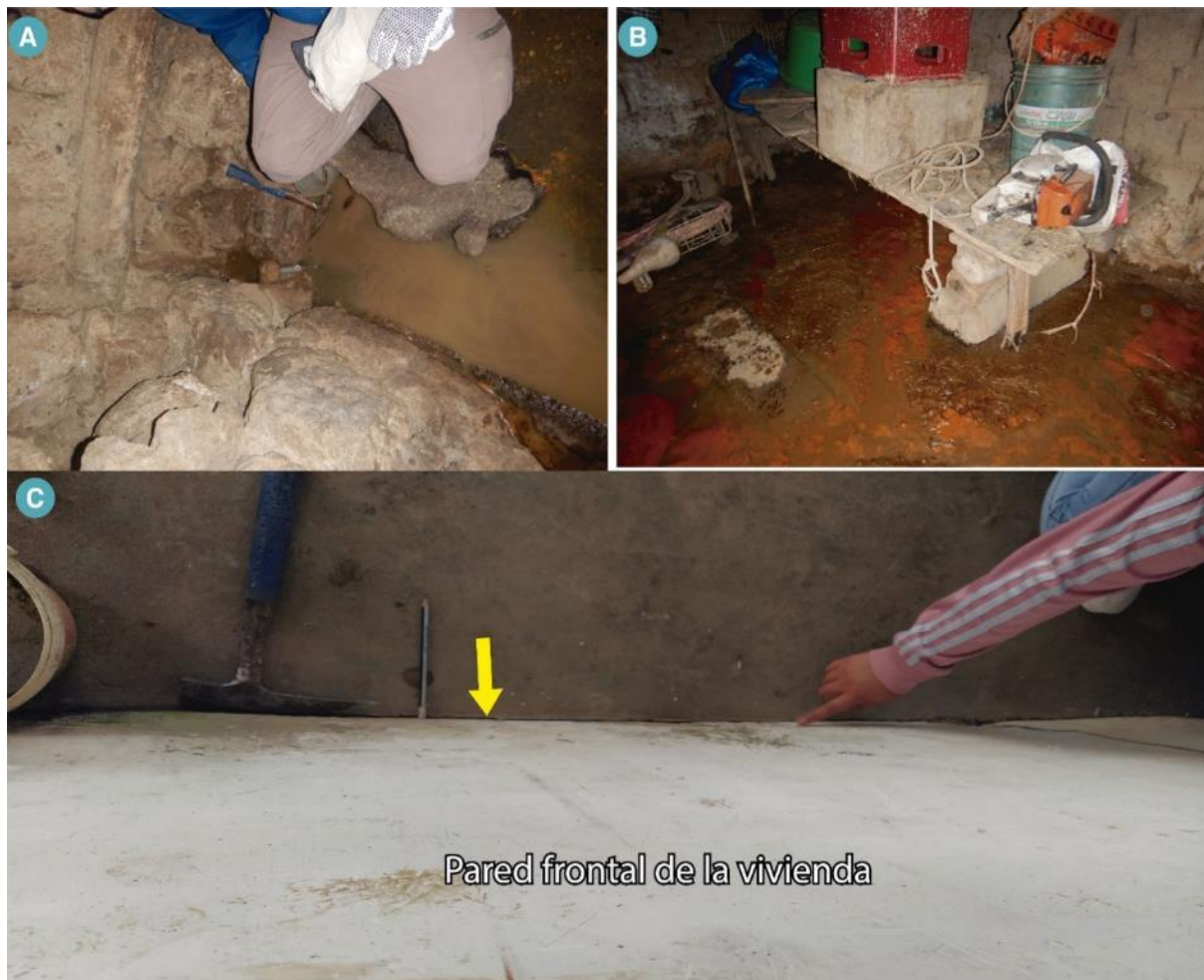
Figura 21. Muestra los daños en la vivienda n° 2 por el deslizamiento D4, las flechas amarillas señalan la dirección del movimiento perpendicular a la pendiente. A) y B) Muestran filtraciones de agua y C) agrietamientos centimétricos de la pared principal de la vivienda.
