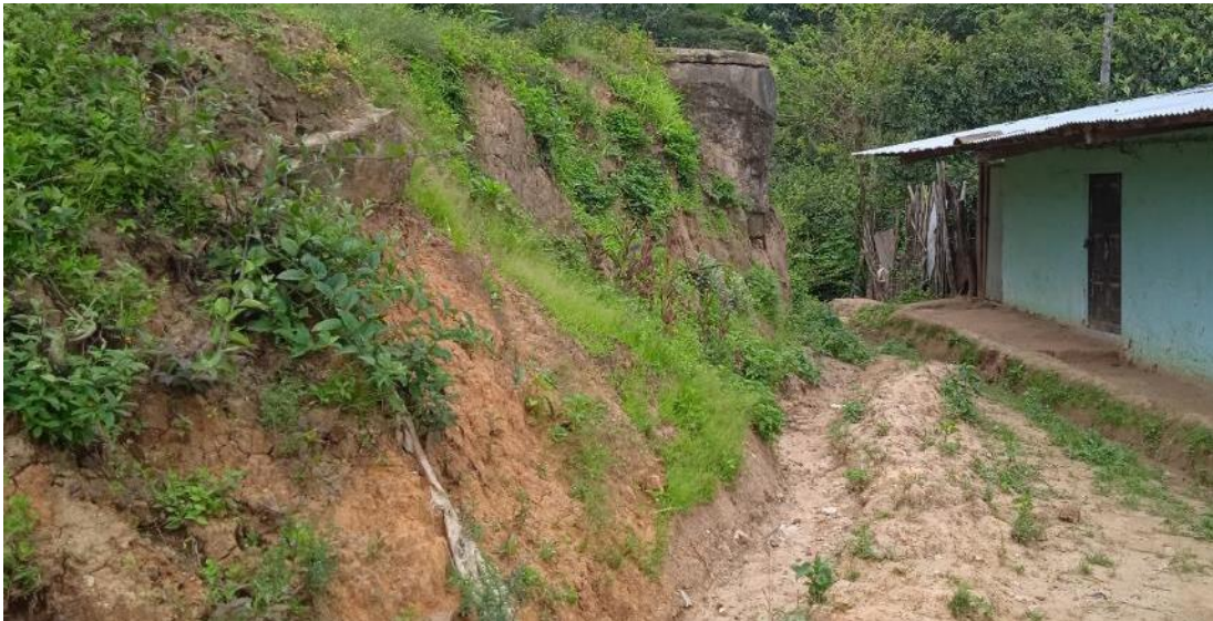
Fotografía 2. Capas limoarenosas susceptibles a erosión en la coordenada 9491919N y 634028E.
