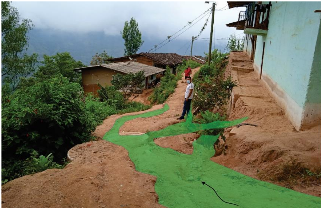
Figura 12. Calle Palmeras, afectada por cárcavas de hasta 20 cm de profundidad, coordenadas 9434991N y 629368E.
