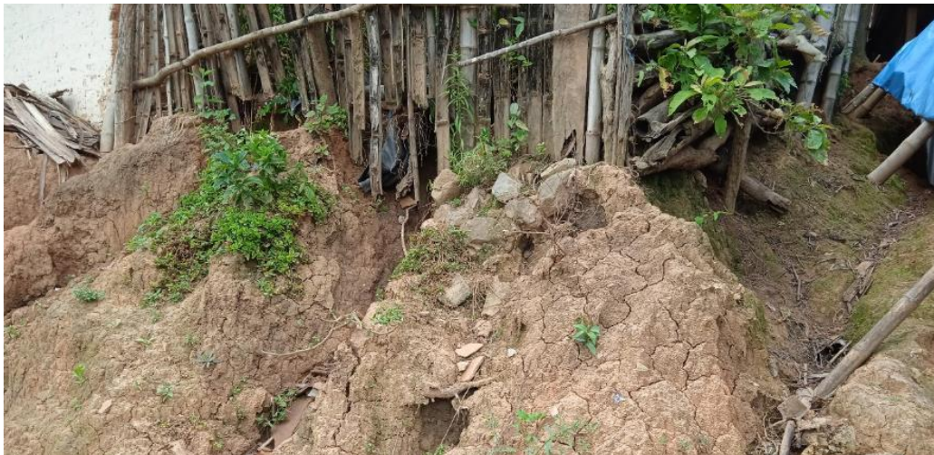
Fotografía 4. Vivienda de adobe y caña, la escorrentía ingresa desde la parte alta de la ladera, coordenadas 9434975N y 629359E.
