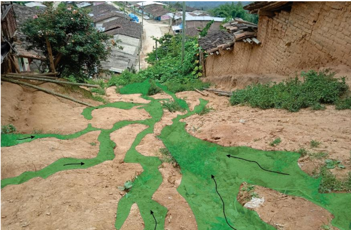
Figura 9. Cárcavas que afectan viviendas ubicadas en la Calle Comercio, vista de norte a sur donde se aprecia una fuerte pendiente hacia el centro de la ciudad. (Coordenadas: 9434950N y 629341E).
