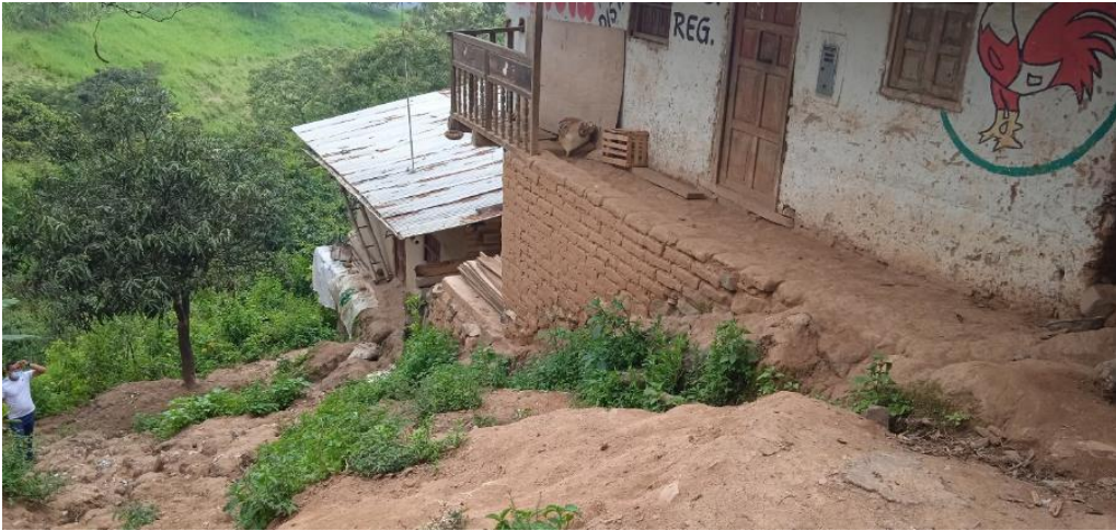
Fotografía 3. Vivienda afectada por cárcavas de 30 cm de profundidad, coordenadas 9434922N y 629382E.
