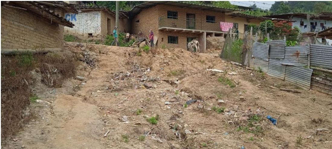
Fotografía 5. Calle Tupac Amaru, procesos de erosión que afectan todo el ancho de la calle, coordenadas 9434689N y 629490E.
