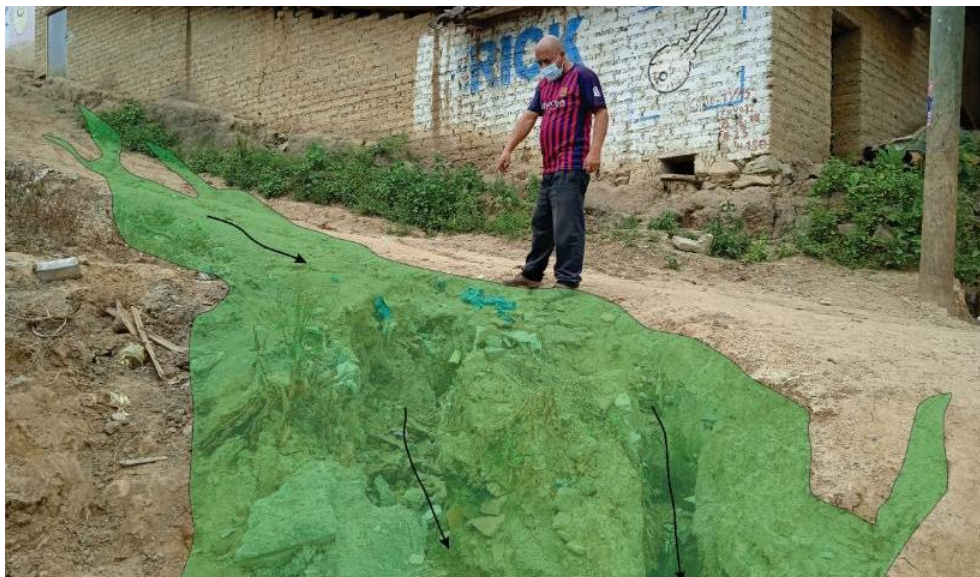
Figura 16. Cárcavas de hasta 50 cm de profundidad, coordenadas 9434774N y 629474E).
