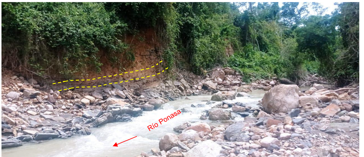
Figura 8. Areniscas amarillentas muy fracturadas y moderadamente meteorizadas.
