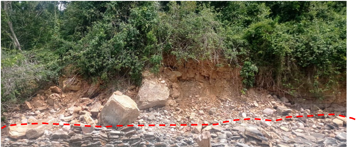
Figura 18. Vista frontal del pie del deslizamiento y contacto con estratos de arenisca altamente fracturados.
