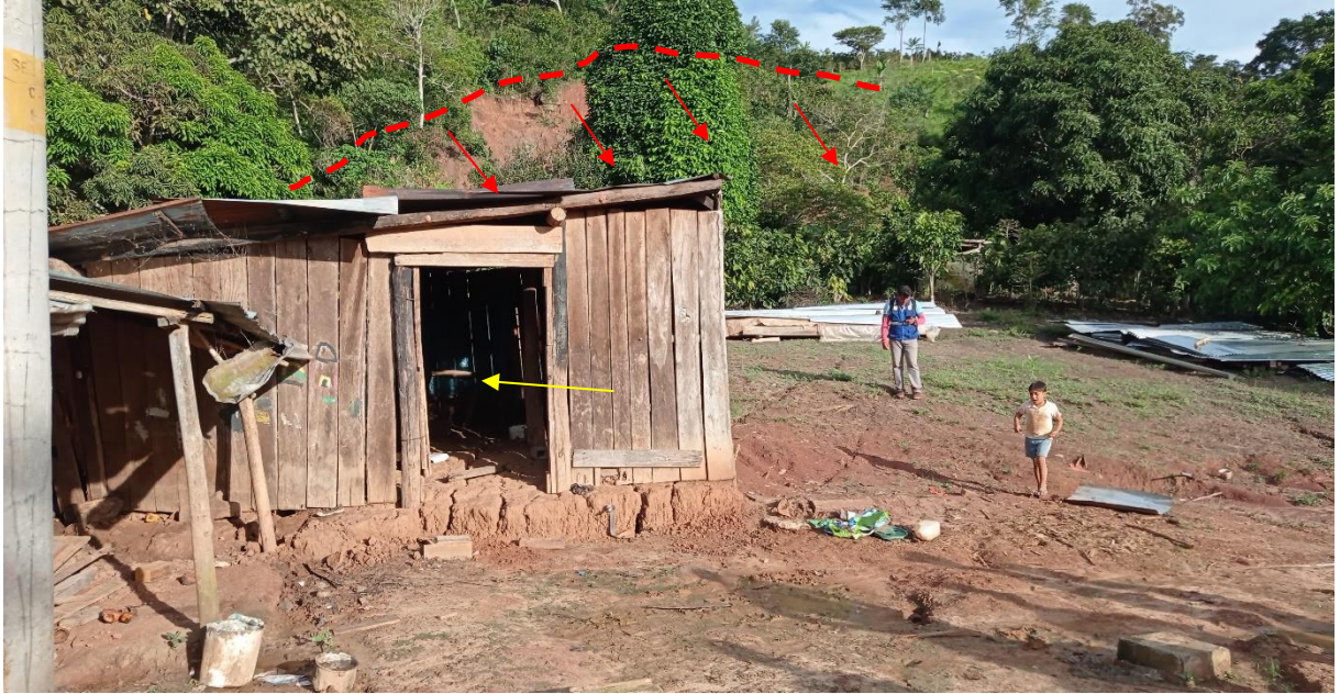
Figura 13. Vivienda afectada por el deslizamiento N°02.
