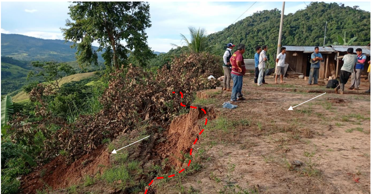
Figura 14. Masa inestable en movimiento lento ladera abajo, deslizamiento N°02 (figura 13).
