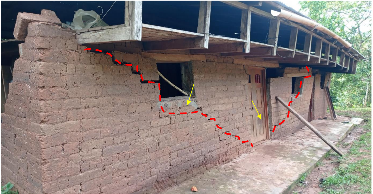
Figura 10. Vivienda afectada, ubicada en la parte central de la masa deslizada, deslizamiento N°01. Esta vivienda es inhabitable.
