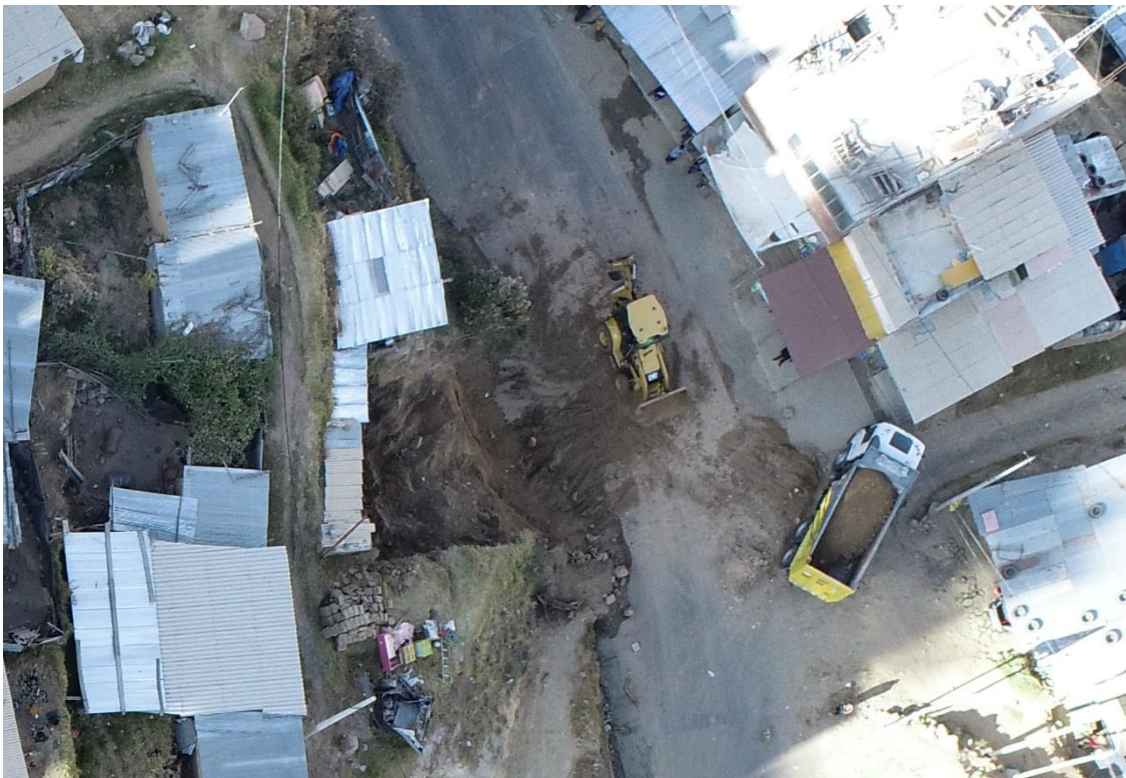
Fotografía 5: Cortes de talud con maquinaria (agosto 2022), hacia la margen izquierda del deslizamiento, para la construcción de nuevas viviendas. Estas condiciones inestabilizan la ladera.
