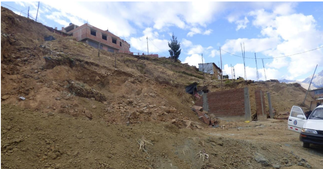
Fotografía 3: Pared de vivienda destruida, la cual se ubicaba al pie del deslizamiento reactivado.
