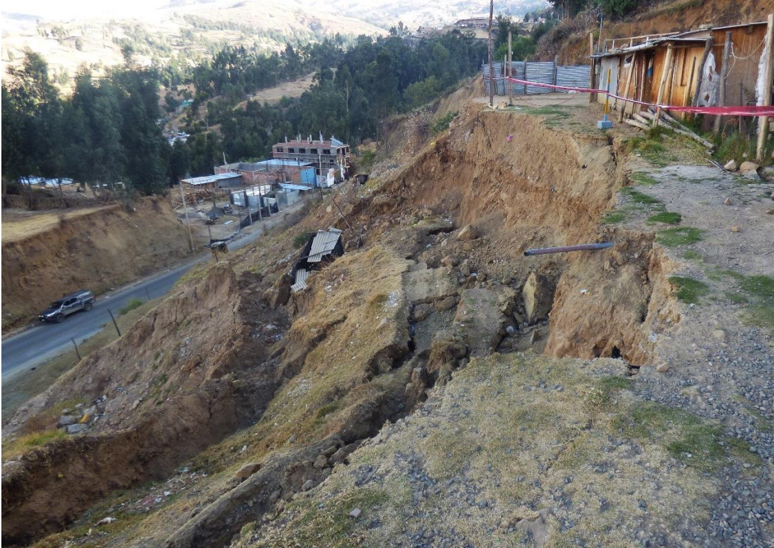
Fotografía 4: Vista del escarpe principal, de forma irregular y continua con una longitud de 45m y saltos verticales que varían de 1 a 2.5 m, así mismo se muestra la superficie del terreno bastante agrietada.
