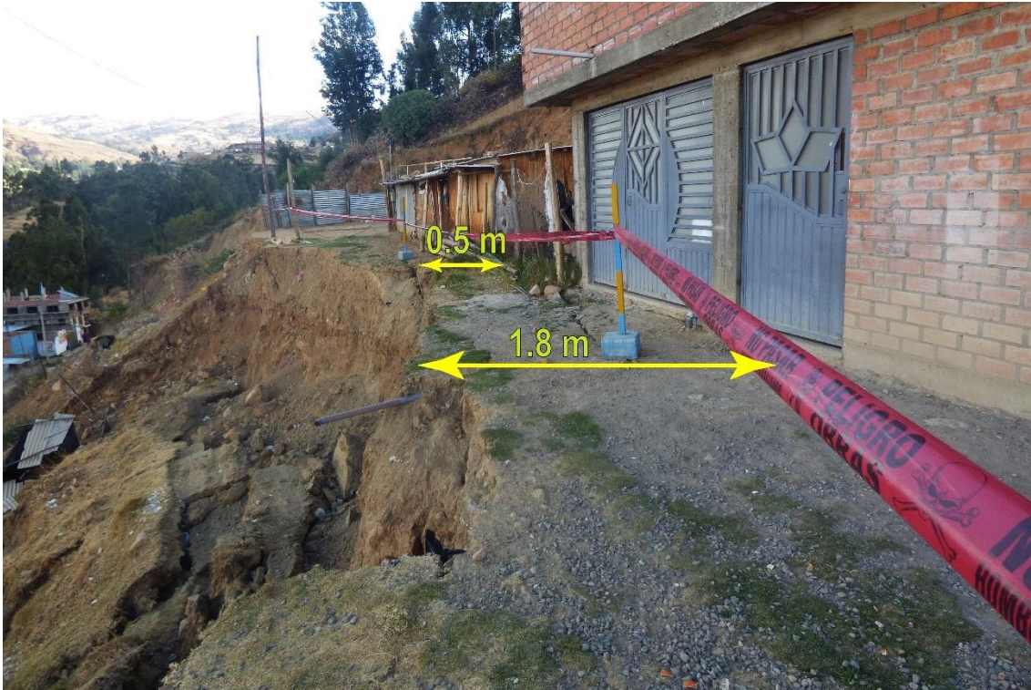
Figura 6: Viviendas ubicadas al borde de la escarpa principal del deslizamiento, las cuales se encuentran entre 0.5 a 1.8 m
