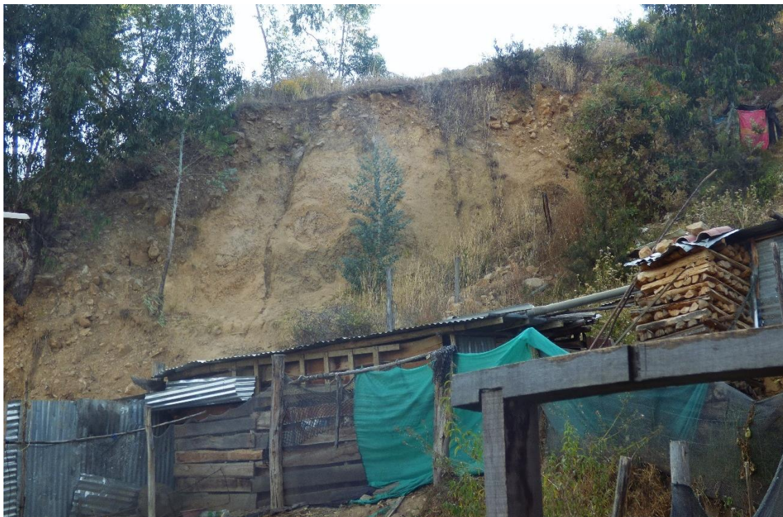
Fotografía 1: Vista del depósito coluvio-deluvial poco consolidado, compuestos por fragmentos de roca angulosos a subangulosos de tamaños variables (0.05 a 0.20 m), envueltos en una matriz limo-arcilloso.
